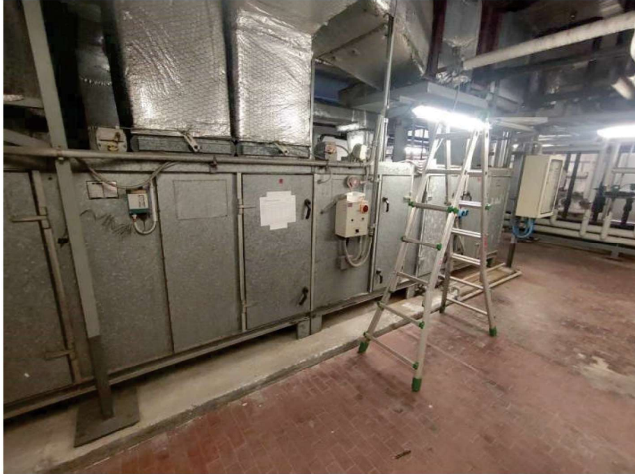
Unità di trattamento aria a servizio dei locali ubicati al piano 13
