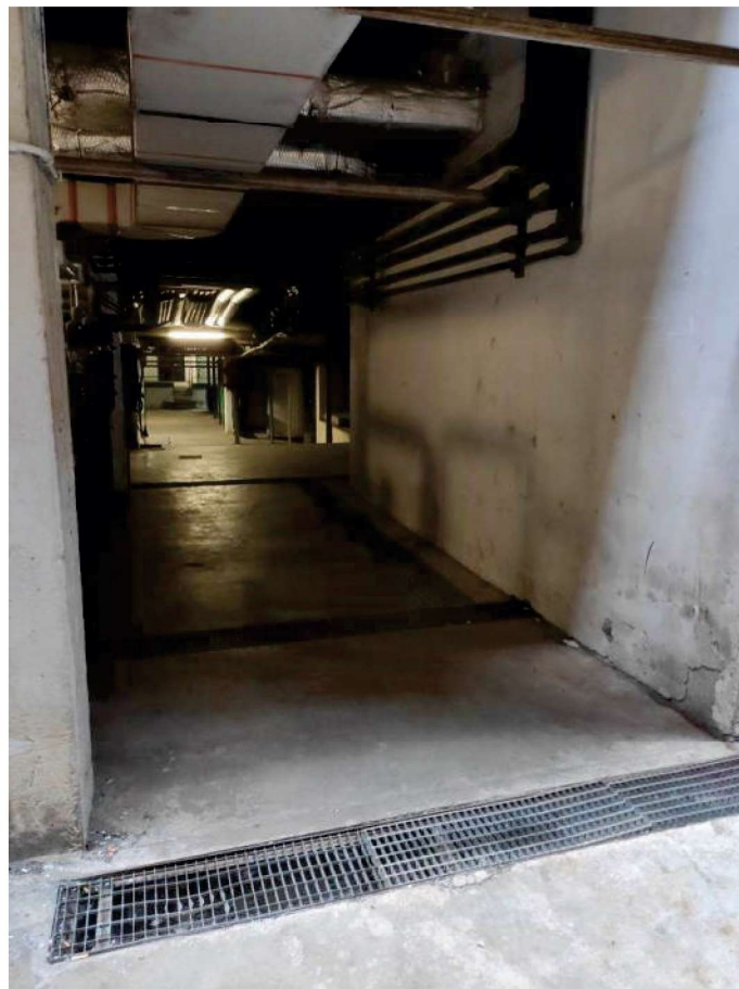
Accesso pedonale al piano -4 per installazione Unità di trattamento aria a servizio della sala regia
