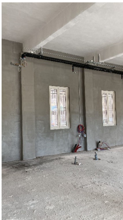
Figura 1: La parte impiantistica del servizio non realizzato all'interno dell'unità 6
