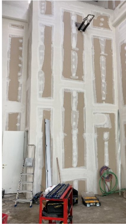
Figura 3: il nuovo blocco servizi nell'unità 24. In evidenza il cartongesso fino al soffitto del padiglione
