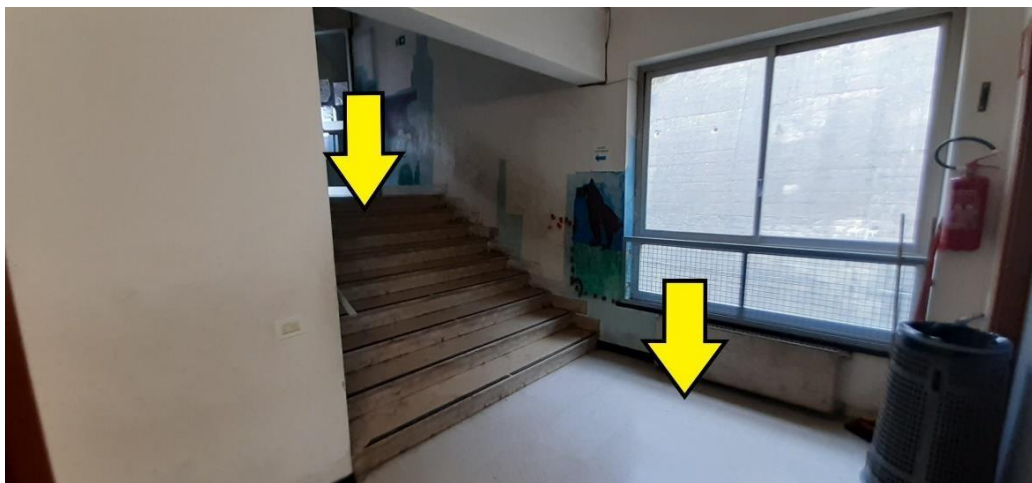
Foto 2 Lato (dx) su cui va installato il servoscala
