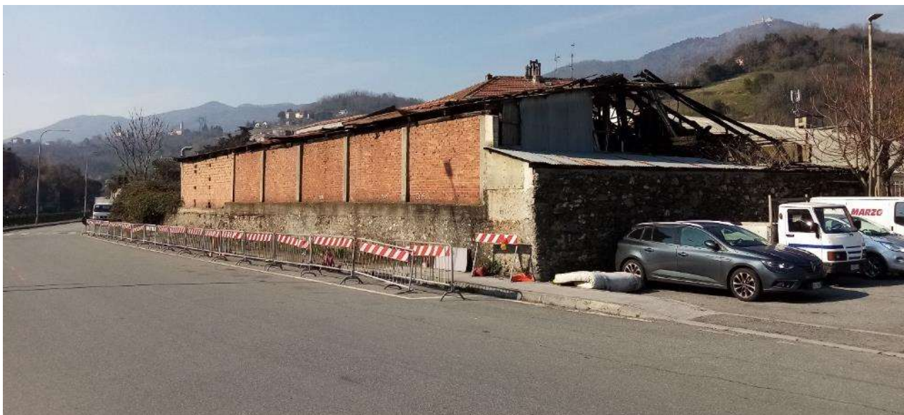
Figura 10 - Vista dell'ex Falegnameria da via delle Fonderie Grondona (prima della messa in sicurezza da parte della Direzione Facility Management)
