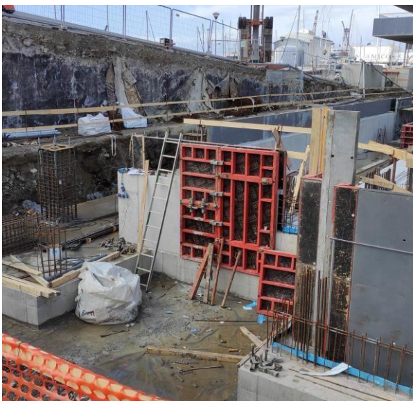
Figure 5 - Area di realizzazione pozzo ponente bypass impianti. Si evidenzia la pesante interferenza tra le strutture lotto 2.3 eseguite e il pozzo byass ancora da eseguire. In tale spazio la macchina per pali secanti non può operare.
