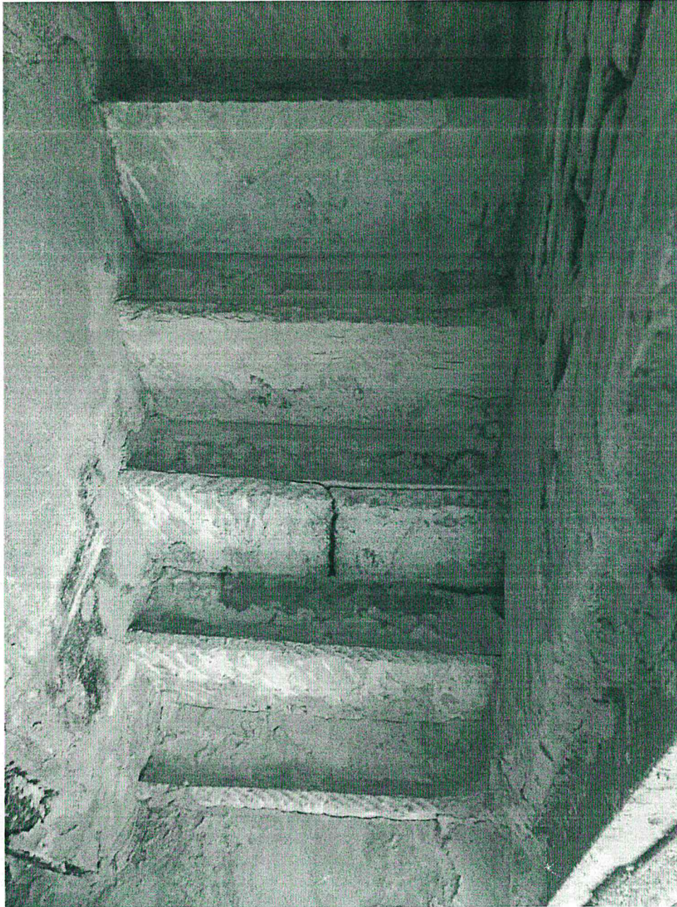
Intradosso scala di accesso a piano primo - pedata lesionata
