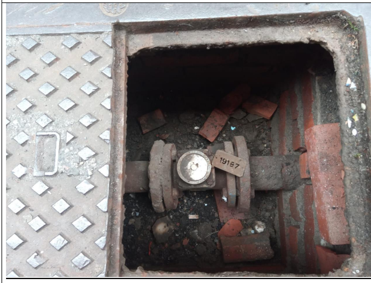
Figura N°2: bocchetta antincendio n. 19187
