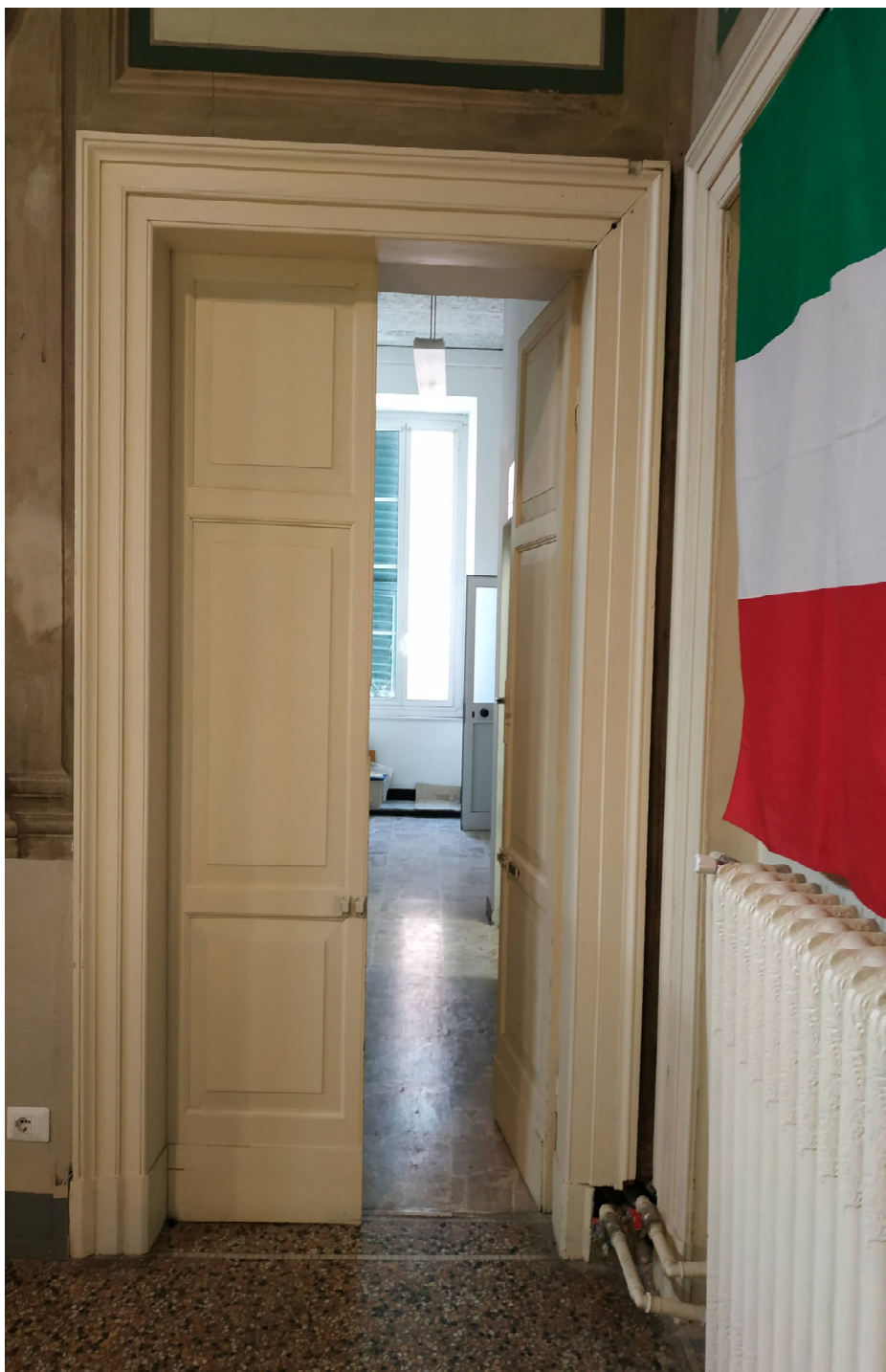
Foto n. 17- Porta tra il salone e il corridoio che deve essere girata di verso di apertura
