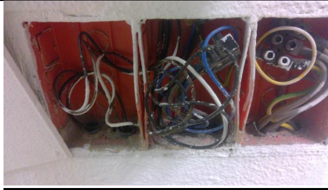
Figura N°8: impianto elettrico atrio piano terra – museo della montagna
