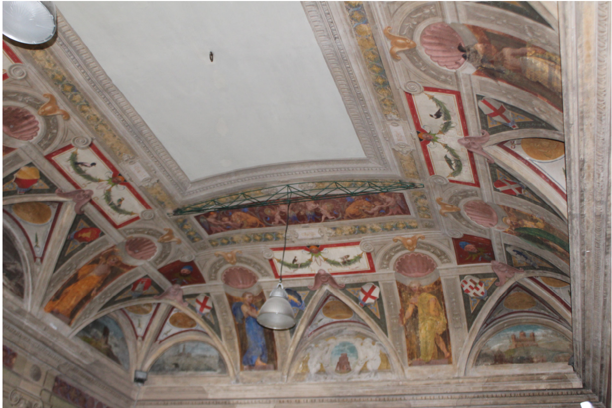
Foto n. 16- Soffitto salone al primo piano
