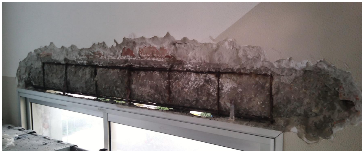
Foto 12 Vista interna vano scala dettaglio tipo ad evidenziate tipo e gravità degrado strutture
