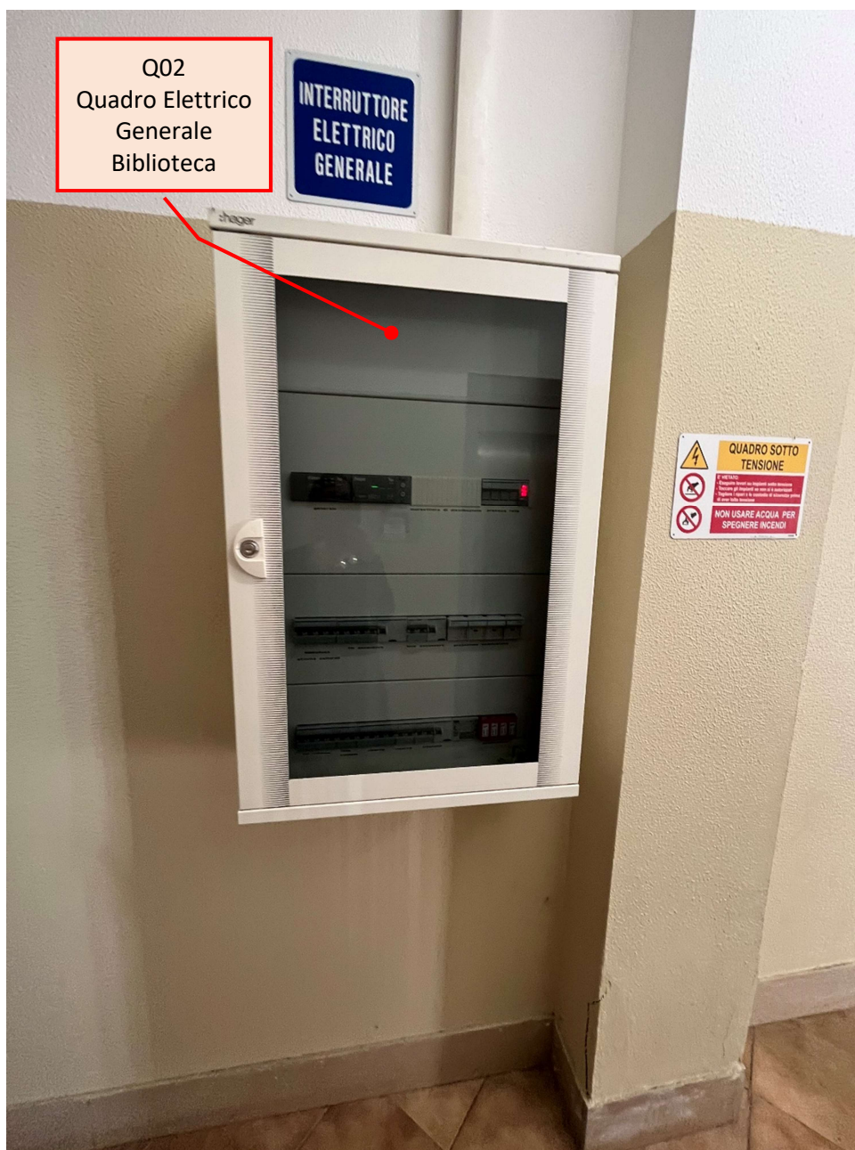
Figura 7 – QUADRO ELETTRICO GENERALE Q02 (di smistamento impianti biblioteca, ascensore, scale e centrale termica) posto al piano terreno di fronte allo sbarco ascensore
