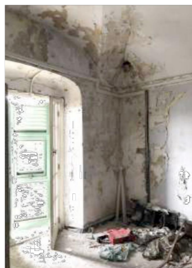
INFILTRAZIONI DI UMIDITA' - DEGRADO INTONACI ESFOLIAZIONE PITTURE - VOLTA LESIONATA
