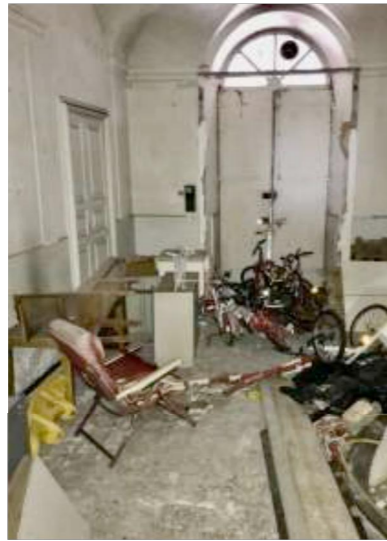
MATERIALI PAVIMENTAZIONE INADEGUATI RIVESTIMENTO PIASTRELLE - UMIDITA'
