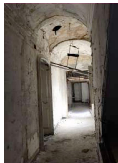
INFILTRAZIONI DI UMIDITA' - DEGRADO INTONACI ESFOLIAZIONE PITTURE - VOLTA LESIONATA
