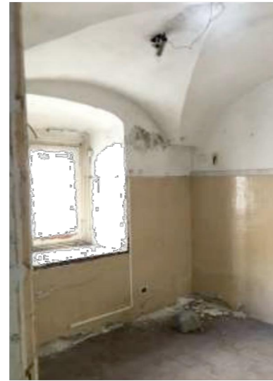
UMIDITA' DI RISALITA EFFLORESCENZE DI SALNITRO
