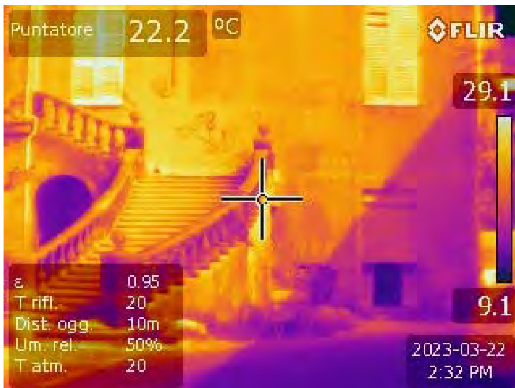
Foto IR_2551 – Il termogramma non evidenzia particolari disomogeneità del paramento murario. Si notano le riprese di intonaco già visibili ad occhio nudo.
