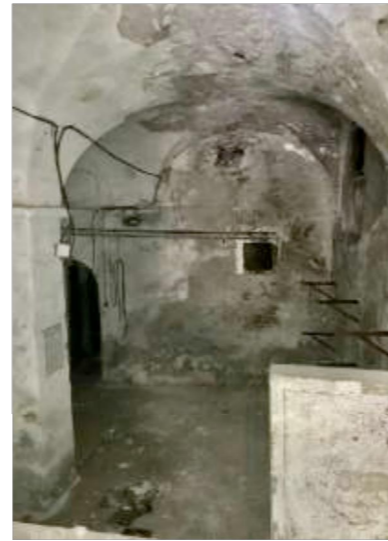
INFILTRAZIONI DI UMIDITA' - DEGRADO PAVIMENTI PARETI E VOLTE
