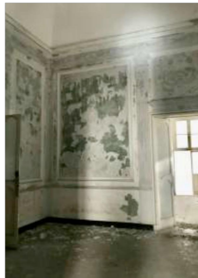
INFILTRAZIONE UMIDITA' ESFOLIAZIONE DI PITTURA
