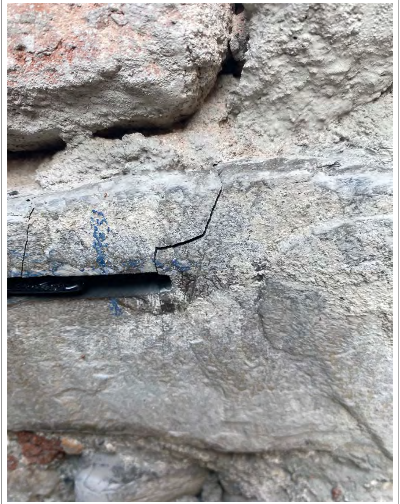
M1 – Rilevamento delle lesioni sui giunti di malta e sugli elementi in pietrame e mattoni, al termine della prova
