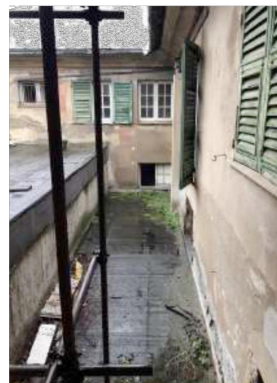
DISTACCO TRA VOLUME PRINCIPALE E SALONE CON RISTAGNO DI ACQUA PIOVANA
