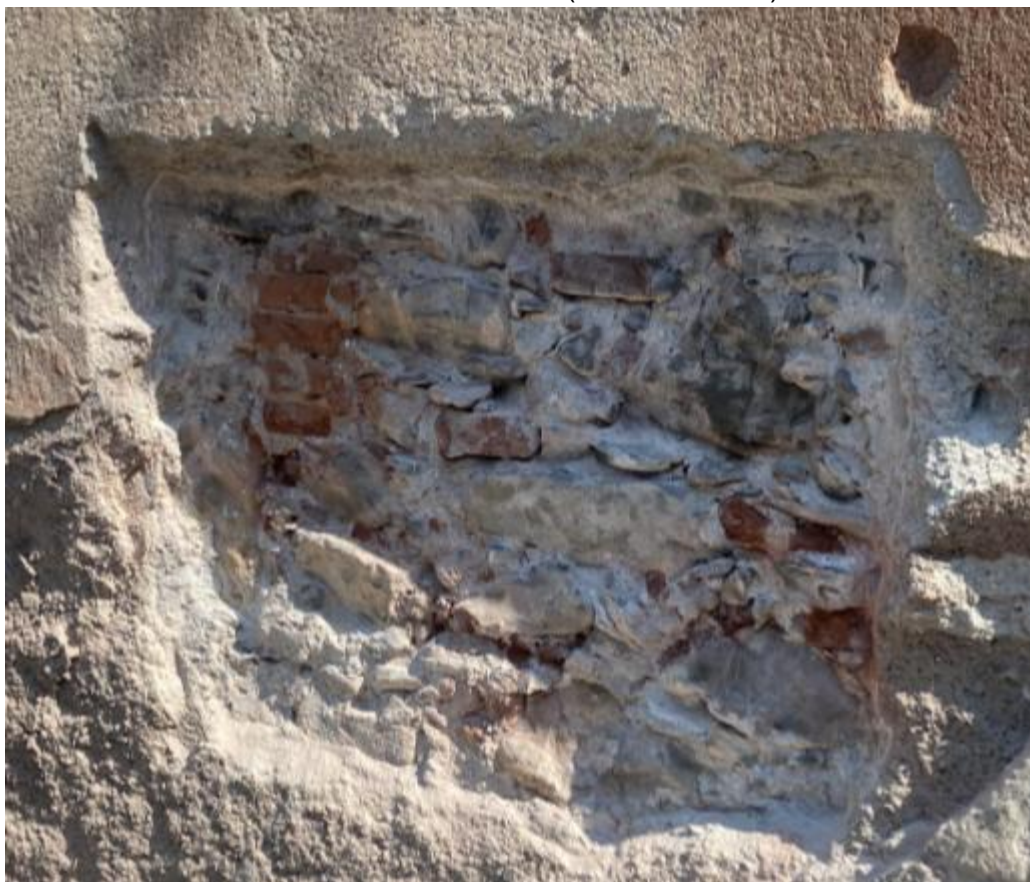
Scopertura di intonaco in corrispondenza delle murature perimetrali
