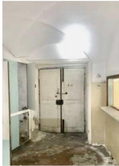
UMIDITA' DI RISALITA EFFLORESCENZE DI SALNITRO
