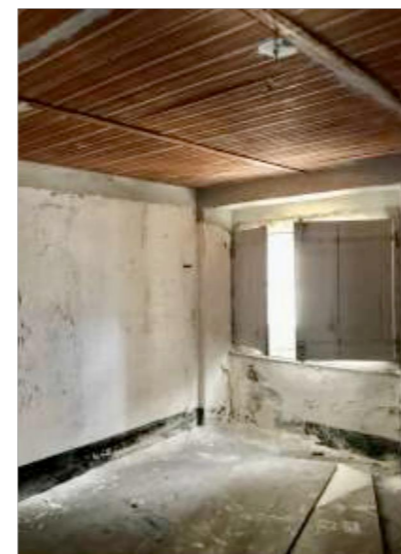
INFILTRAZIONE UMIDITA' - DEGRADO INTONACO CROLLO SOFFITTO E NUOVO SOLAIO
