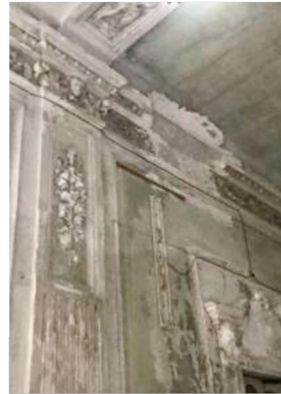
INFILTRAZIONE UMIDITA' - DEGRADO INTONACI E DECORI, CROLLO DI PORZIONE DI CORNICE
