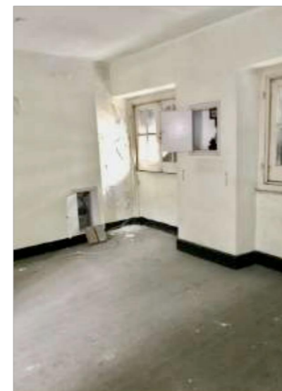
INFILTRAZIONE UMIDITA' ESFOLIAZIONE PITTURE
