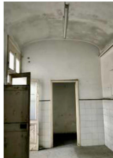
INFILTRAZIONE UMIDITA' UMIDITA' DI RISALITA
