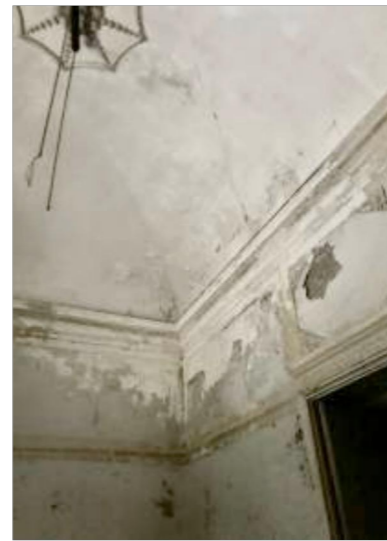
INFILTRAZIONE UMIDITA' - DISTACCO INTONACI ESFOLIAZIONE DI PITTURA - VOLTA LESIONATA
