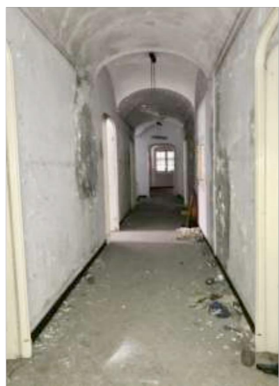
INFILTRAZIONI DI UMIDITA' - DEGRADO INTONACI ESFOLIAZIONE PITTURE
