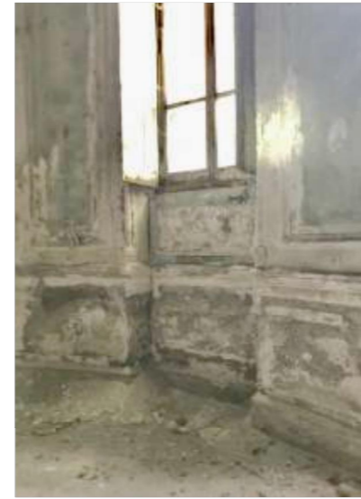
INFILTRAZIONE UMIDITA' - DEGRADO INTONACI E DECORI A STUCCO
