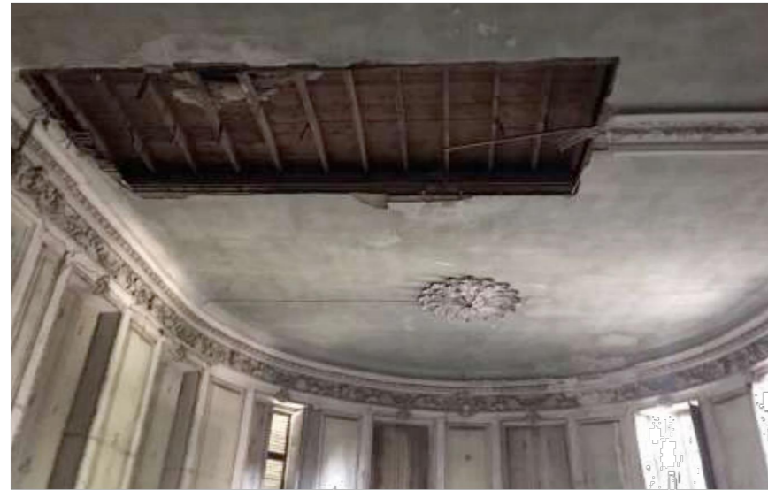
SALONE PRINCIPALE CON INFILTRAZIONE UMIDITA' DA PAVIMENTO, PARETI E TETTO CROLLO PORZIONE DI CONTROSOFFITTO IN CANNICCIO
