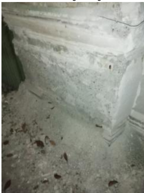
Degrado degli stucchi alla base delle murature esistenti
