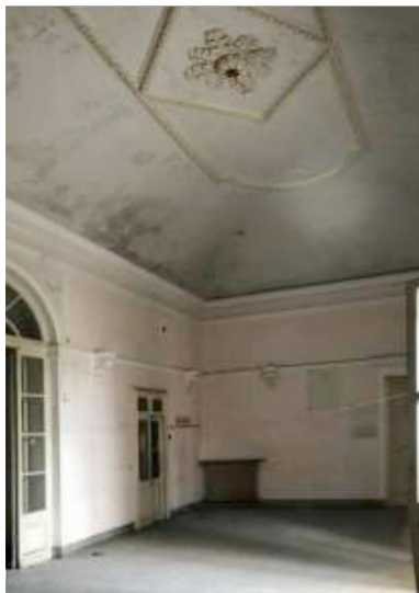
INFILTRAZIONE UMIDITA' DA PIANO SUPERIORE ESFOLIAZIONE DI PITTURA
