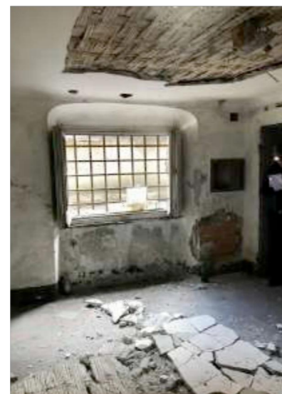
INFILTRAZIONE UMIDITA' - DEGRADO INTONACO DISTACCO INTONACO DA SOFFITTO
