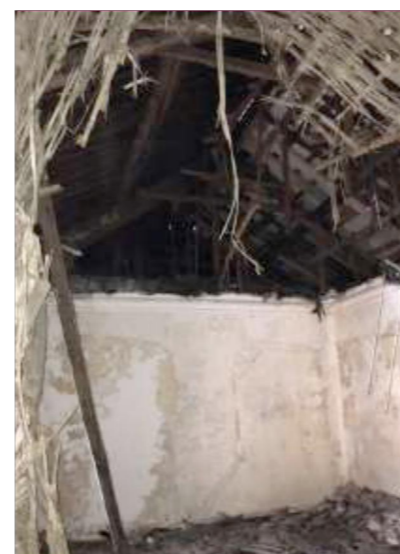
INFILTRAZIONI DI UMIDITA' - DEGRADO INTONACI VOLTA IN CANNICCIO CROLLATA
