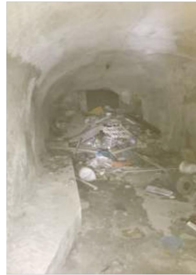
INFILTRAZIONI DI UMIDITA'
