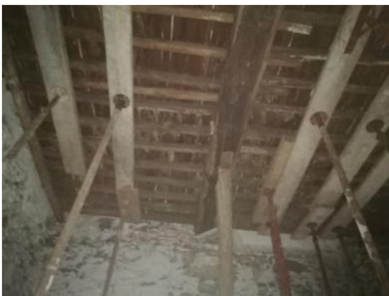
Collasso della volta al piano sottostante con messa a nudo del soprastante solaio in legno e tavolato, poi puntellato
