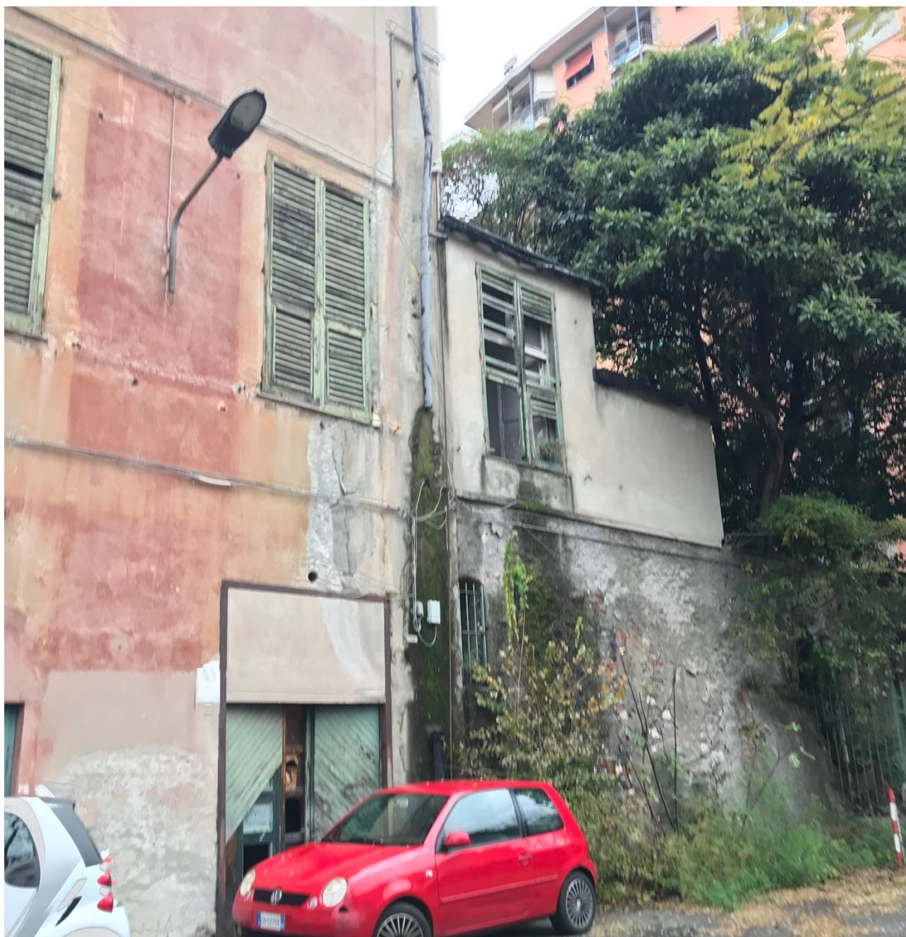
Fig. 17 Il volume incongruo al primo piano, da demolire per far posto alla scala di sicurezza esterna.
