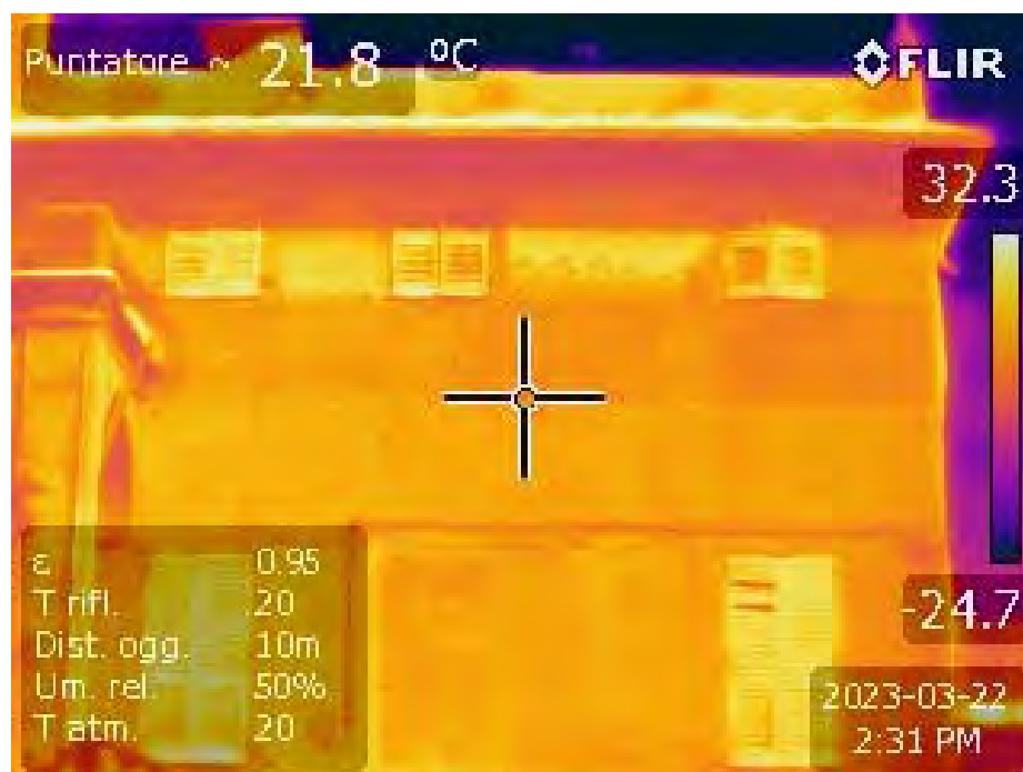
Foto IR_2547 – Il termogramma non evidenzia particolari disomogeneità del paramento murario. Si notano le riprese di intonaco già visibili ad occhio nudo.
