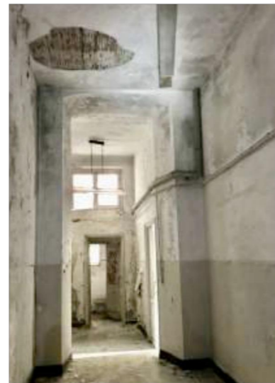
INFILTRAZIONE UMIDITA' UMIDITA' DI RISALITA E SOFFITTO CROLLATO
