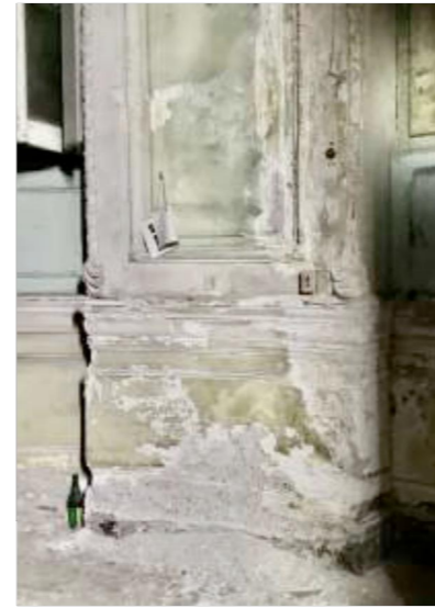
INFILTRAZIONE UMIDITA' - DEGRADO INTONACI E DECORI A STUCCO
