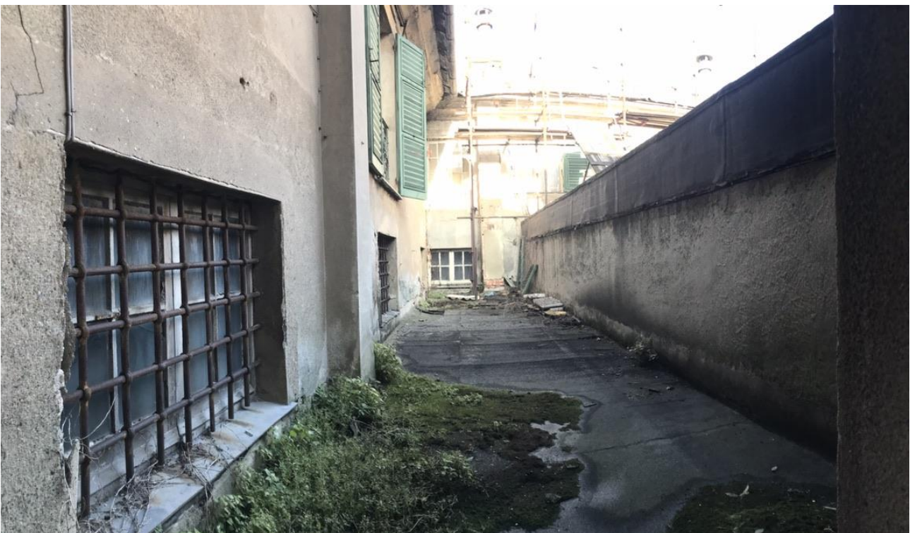
Fig. 15 La 'vasca' a cielo aperto chiusa tra il volume originale della villa ed il salone maggiore settecentesco..
