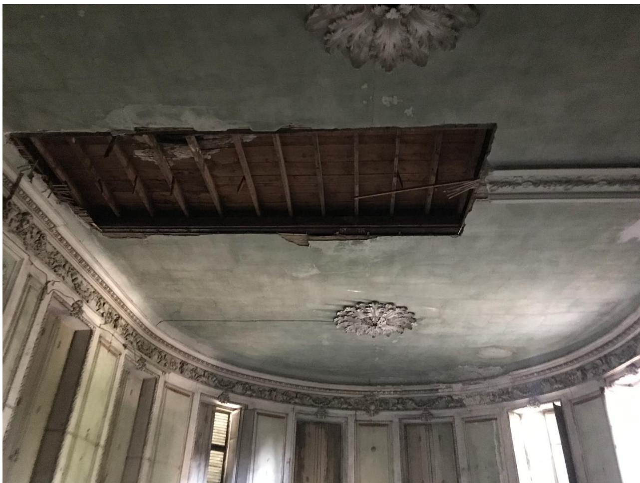
Fig. 13 Il degrado del salone maggiore con il crollo di una porzione di soffitto in canniccio
