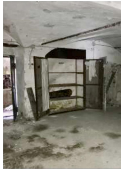
UMIDITA' DI RISALITA - DEGRADO INTONACI E PAVIMENTI CON EFFLORESCENZE DI SALNITRO
