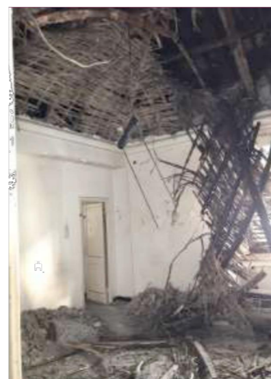
INFILTRAZIONI DI UMIDITA' - DEGRADO INTONACI VOLTA IN CANNICCIO PARZIALMENTE CROLLATA
