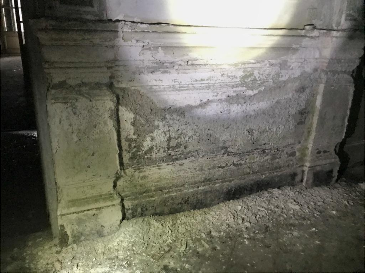
Fig. 14 Lo scrostamento dell'intonaco ed il degrado dei decori nel salone maggiore
