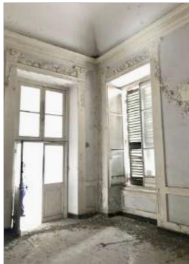
INFILTRAZIONE UMIDITA' - DEGRADO INTONACI ESFOLIAZIONE DI PITTURA
