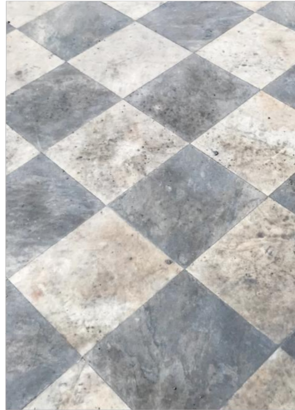
PAVIMENTI IN MARMO CARRARA E BARDIGLIO LASTRE DA CM 35X35 - 40X40
