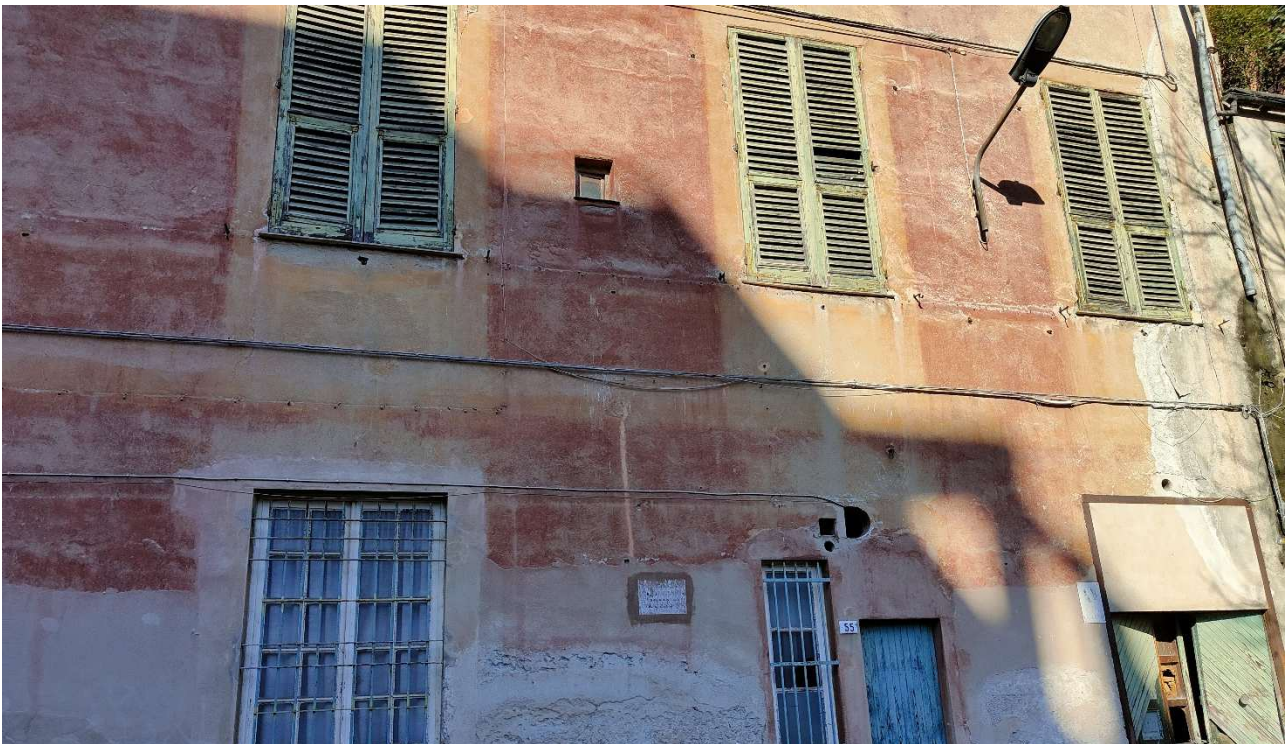
Figura 1.4 – Impianti con cavi a vista
