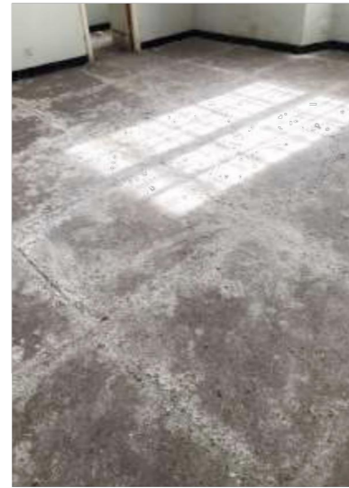
UMIDITA' DI RISALITA EFFLORESCENZA DI SALNITRO
