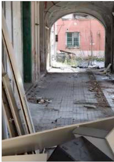
MATERIALI PAVIMENTAZIONE INADEGUATI DEGRADO DA UMIDITA' DI RISALITA
