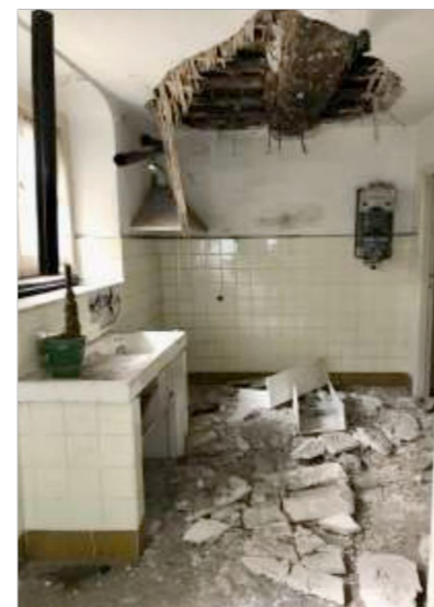
INFILTRAZIONE UMIDITA' - DEGRADO INTONACO CROLLO PARZIALE DI CONTROSOFFITTO
