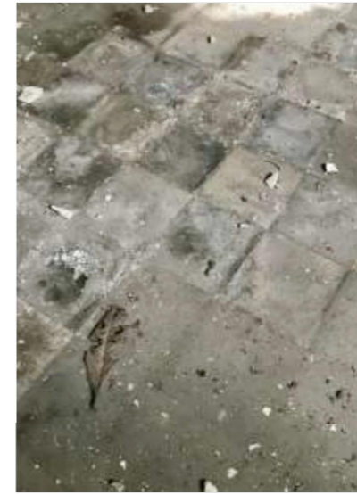
UMIDITA' DI RISALITA - PAVIMENTO SCONNESSO ED EFFLORESCENZE DI SALNITRO
