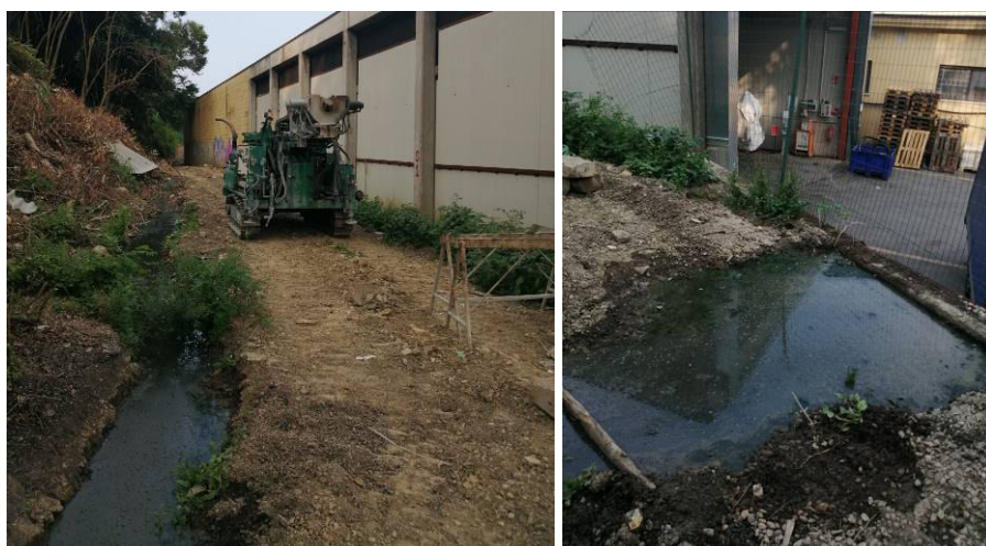
Foto 11 - Foto 12: a sx durante l'ultima campagna geognostica è stato "bonificato" il settore basale della scarpata per realizzare l'accesso alle attrezzature atte all'indagine, confinando i liquami ruscellanti in canale/solco provvisorio. A dx resta tuttavia lo scarico finale a cielo aperto presso gli adiacenti spazi commerciali dell'area ex Macelli
