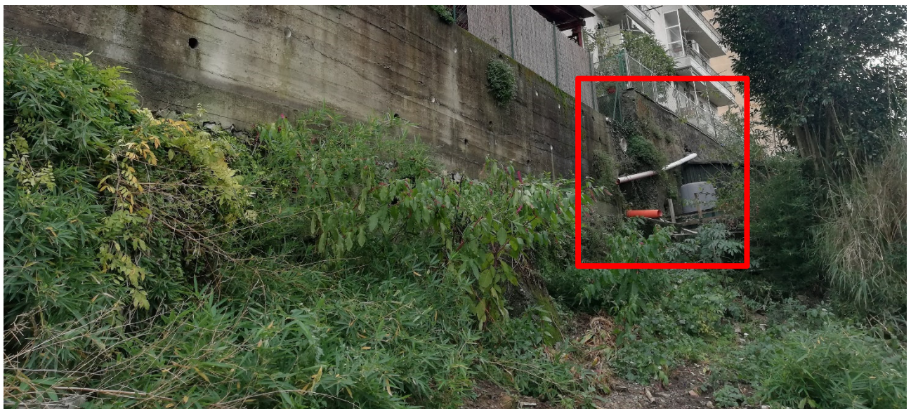
Figura 8: scarichi a cielo aperto
