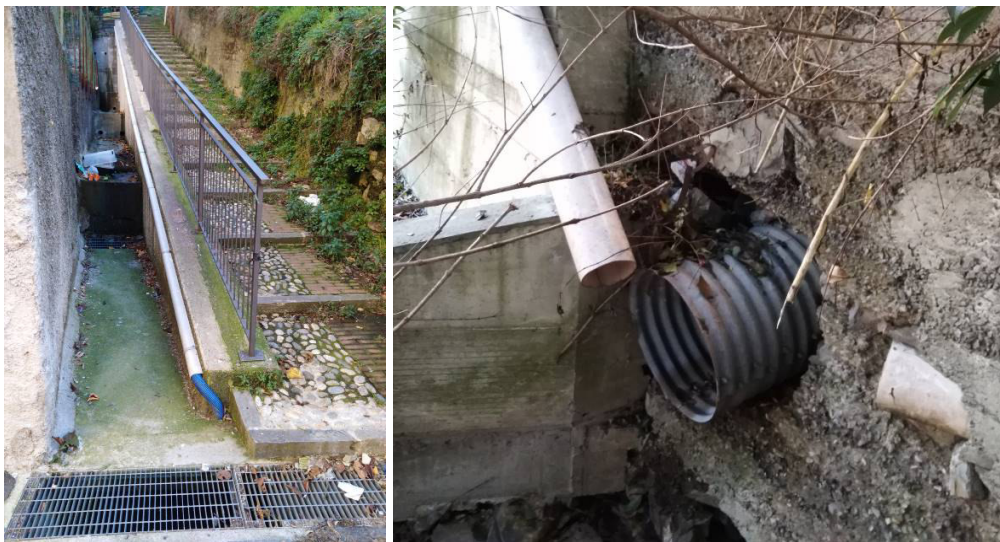
Foto 3 - Foto 4: a sinistra rio Fameiano, incanalato in adiacenza all'omonima "mattonata", a monte di Via Terpi; a destra l'uscita della tombinatura in corrispondenza del Civ. 18a, presso la sommità della scarpata oltre a tubazioni secondarie derivanti dai pluviali e drenaggi a tergo delle opere di sostegno.
