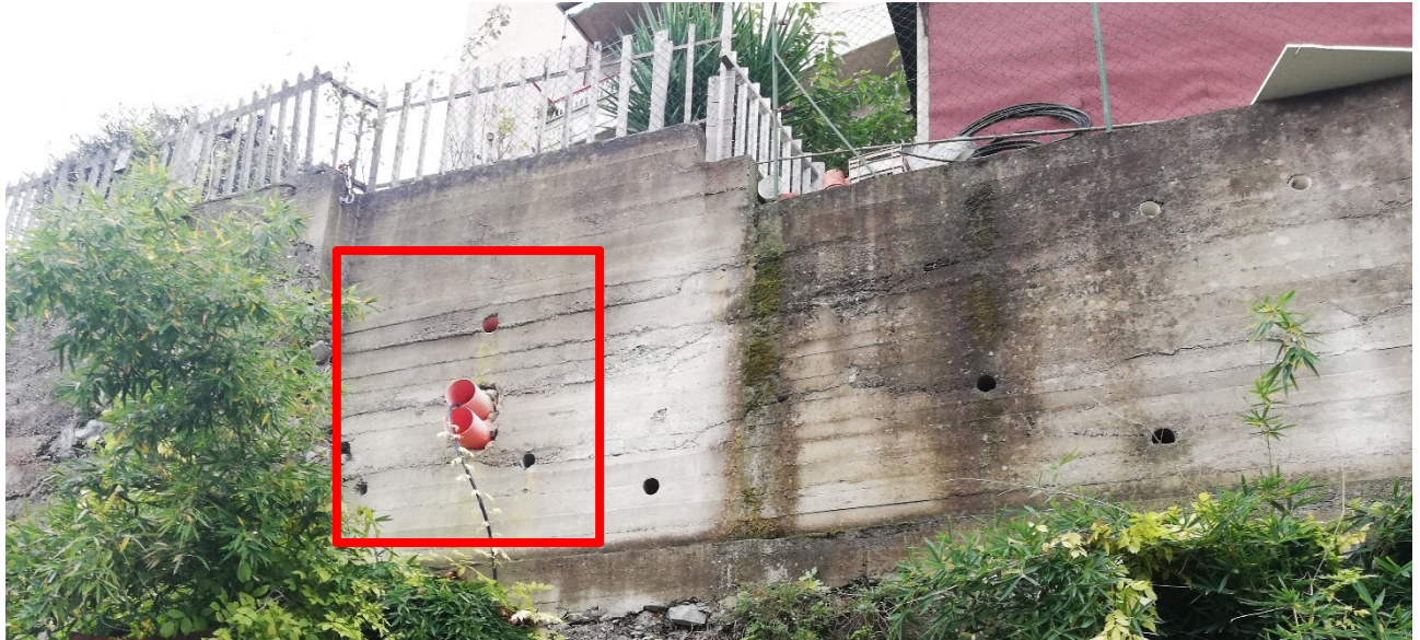
Figura 9: scarichi da via Terpi
