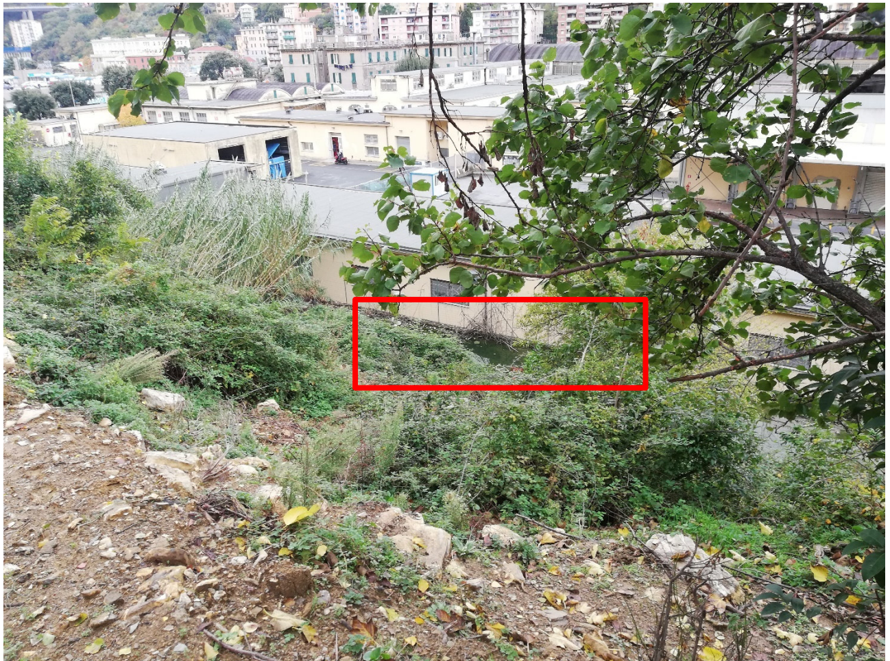
Figura 10: Ristagni d'acqua in scarpata
