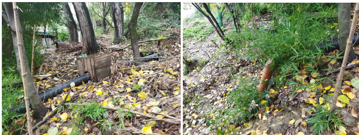
Foto 7 - Foto 8: Linee fognarie "improvvisate" lungo la scarpata
