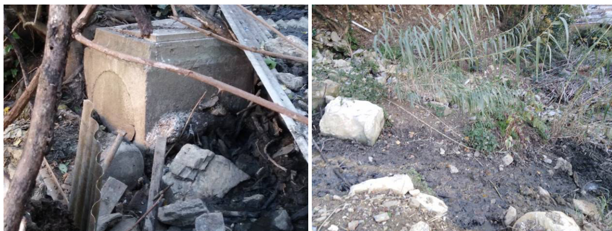
Foto 9 - Foto 10: a sx pozzetti otturati o "esplosi"; a dx il conseguente sversamento di liquami in scarpata.
