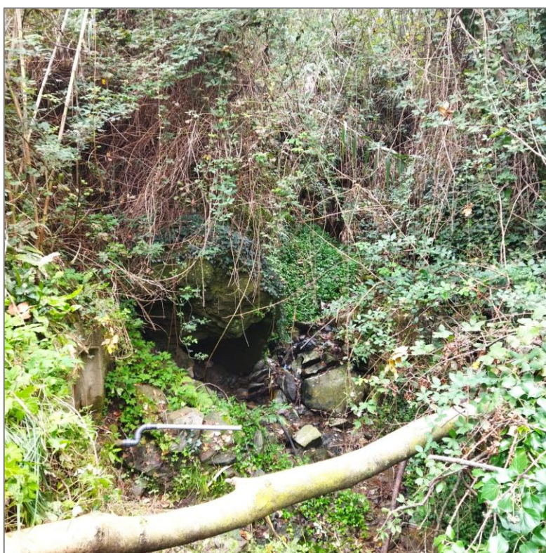
Figura 16_ Puntuale situazione di sottoescavazione nell'alveo del Rio senza nome.
