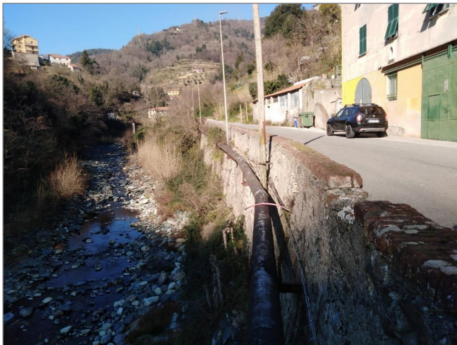
Figura 19_ In evidenza la tubazione di gas staffata al muro.
