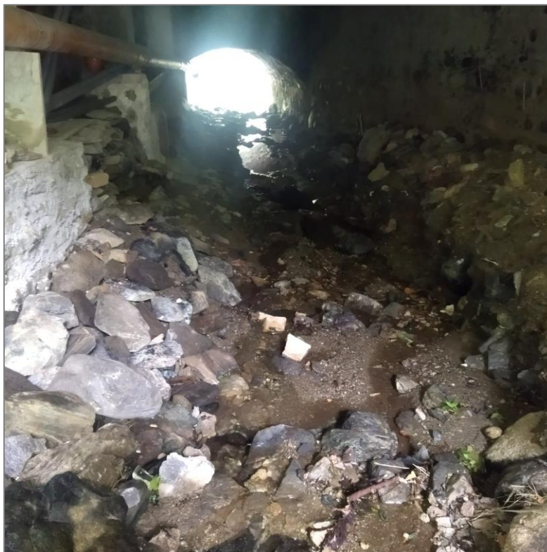
Figura 15_ Situazione del tratto tombinato sottostrada con evidente erosione del fondo.
