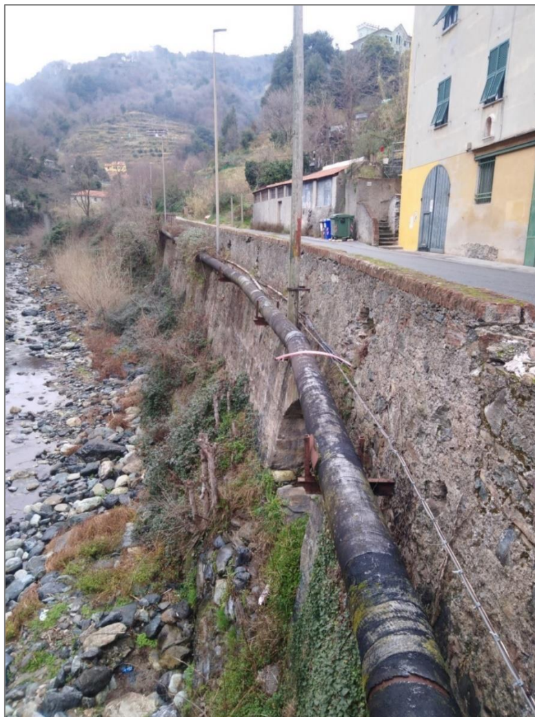
Figura 12_ La sponda sinistra con il muro d'argine che presenta punti sottoescavati. Vista da valle verso monte. Si intravede l'immissione del Rio senza nome in uscita dalla tombinatura sotto Via delle Fabbriche.
