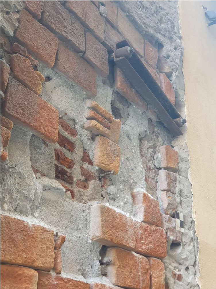
Foto 8 – Dettaglio dei mattoni posti a coltello in fase di distacco.
