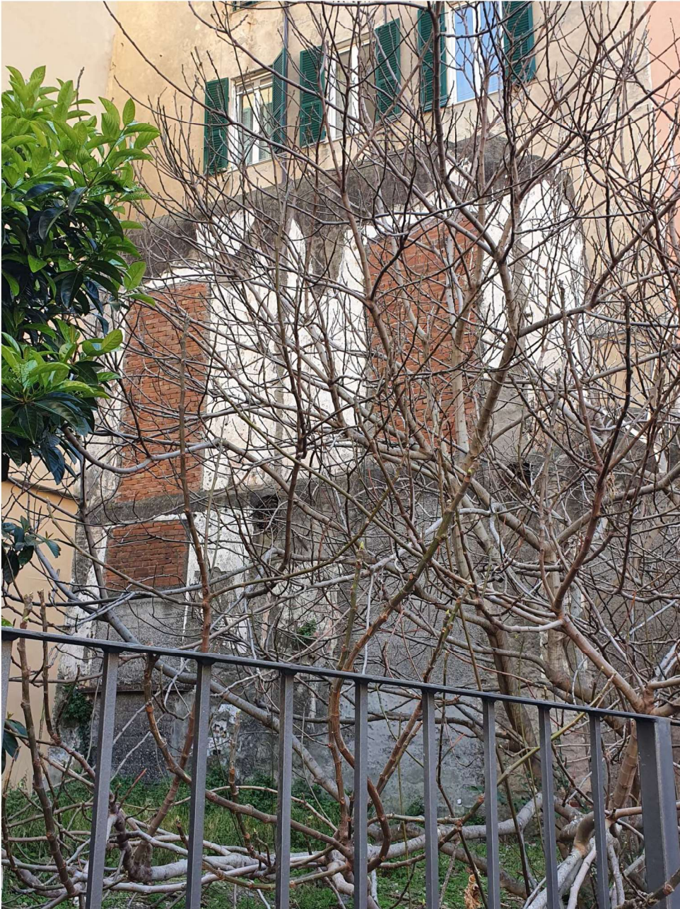
Foto 11 – Dettaglio dei tamponamenti delle bucaure vista dal lato del giardino privato; si nota che molti di questi sono eseguiti in mattoni forati e non possono pertanto contribuire alla resistenza statica della muratura.
