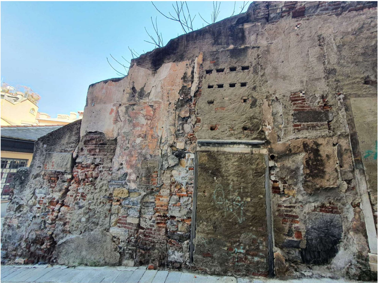
Foto 7 – Vista frontale della parte bassa della muratura; si notano anche qui tutti gli interventi susseguitisi nel tempo e l'assenza di ammorsamenti lungo le verticali di praticamente tutti i tamponamenti eseguiti. Tali interruzioni nella tessitura del muro costituiscono pericolose vulnerabilità.
