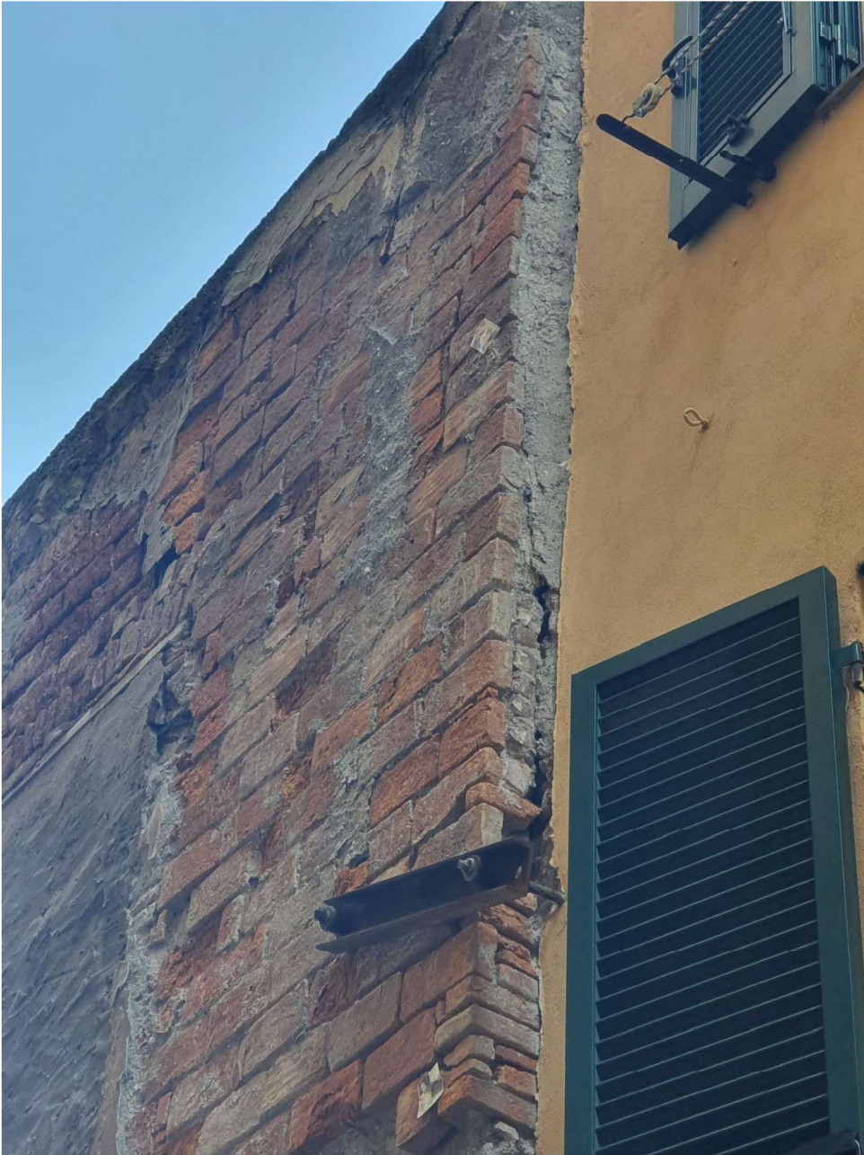
Foto 10 – Vista laterale dei mattoni posti a coltello completamente distaccati e pericolanti.
