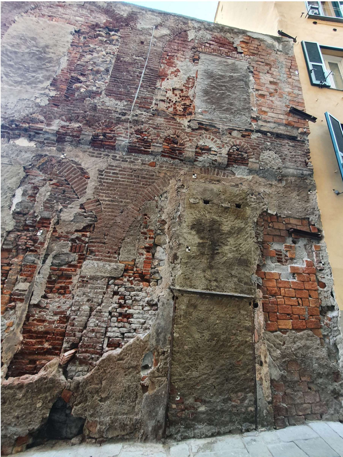
Foto 6 – Vista frontale della porzione alta di muratura; si notano le strutture che si sono susseguite nel tempo quali archi, colonne, tamponamenti sotto gli archi e tamponamenti di bucaure; a destra si notano, sia in basso che in alto, alcuni riempimenti a pareggiare la verticalità del muro eseguiti con laterizi pieni disposti a coltello, evidentemente poco efficaci dal punto di vista statico e in distacco continuo. Tali elementi rappresentano un pericolo per le persone che passano lungo Vico delle Fate.
