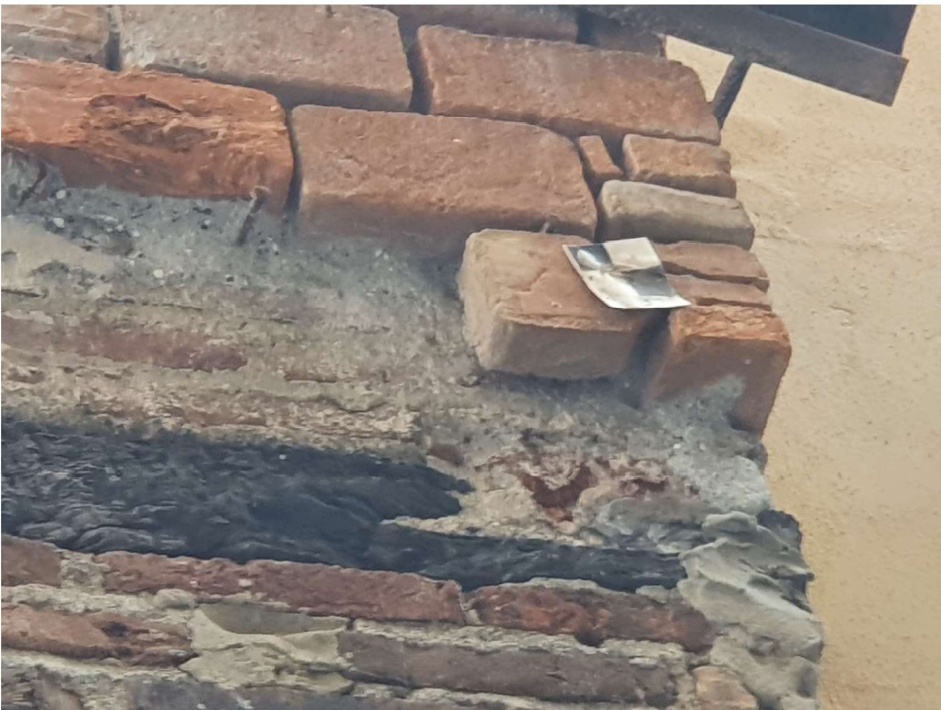
Foto 9 – Altro dettaglio dei mattoni a coltello in distacco.
