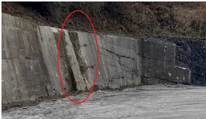
Foto n.ro 18: fessurazione fronte murario
