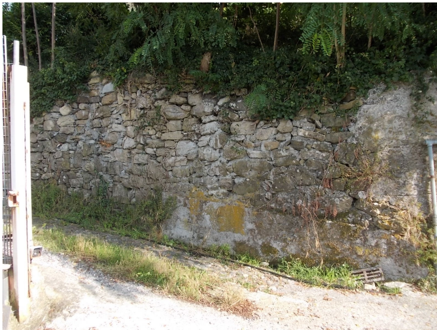
Vista del muro di sostegno della fascia soprastante, sede della strada comunale Salita Costa Fredda: il muro, realizzato nella prima metà del Novecento, non presenta alcun fenomeno fessurativo o cinematico
