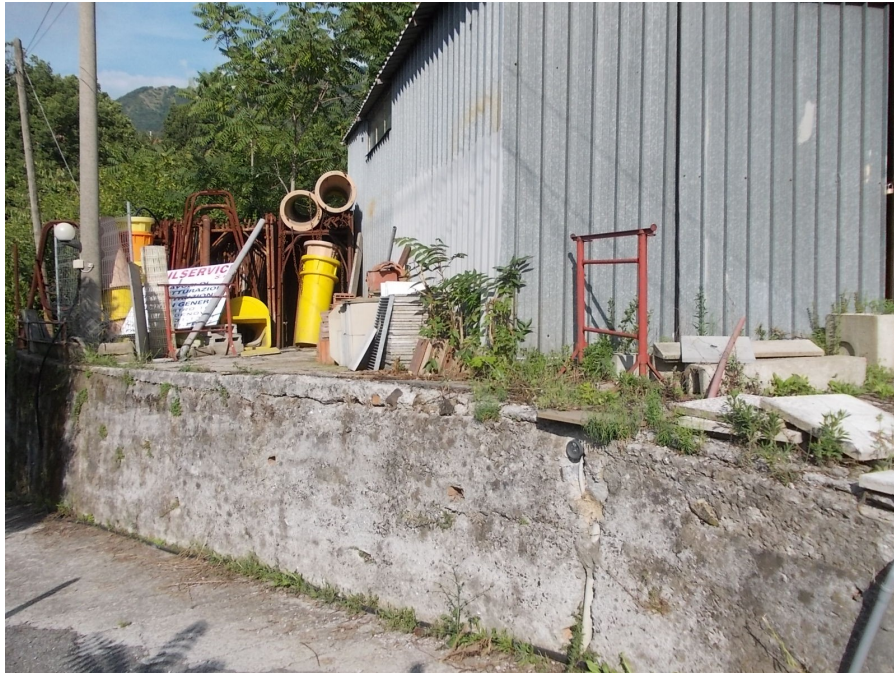
Vista della fascia sistemata da SUD: il muro di sostegno della fascia, realizzato da oltre 30 anni, non presenta alcun fenomeno fessurativo o cinematico
