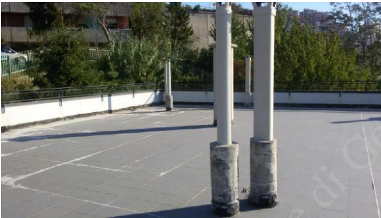
Foto 7 – camini in amianto da smaltire
