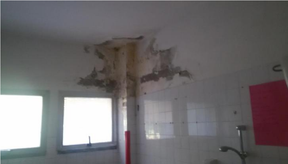
Foto 3 - esempio di infiltrazioni nei sottostanti locali sede dell'asilo nido
