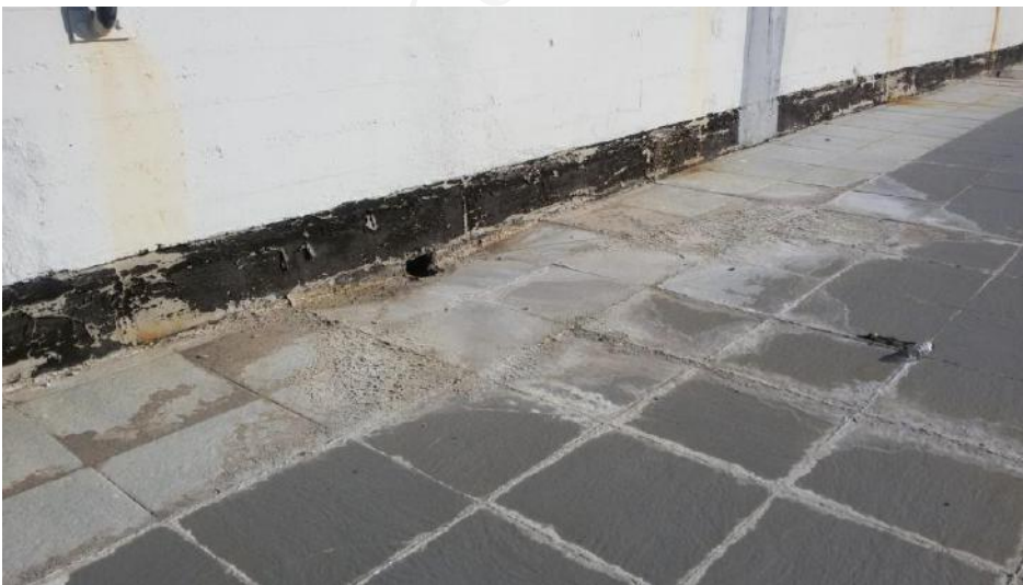
Foto 2 - esempio del degrado dell'attuale copertura
