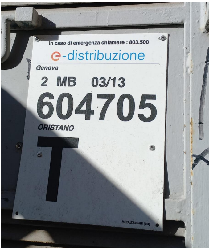
Foto 5-6: Vista dati locale tecnico e-distribuzione
