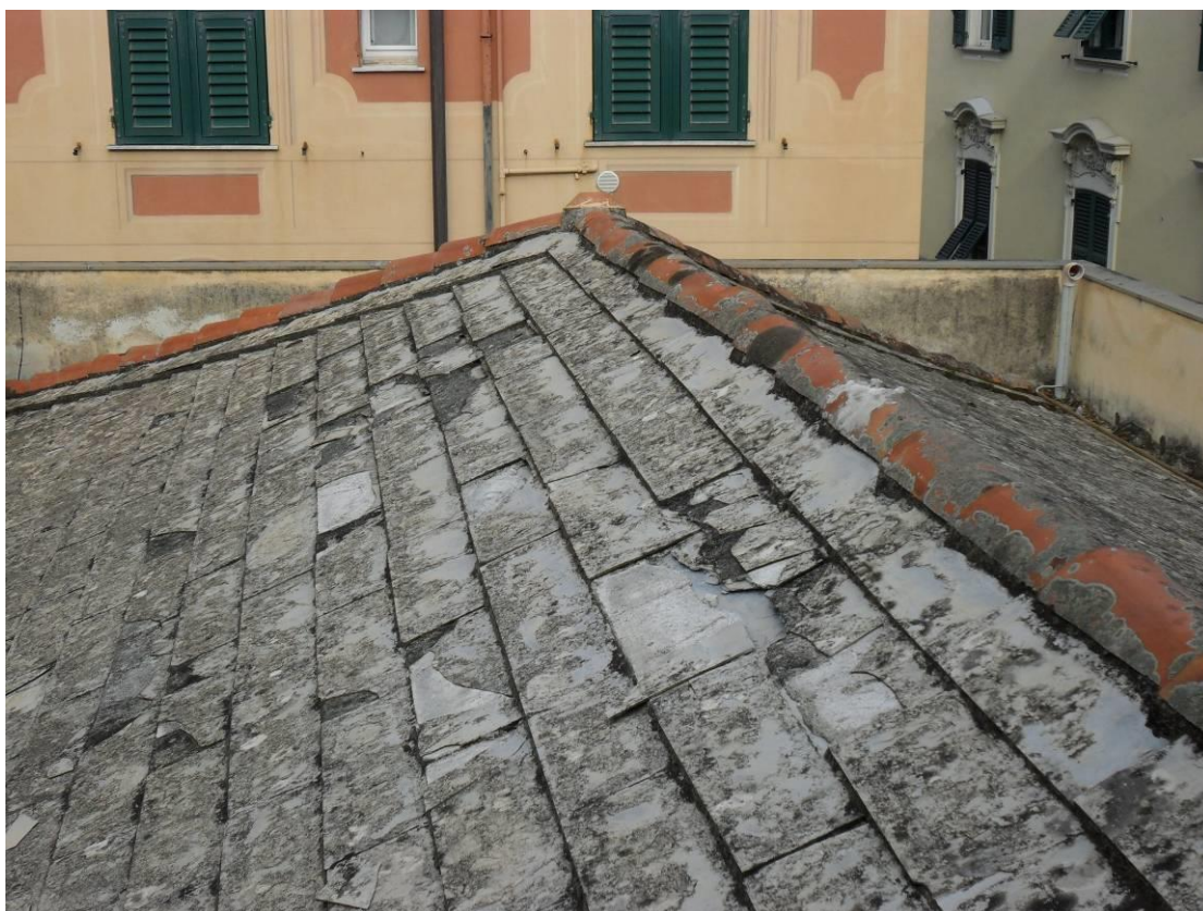
Foto 8 – La copertura a falde oggetto di intervento (manto in lastre di ardesia e colmi in laterizio)
