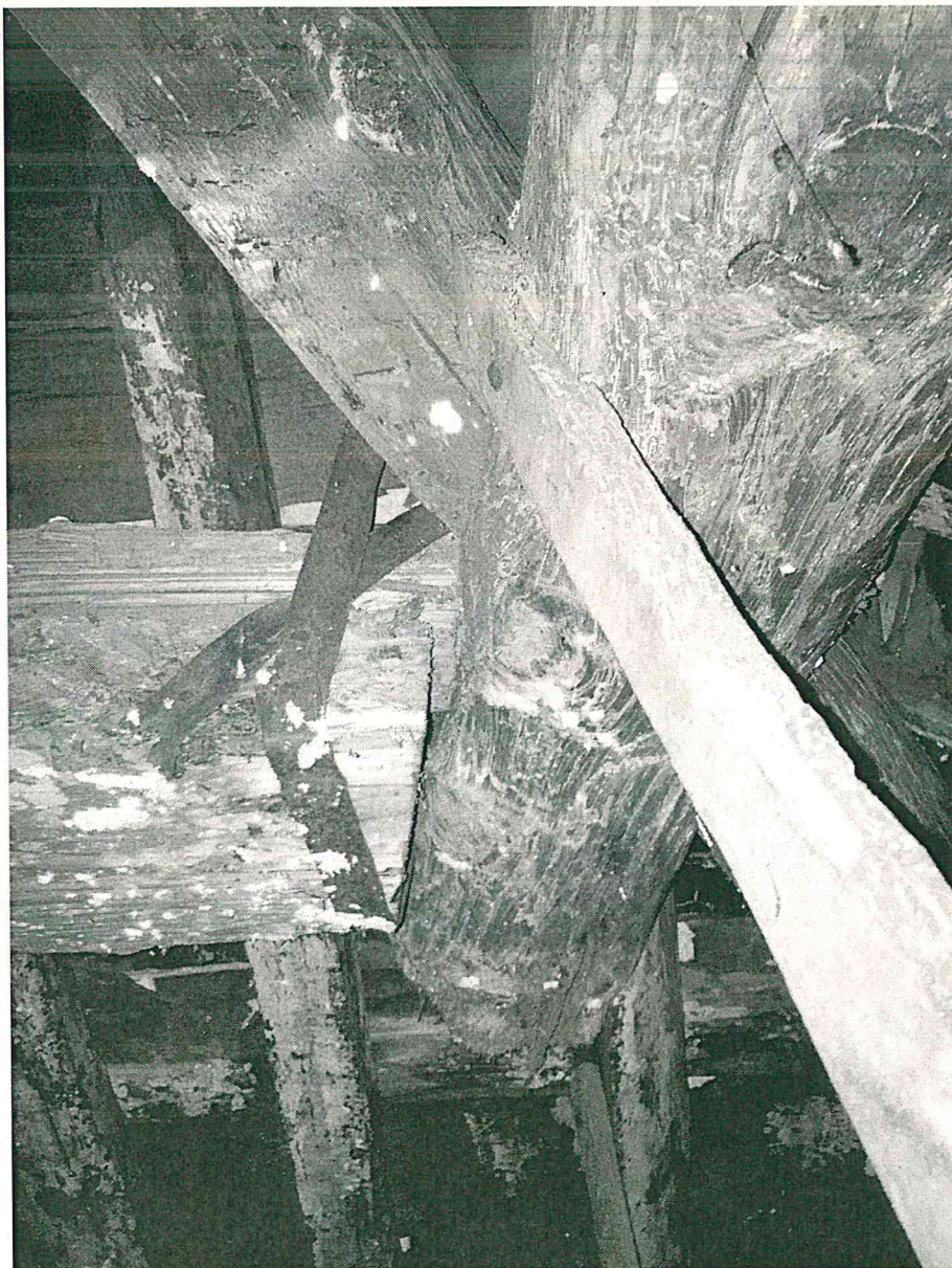
Foto 7 – Particolare del giunto tra il puntone angolare, il terzere longitudinale ed il terzere trasversale della terza falda del tetto
