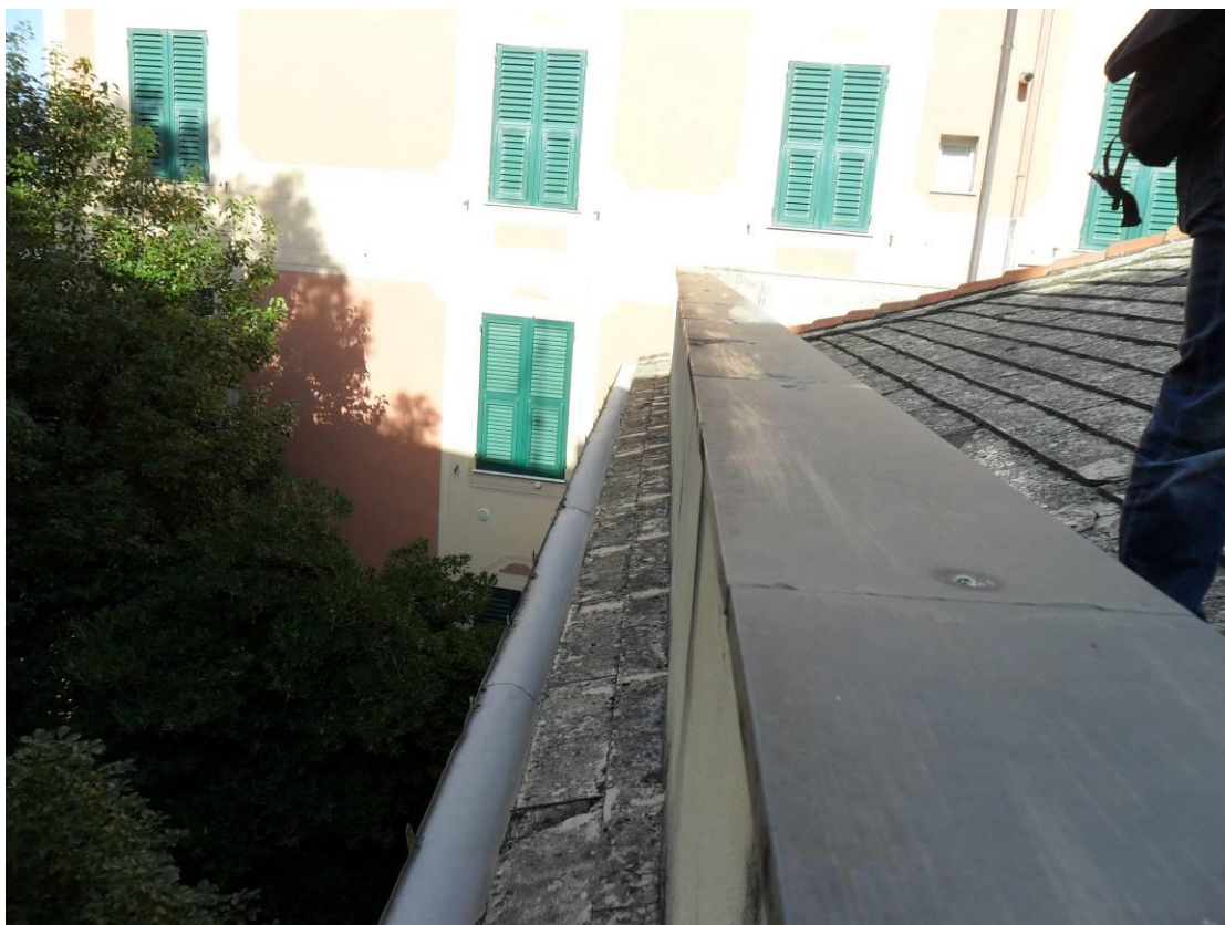
Foto 11 – Dettaglio del muretto d'attico, dell'aggetto della copertura e del canale di gronda
