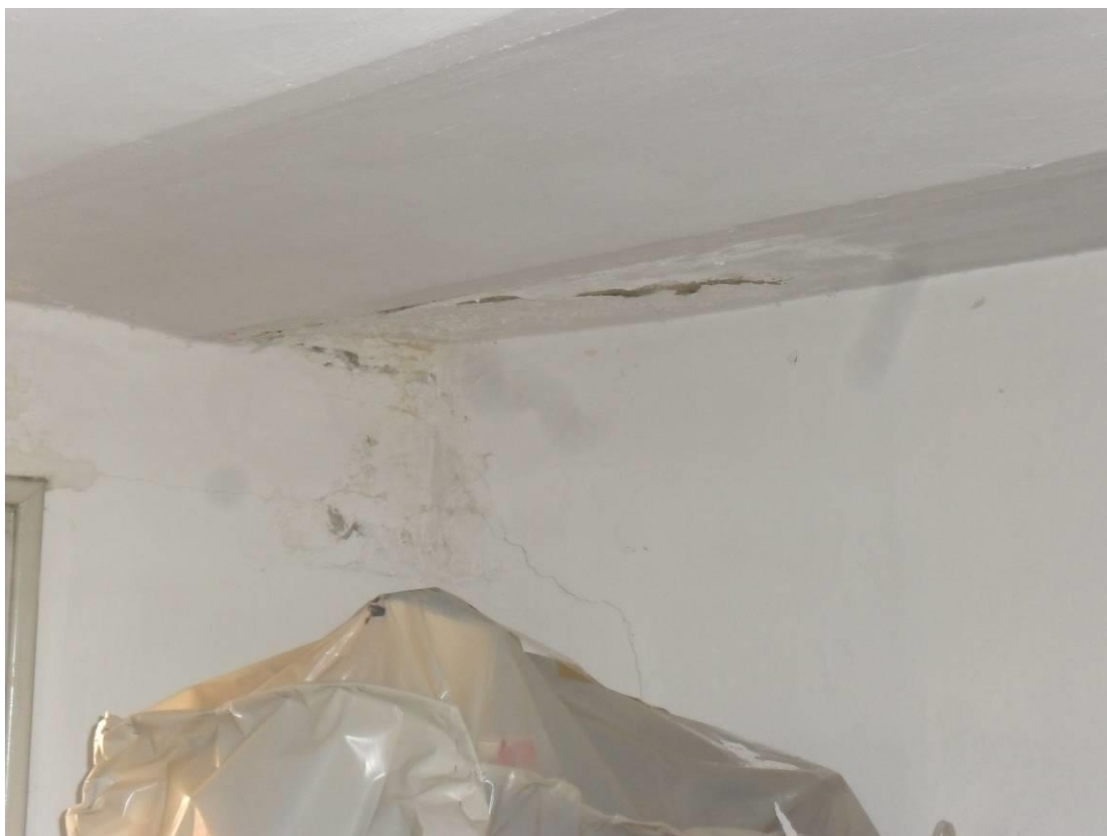
Foto 17 – Vista di una infiltrazione sottostante la copertura a terrazzo del corpo emergente.
