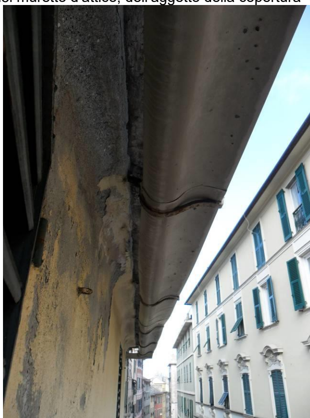
Foto 12 – Fronte su via Marco Sala: dettaglio del canale di gronda e del cornicione.
