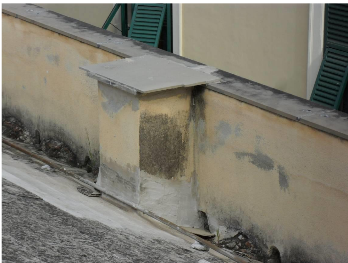
Foto 10 – Dettaglio di un camino oggi non più in uso e oggetto già in passato di un intervento per l'eliminazione di infiltrazione.
