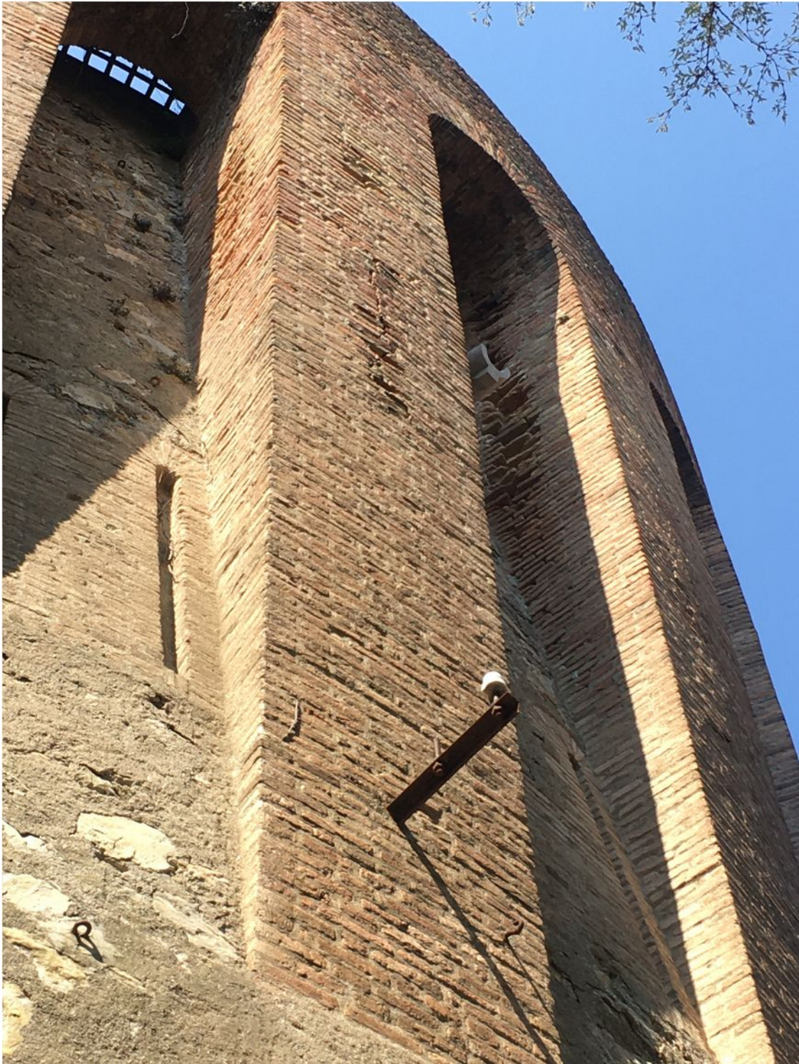
Punti interni agli archi dei contrafforti con mancanza di coesione tra i mattoni
