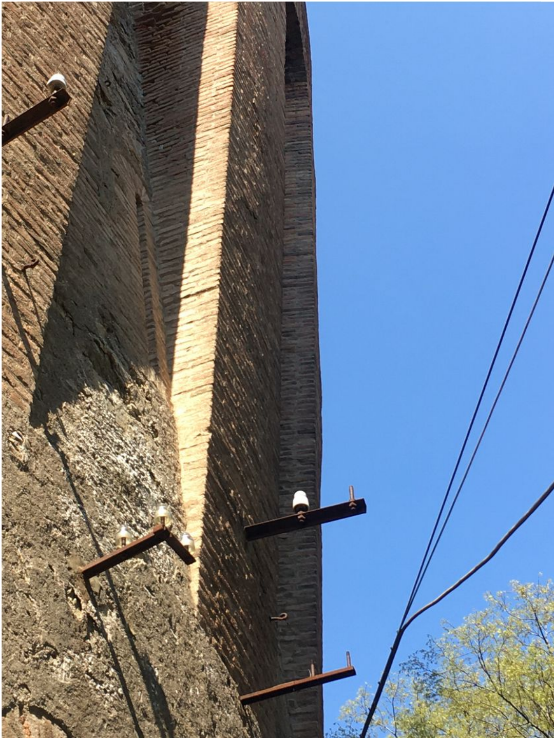
Visibile rigonfiamento della superficie esterna di due contrafforti
