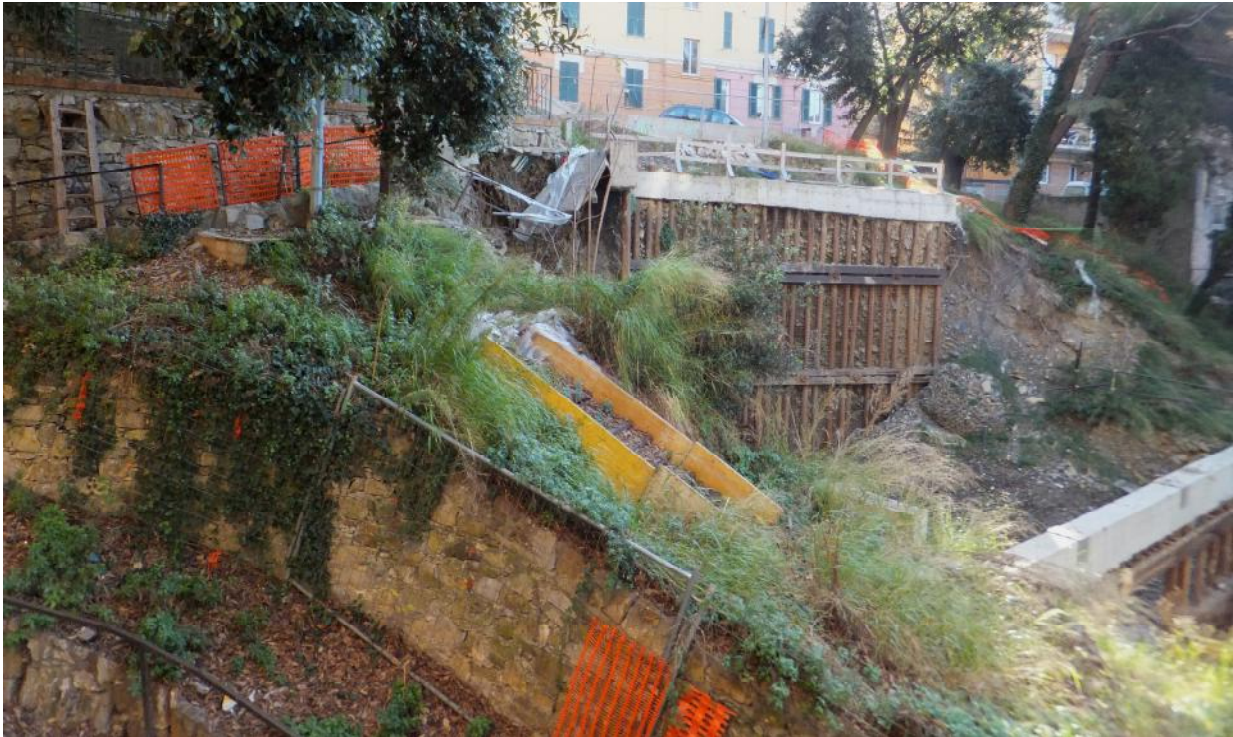
Foto 2 - Svuotamento copertura della tombinatura di Rio S.Ugo
