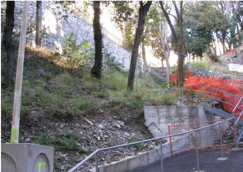
Foto 3 - Disseso localizzato nella porzione a sinistra dell'area d'intervento.
