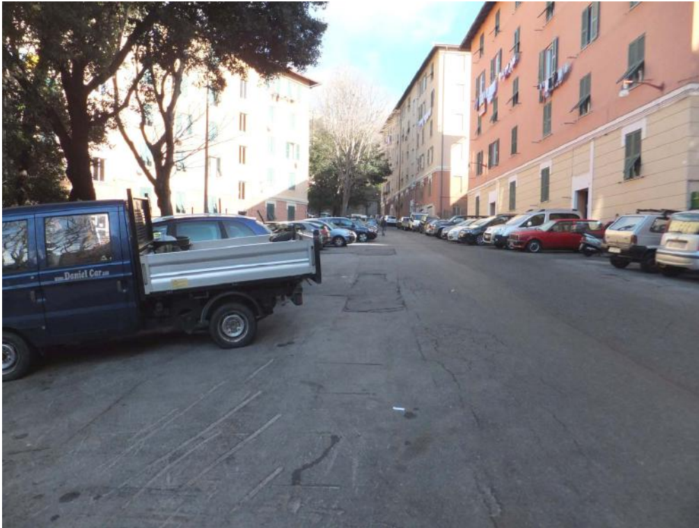
Foto 7 - tratto stradale di via G. Casaccia priva di regimazione delle acque bianche
