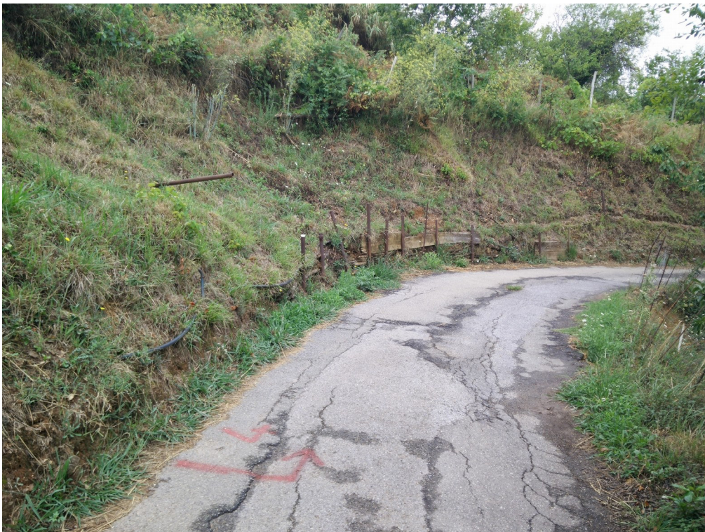
Foto 6 - Smottamenti con opere di contenimento provvisorie intervento n°4
