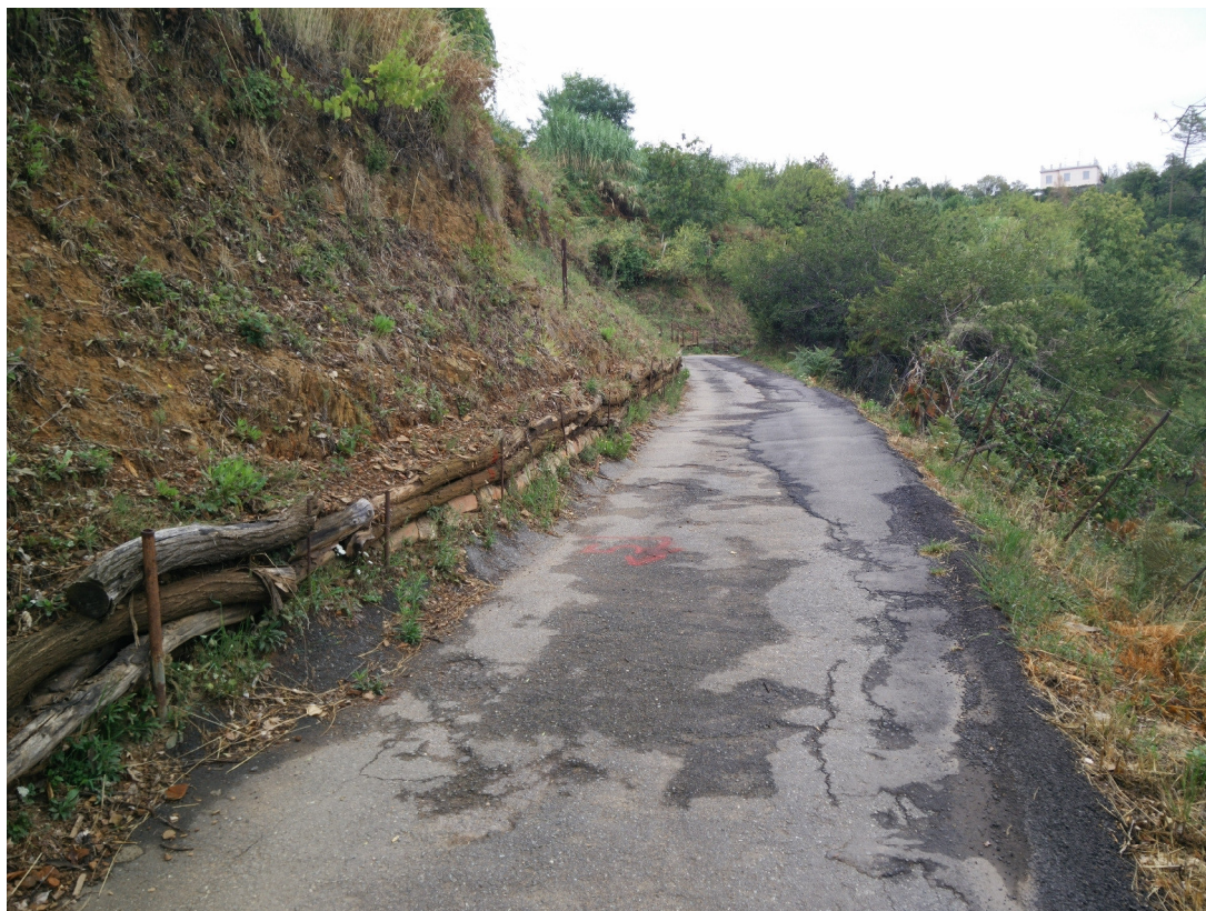
Foto 5 – Opere di contenimento provvisorie e segni di cedimento della dalla strada, intervento n°5.
