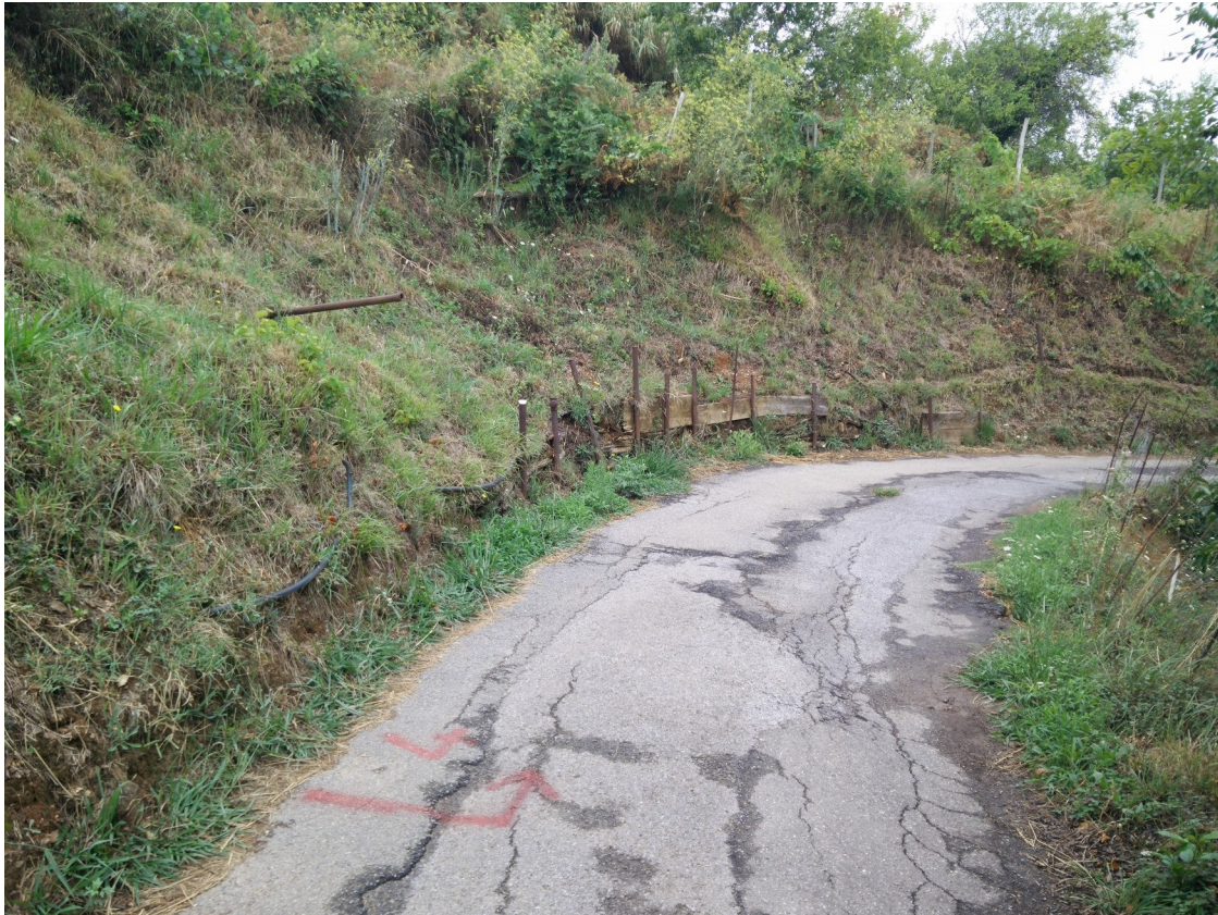
Foto 4 – Smottamenti con opere di contenimento provvisorie, parte dell'intervento n°4.
