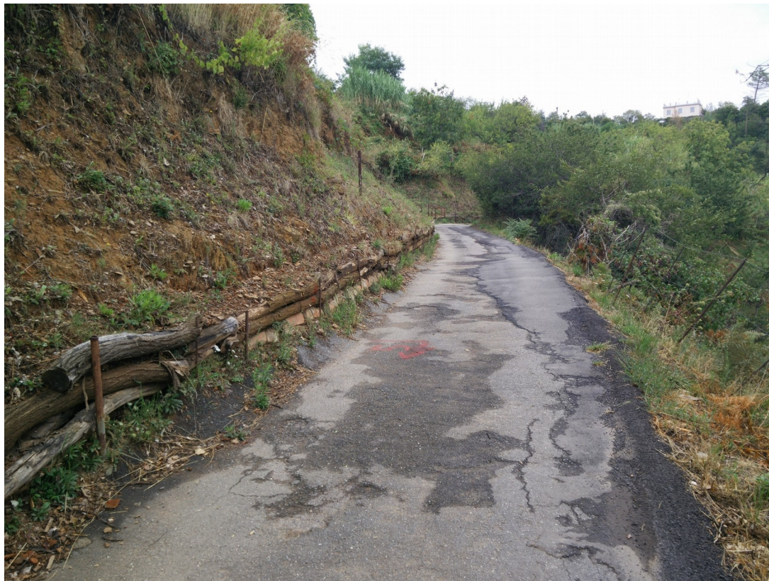
Foto 17 – Opere di contenimento provvisorie e segni di cedimento della dalla strada, intervento n°5.
