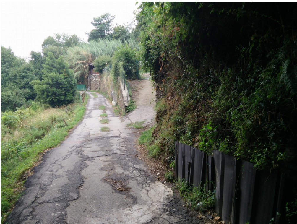
Foto 4 – situazione di dissesto del manto stradale
