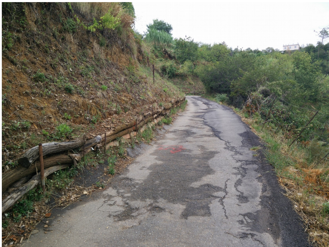
Foto 5 – Opere di contenimento provvisorie e segni di cedimento della dalla strada, intervento n°5.
