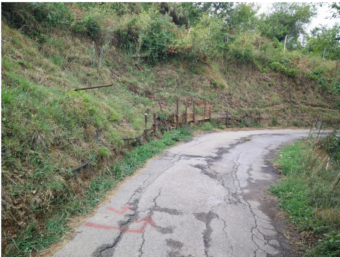
Foto 16 – Smottamenti con opere di contenimento provvisorie, parte dell'intervento n°4.
