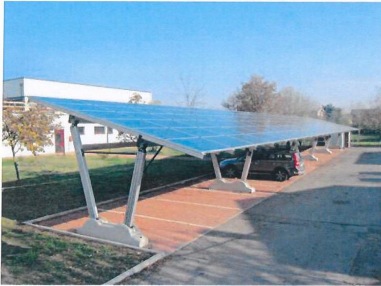
Immagine 2.7: esempio di pensilina auto con impianto fotovoltaico
