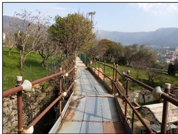
Vista da SO della passerella metallica su tubi innocenti in loc. Cà de Rissi.
