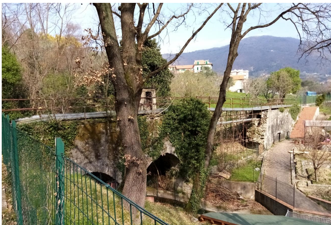
Vista del tratto di Acquedotto Storico crollato e sostituito con una passerella su tubi innocenti a monte del civ. 35 di loc. Ca' de Rissi.
