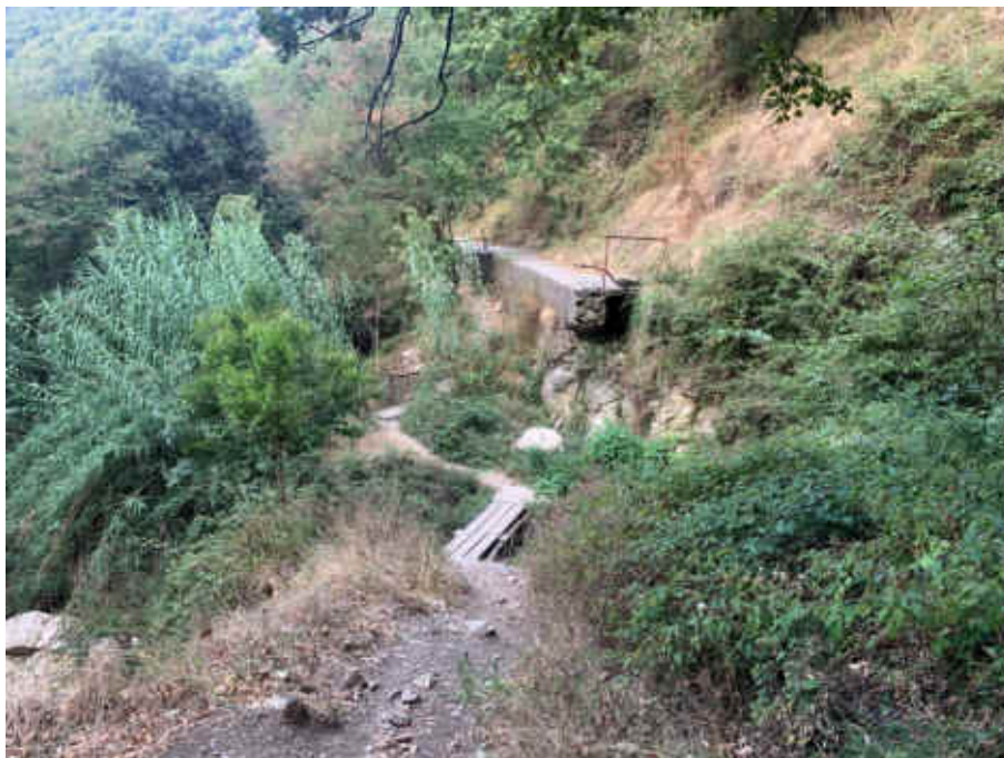
Foto 4 – Crollo di AS con dissesto idrogeologico – Vista moncone lato Trensasco
