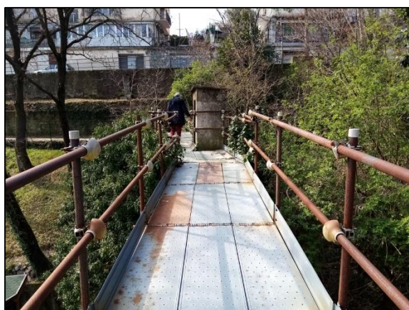
Vista da NE della passerella metallica su tubi innocenti in loc. Cà de Rissi.
