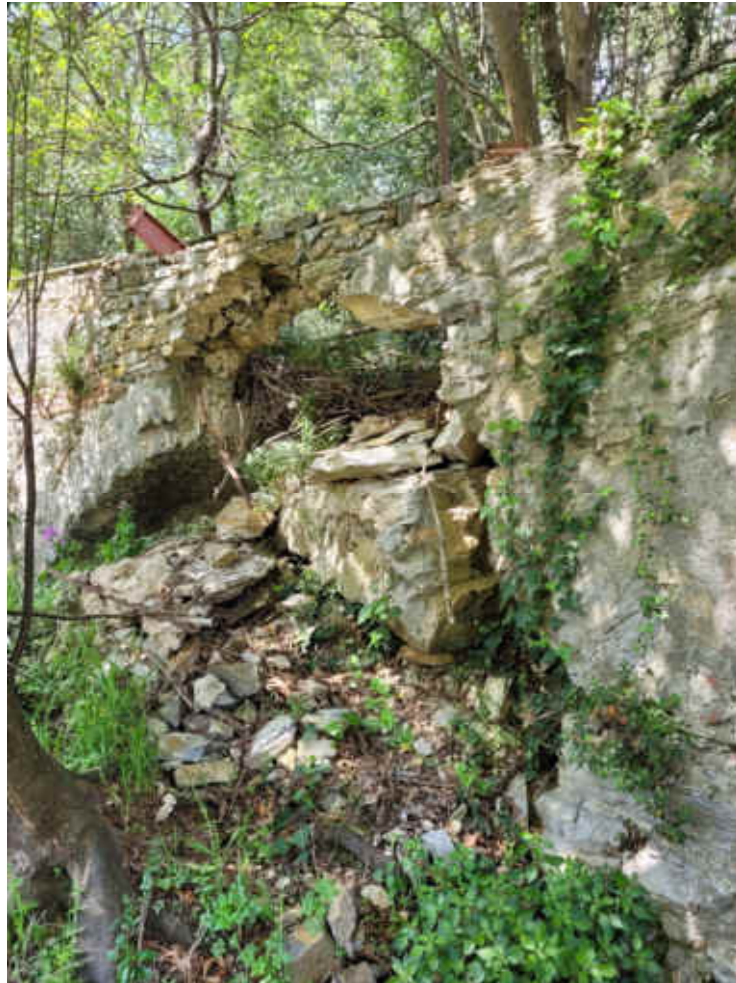
Foto 22 – particolare porzione di spalla a sbalzo per effetto del dissesto occorso in Via delle Ginestre
