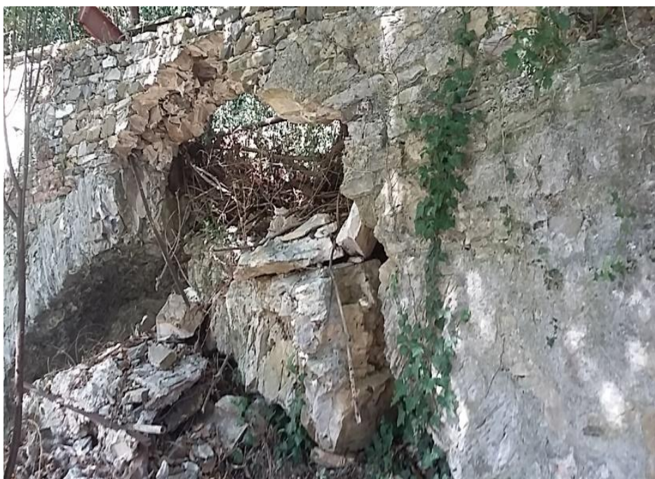
Tratto di Acquedotto antico parzialmente crollato e transennato per motivi di sicurezza, su cui si interverrà con progetto di consolidamento strutturale.
