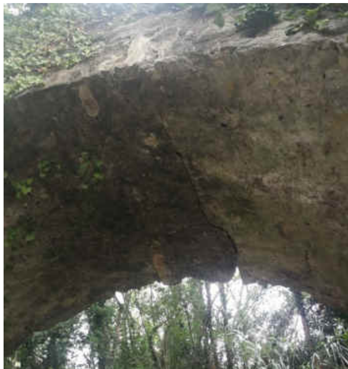
Foto 17 – Particolare lesione in chiave sull'arcata centrale
