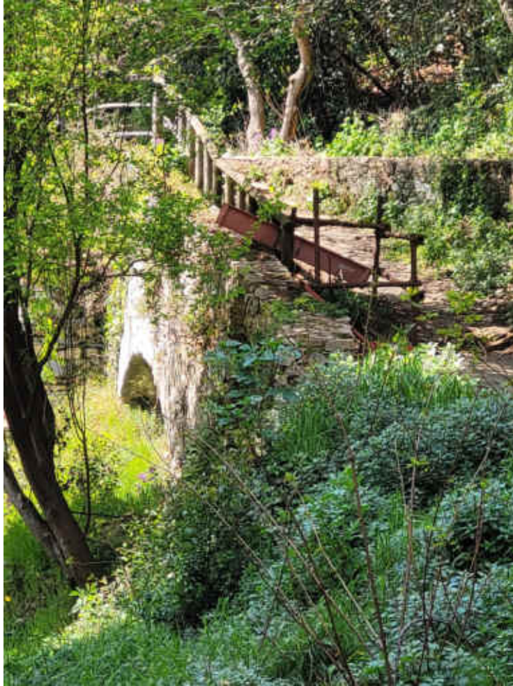
Foto 20 – Porzione di AS disestata in Via delle Ginestre
