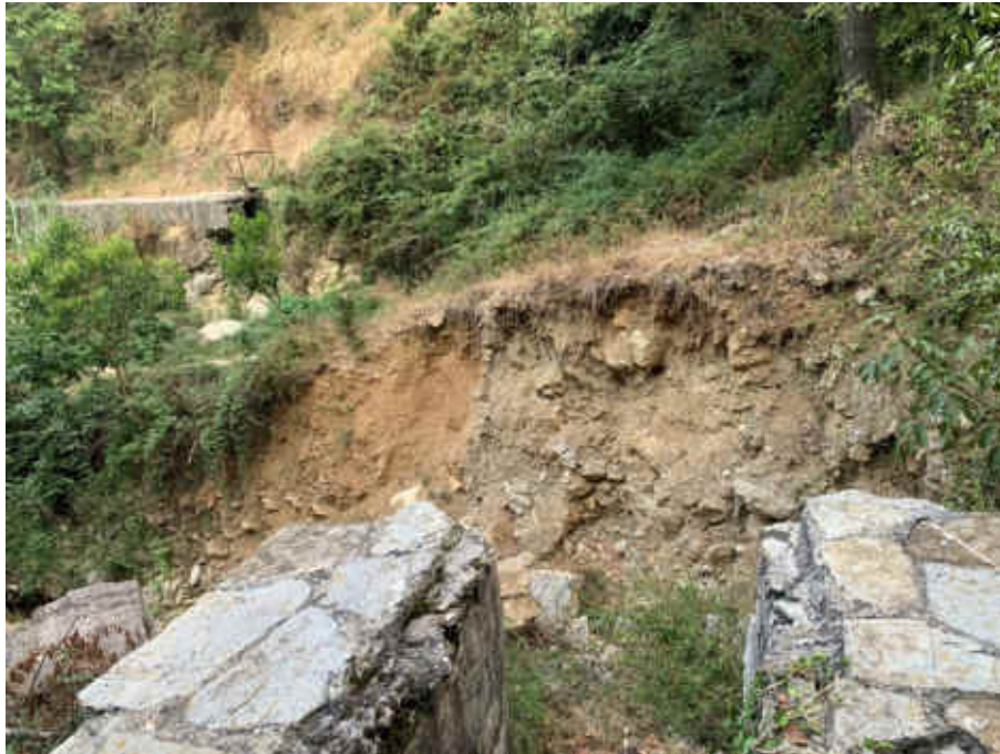
Foto 3 – Crollo di AS con dissesto idrogeologico – Vista in direzione Trensasco
