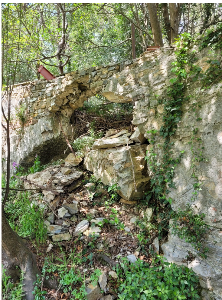
Foto 1 – particolare porzione di spalla a sbalzo per effetto del dissesto occorso in Via delle Ginestre
