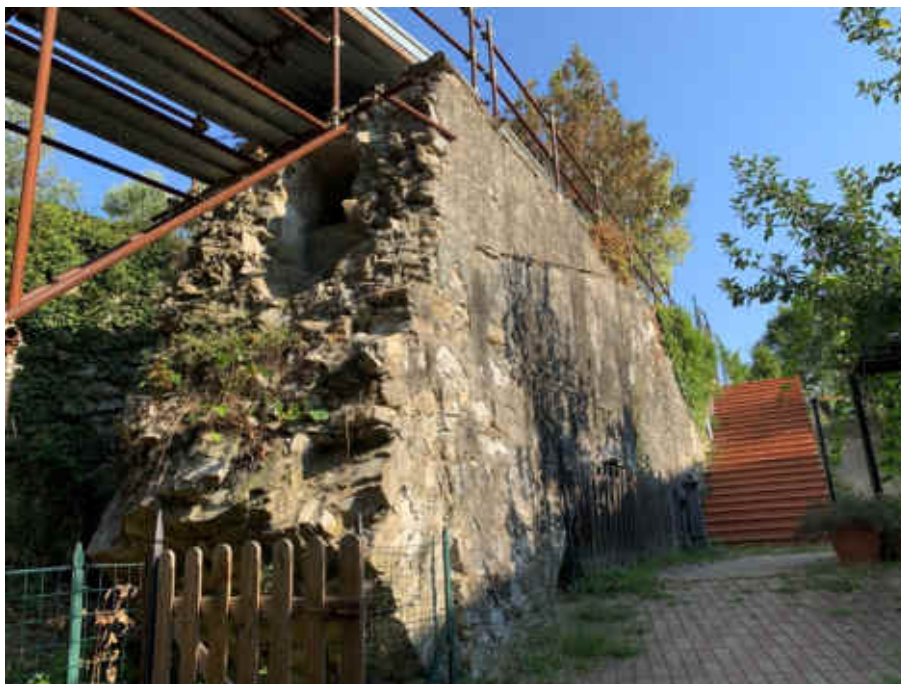
Foto 14 – Particolare “moncone” ponte crollato
