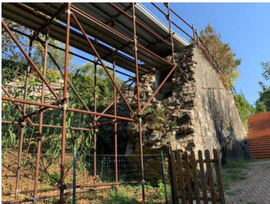
Foto 15 – Particolare struttura tubolare a sostegno delle passerelle nella porzione di ponte crollato
