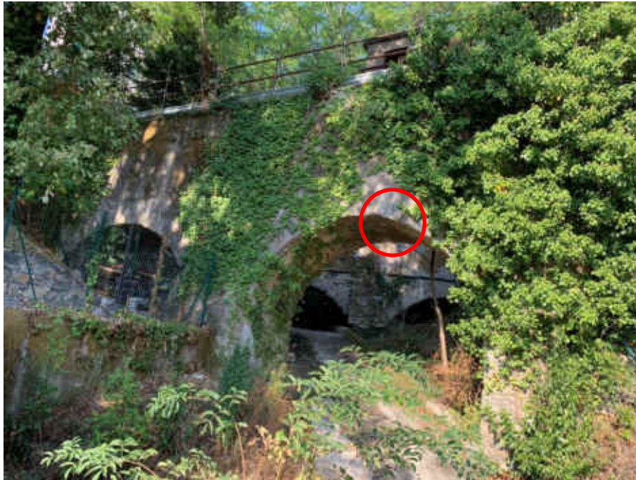
Foto 16 – Particolare lesione in chiave su arcata del ponte
