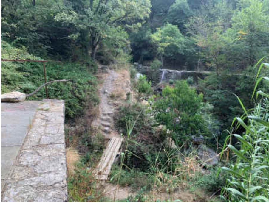
Foto 5 – Crollo di AS con dissesto idrogeologico – Vista in direzione Pino di Molassana
