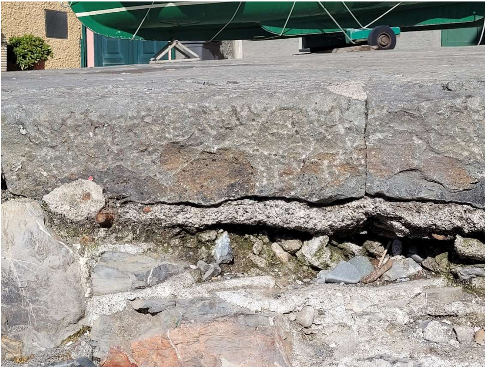
Immagine relativa al dettaglio della muratura sottostante a Piazza Nettuno a Boccadasse sul confine della spiaggia, con tracce di strato di calcestruzzo armato.
