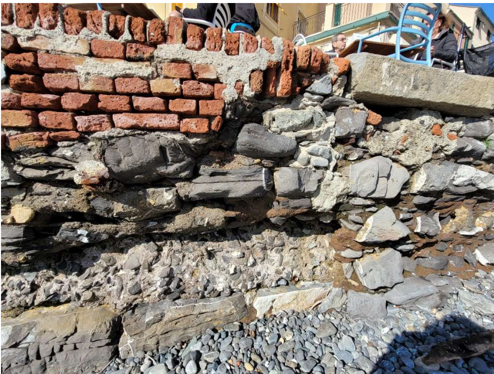
Immagine relativa alla muratura sottostante a Via Aurora e Piazza Nettuno a Boccadasse sul confine della spiaggia.
