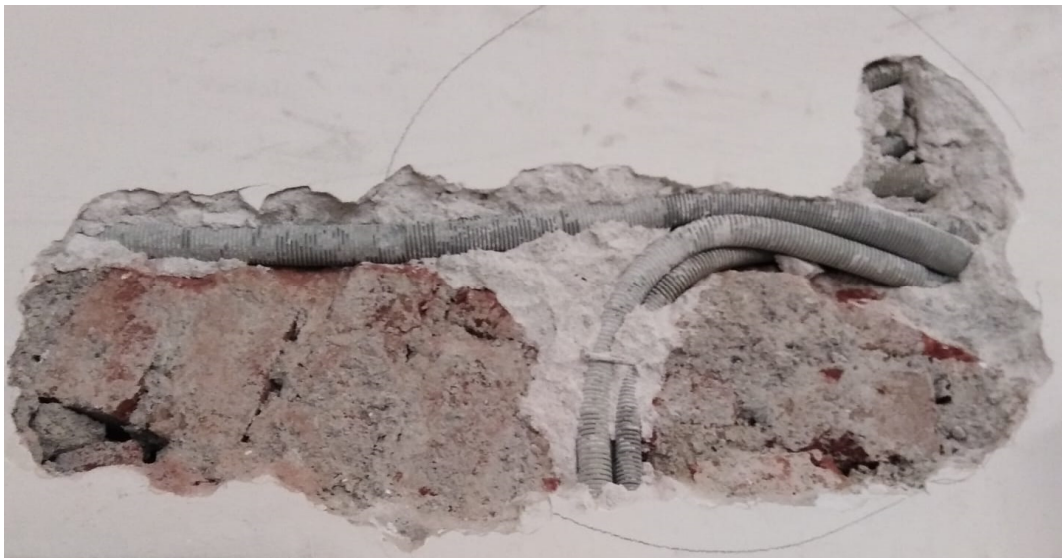
Figura 1 - Saggio in parete muraria (sono visibili numerose interferenze impiantistiche)
