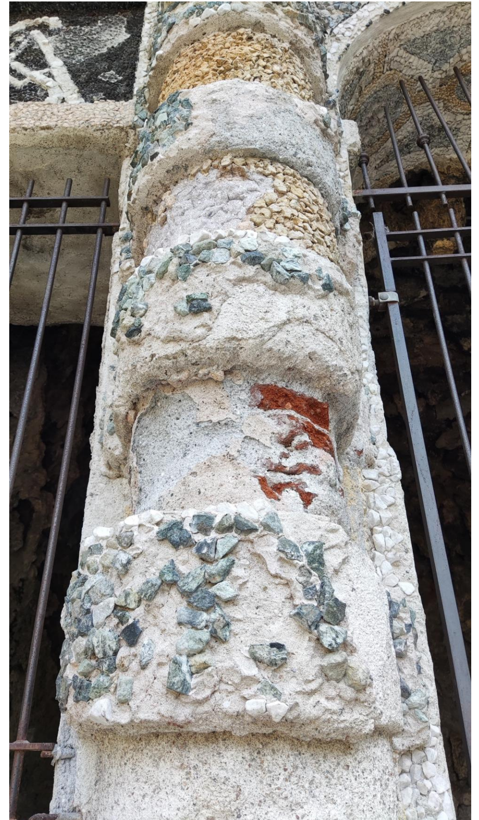
Stato di conservazione del rivestimento lapideo
