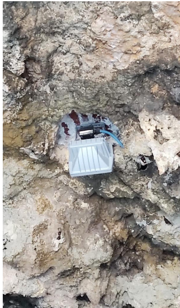
Dettaglio dell'impianto di illuminazione esistente
