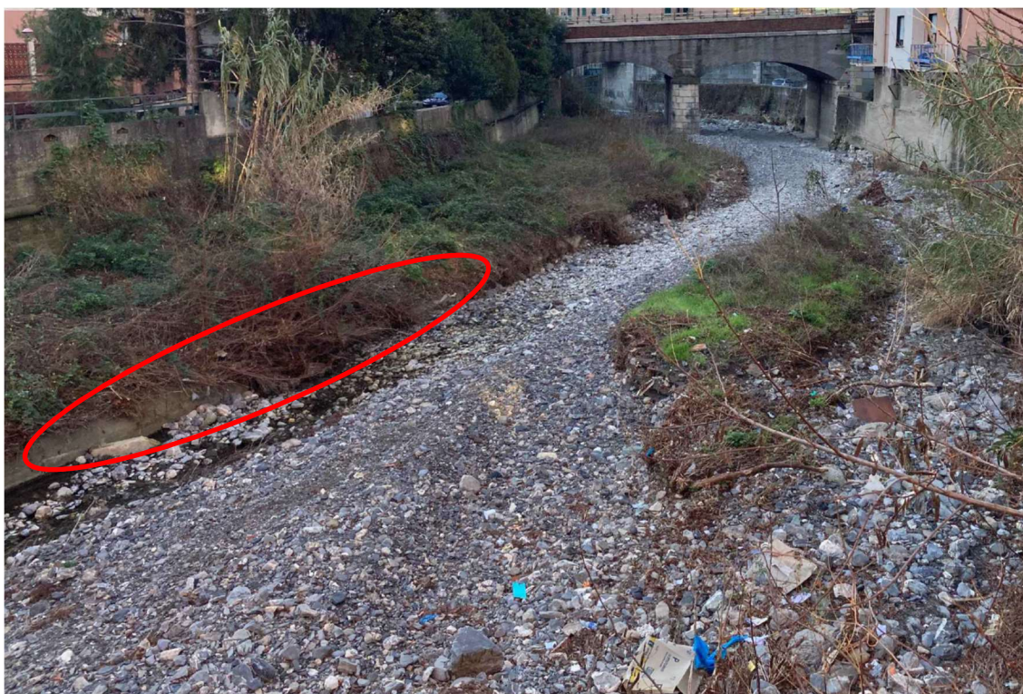
Figura 0-11: Vista del t. Torbella dal ponte di via Fasciotti verso valle. Il metanodotto si trova parzialmente interrato in sinistra idraulica (evidenziato dall'ellisse in rosso)
