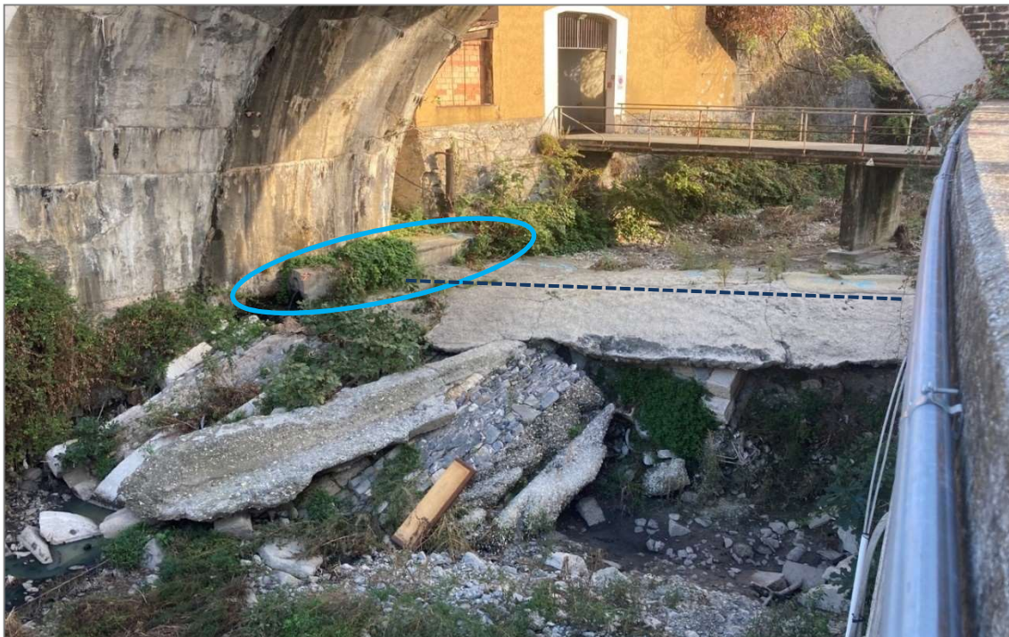
Figura 0-6: Salto di fondo del t. Torbella a monte rispetto alla confluenza con il t. Polcevera. il bauletto della fognatura bianca sfocia propria in prossimità di questo salto, dove evidenziato con l'ellisse in azzurro. Si evidenzia inoltre la condotta di acquedotto DN500 che si trova al di sotto della soglia in cemento
