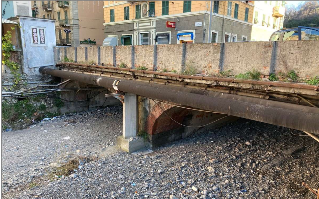
Figura 0-13: Condotte del gas sul lato di valle del ponte di via Canepari
