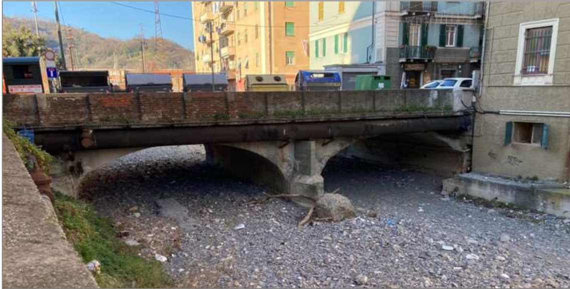
Figura 0-2: Condotta dell'acquedotto ancorata sul lato di monte del ponte di via Canepari
