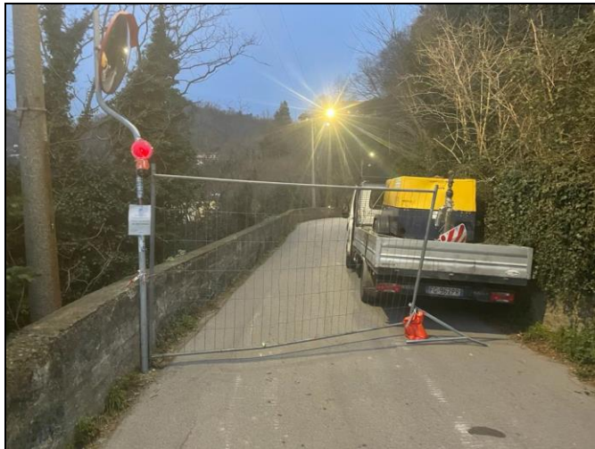
Figura 13: mercoledì 10 gennaio. Alla sera Strada sgombera (1 corsia), transito consentito ai soli mezzi d'emergenza . A sinistra settore frana, a dx estremo di valle interdetto.
