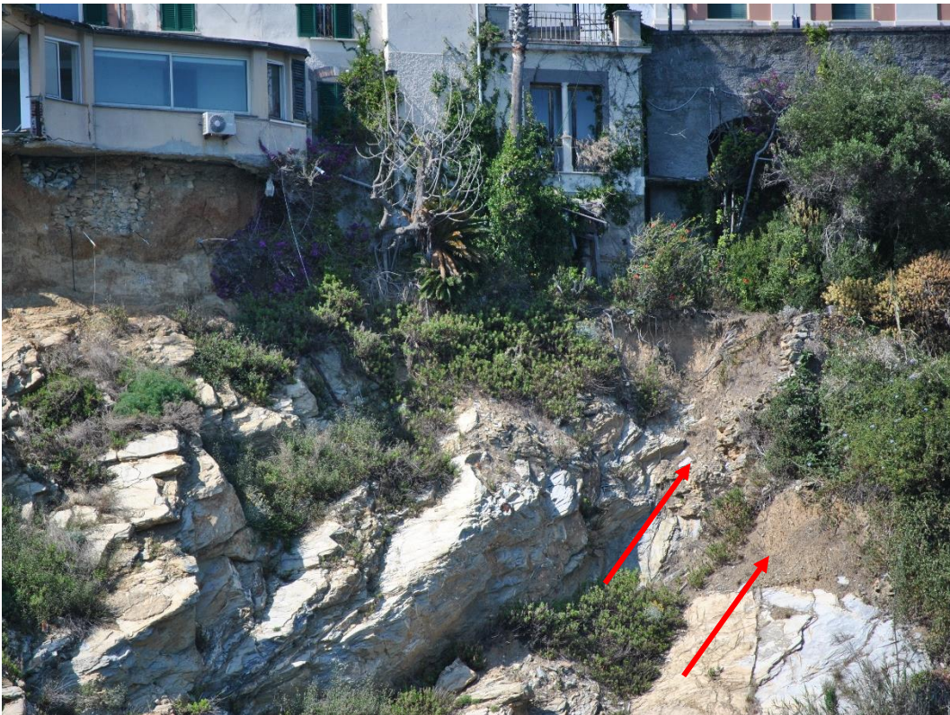
Foto 8: Dettaglio delle fondazioni scalzate degli edifici (civ. 47). Le frecce indicano resti di muri a secco e materiale detritico in precarie condizioni di stabilità.
