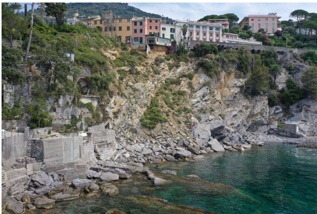
Foto 3.5: particolare della frana da ponente - foto da drone – giugno 2022
