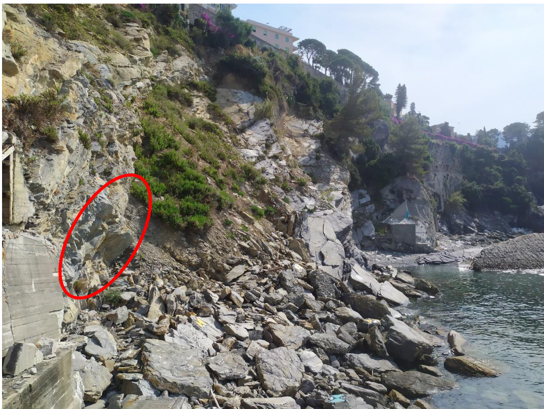
Foto 6: Dettaglio della base della parete rocciosa coinvolta dalla frana del 2014. L'ellisse indica i due affioramenti dove è stato svolto il rilevamento geomeccanico.
