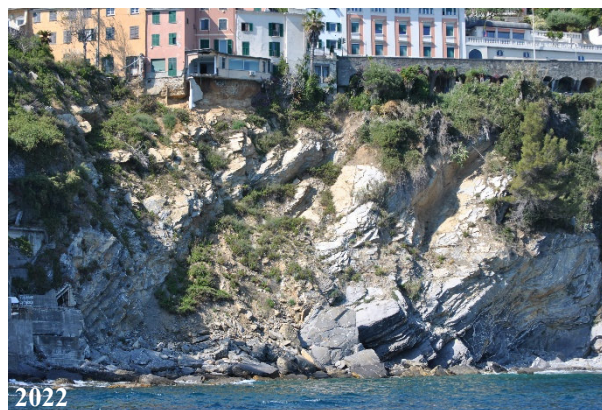
Figura 13 – Confronto della falesia oggetto del presente intervento, in località Capolungo, negli anni 2005, 2014 (fonte: Lucchetti et Al. 2014) e 2022 (fotografata dalla scrivente).
