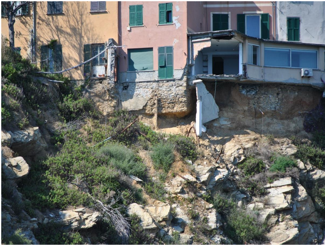
Foto 7: Dettaglio delle fondazioni scalzate degli edifici (civv. 43, 45, 47).
