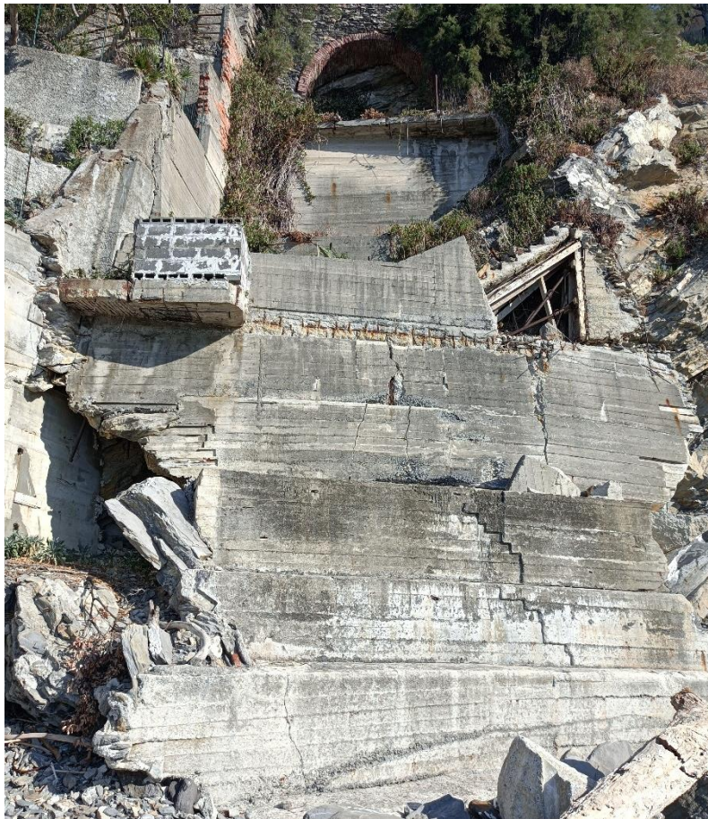
Foto 10: Muri in cemento armato a Ovest della frana. Si notano profonde lesioni.
