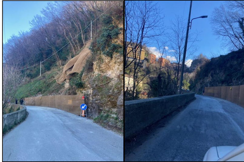
Figura 18: venerdì 12. La strada è stata riaperta al traffico senza necessità di impianto semaforico, come concordato durante sopralluogo in prima mattinata tra DL, Impresa, tecnici della Mobilità e Polizia Locale. Proseguono le attività in parete.
