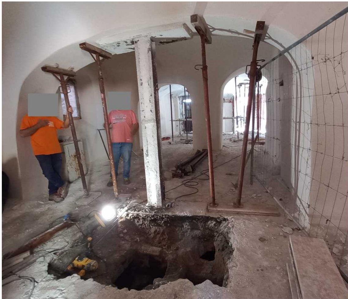
Foto 18 - Particolare pilastro in falso
