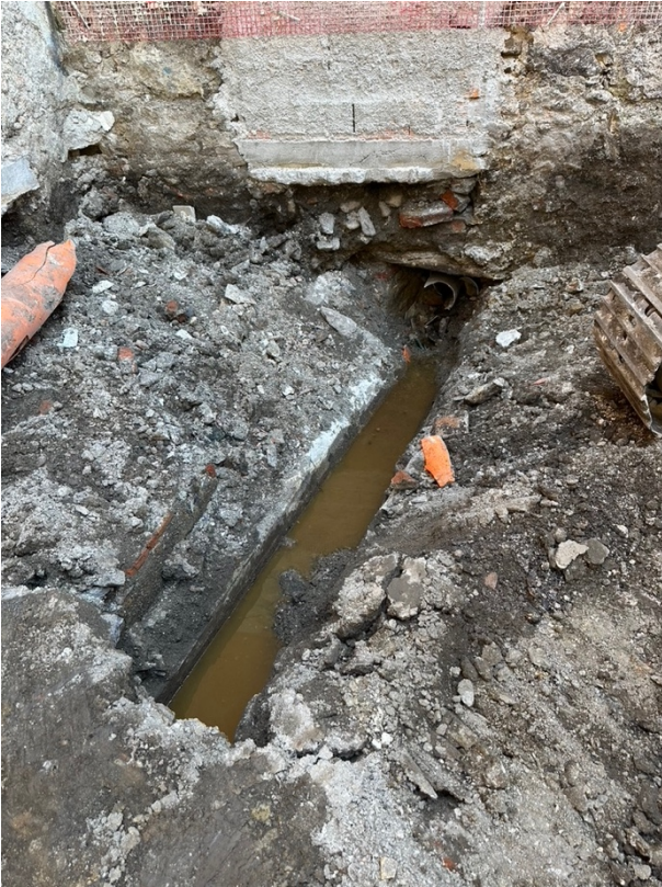
Foto 25 - Collettore esistente danneggiato
