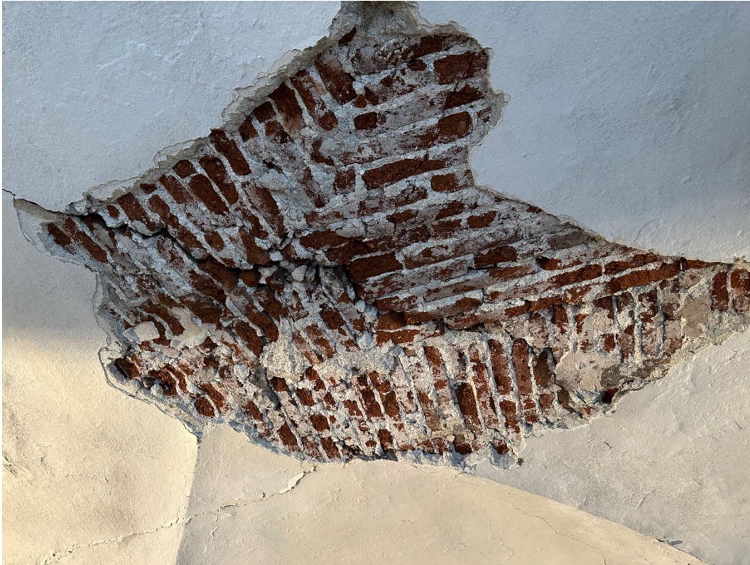
Foto 12 - Lesioni sulla volta
