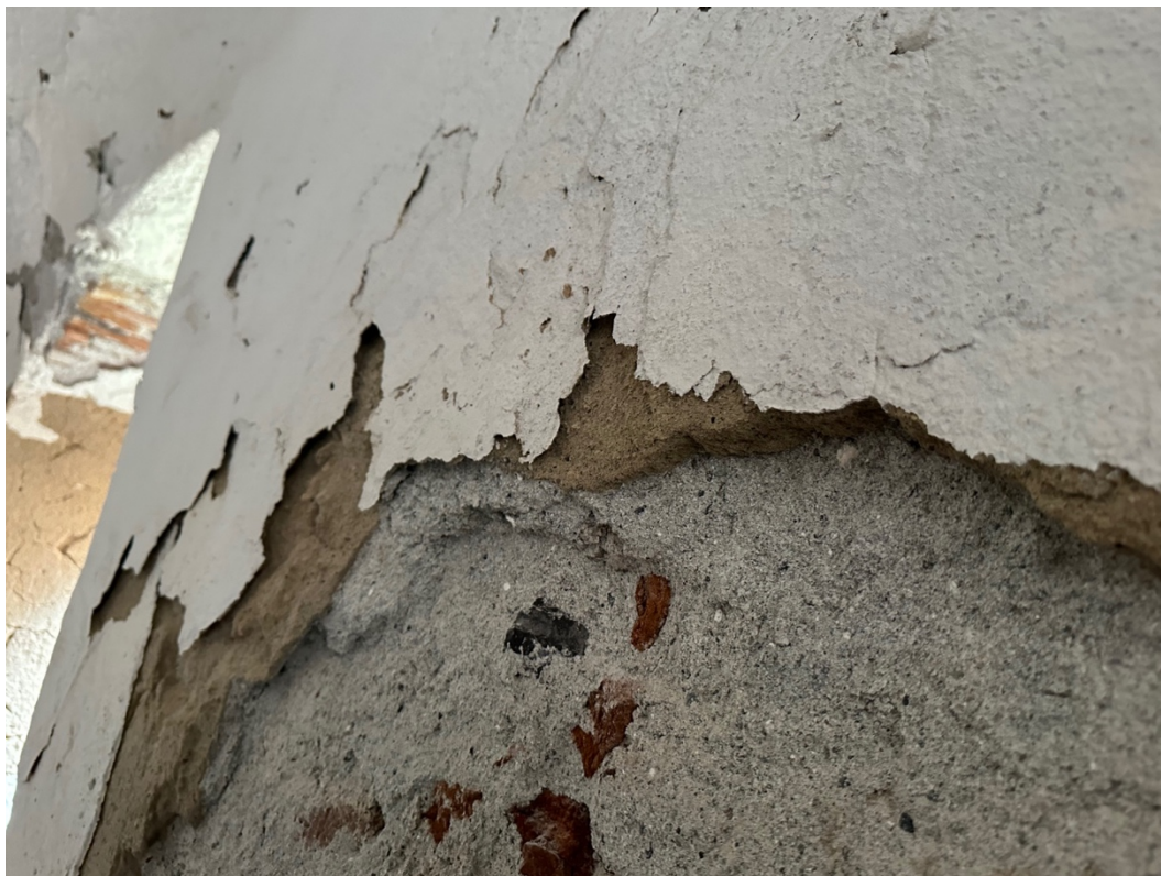
Foto 7 - Consistenza paramento murario e intonaco
