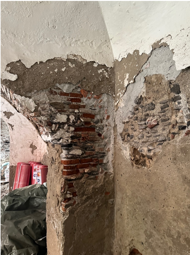
Foto 10 - Consistenza paramento murario e intonaco
