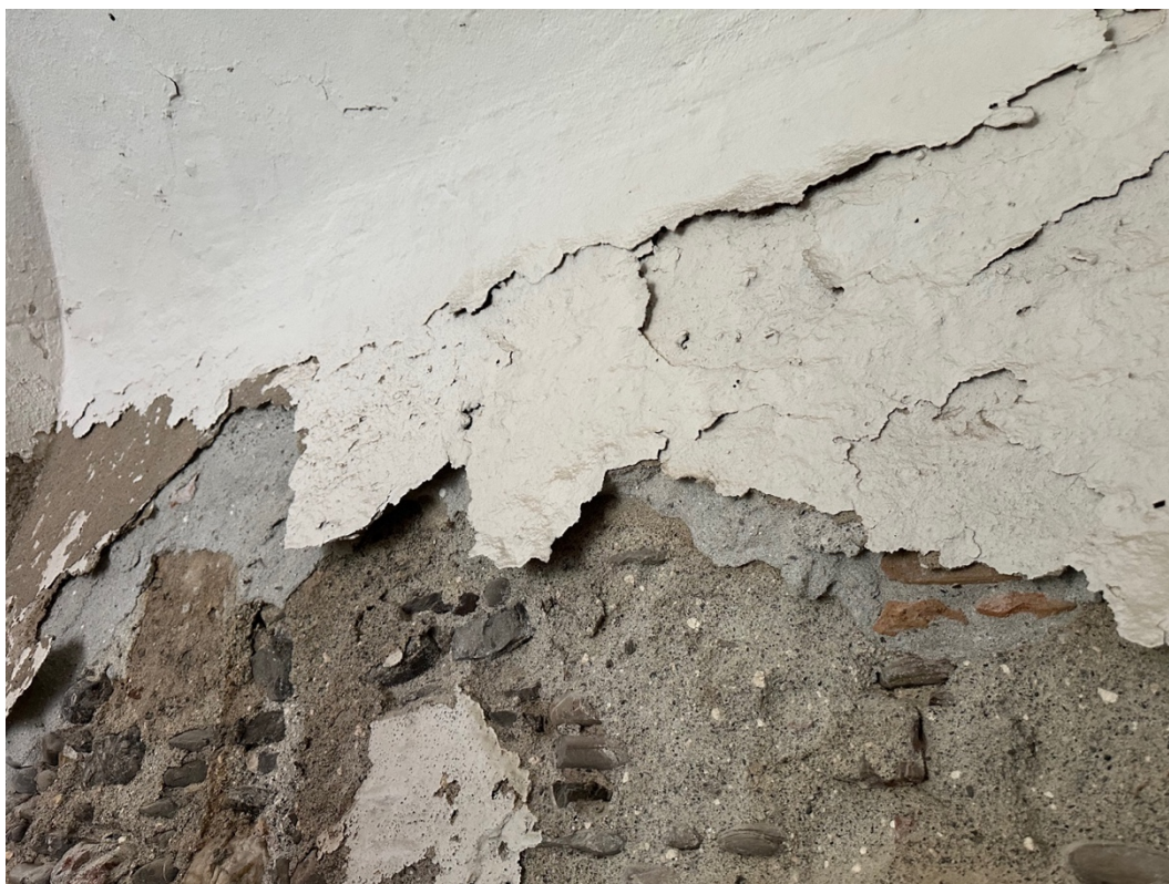
Foto 8 - Consistenza paramento murario e intonaco
