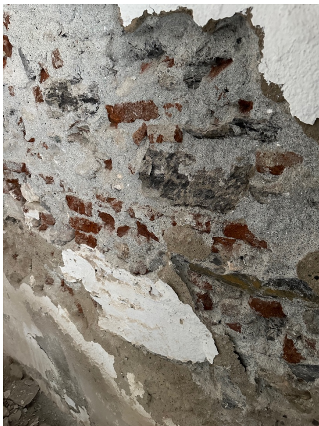
Foto 5 - Consistenza paramento murario e intonaco
