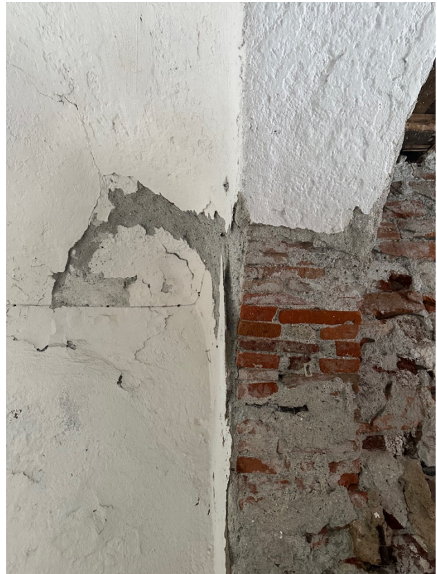
Foto 11 - Consistenza paramento murario e intonaco
