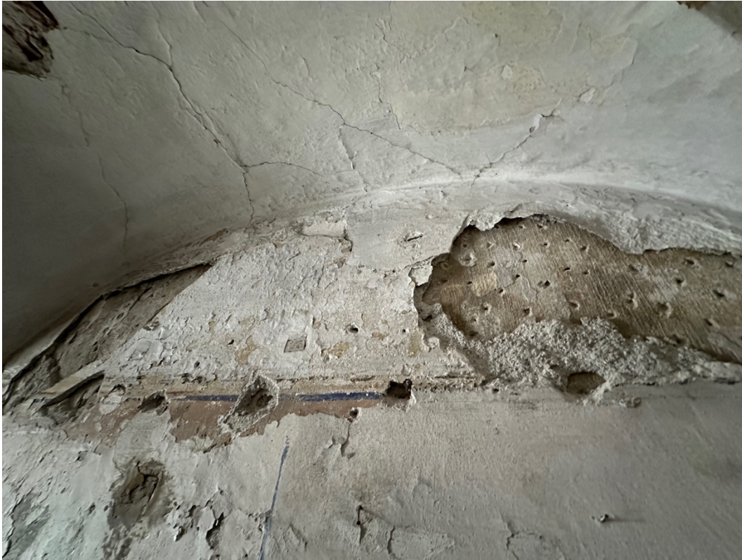
Foto 9 - Consistenza paramento murario e intonaco
