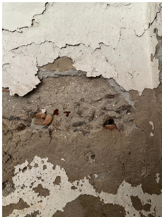
Foto 6 - Consistenza paramento murario e intonaco
