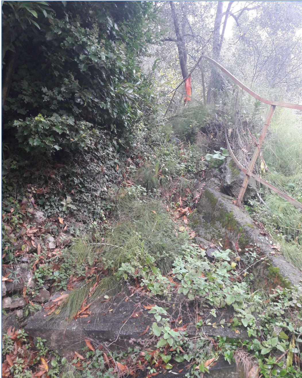
Foto 1 – Sito A- via Stallo di Bavari, mattonata pedonale disarticolata.
