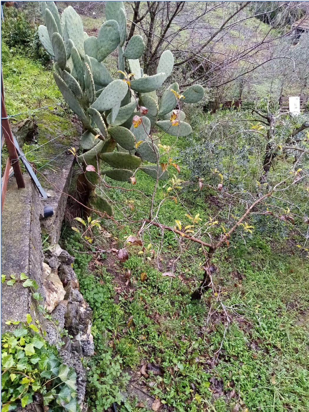
Foto 4 – Sito B – Via Induno – Cedimento e “spanciamento” del muro di contenimento
