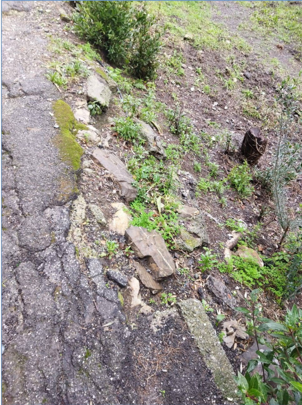
Foto 3 - Sito B - Via Induno- Sgrottamento del ciglio di valle
