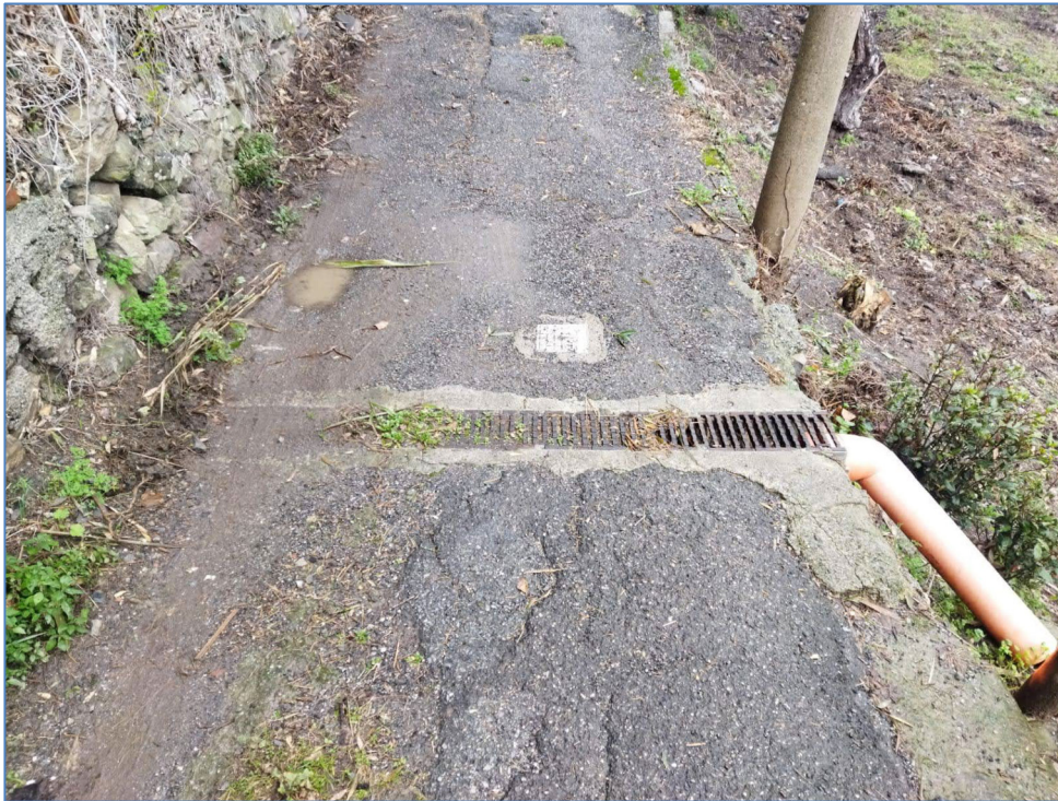
Foto 5 - Sito B - Via Induno - scarsa regimazione delle acque
