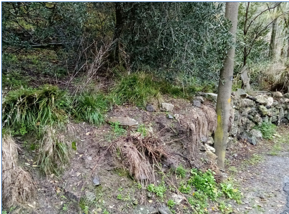
Foto 6 - Sito B - Via Induno - muri di sostegno in pietrame a secco crollati
