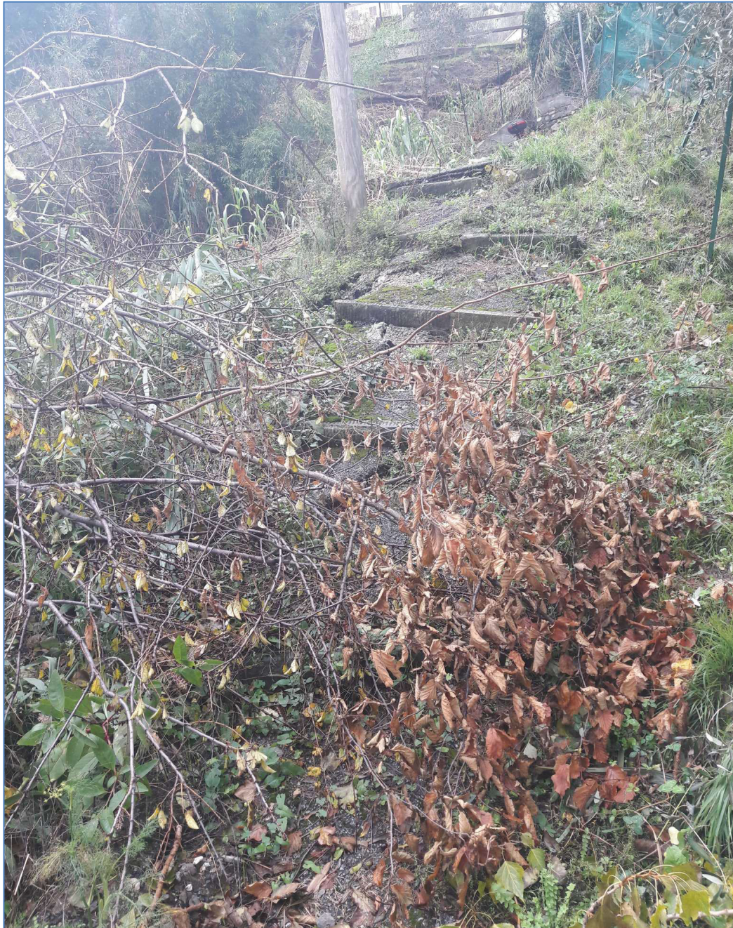
Foto 2 – Sito A – via Stallo di Bavari, mattonata disarticolata e impraticabile
