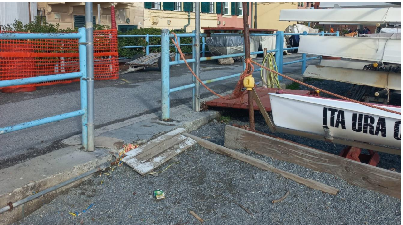
Accesso alla spiaggia attrezzata con rampa da ripristinare (pendenza 5%)
