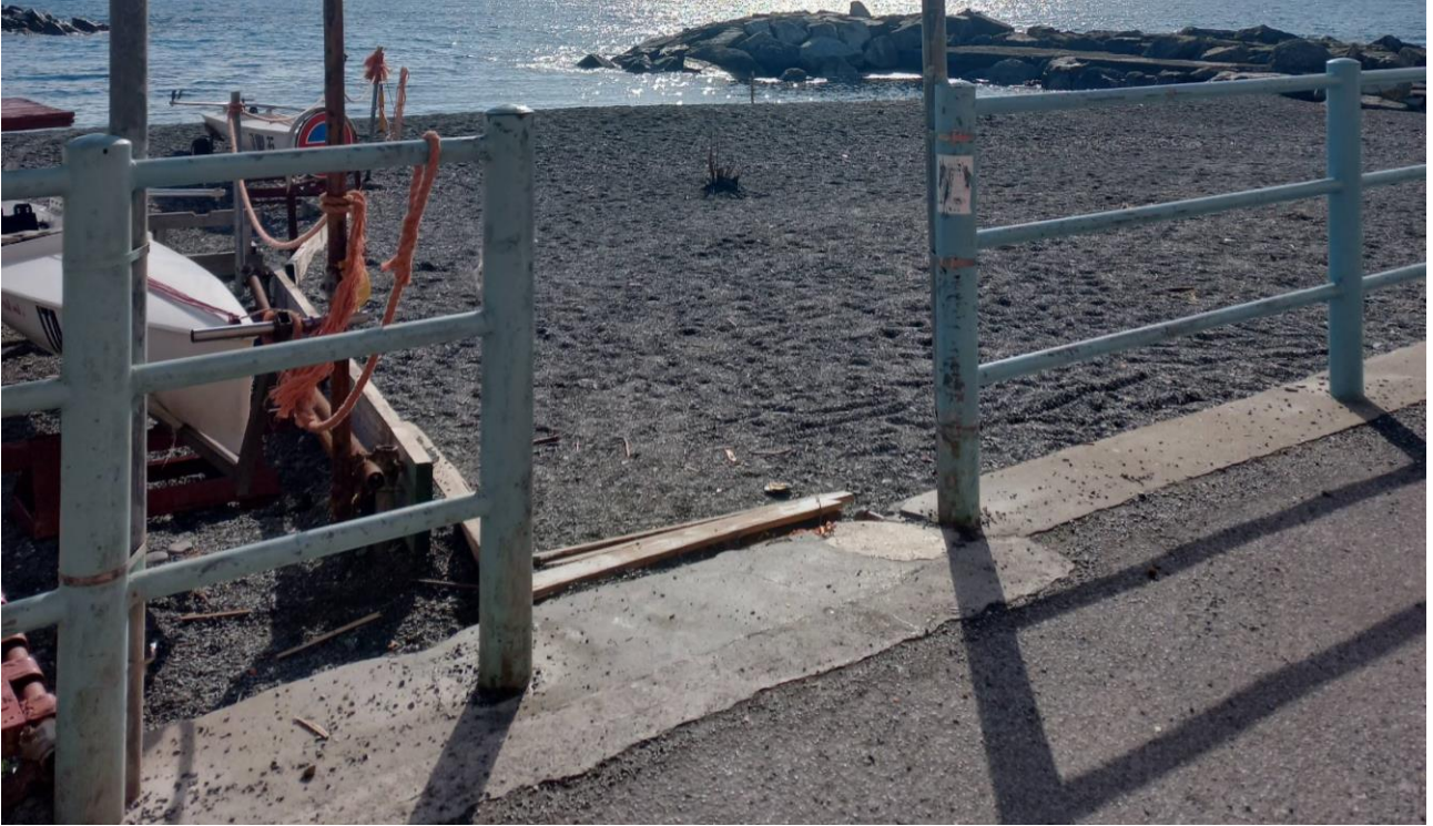
Accesso alla spiaggia attrezzata con rampa da ripristinare (pendenza 5%)
