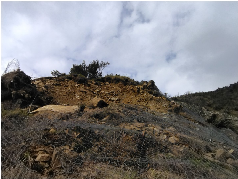
Figura 10: dettaglio zona di corona del distacco e porzioni di rete ancora in situ, da rimuovere
