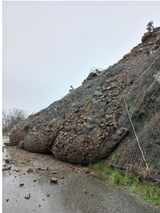
Figura 8: collasso della parete rocciosa con strappo della retatura ed ostruzione parziale della carreggiata di Via Sant'Alberto (vista verso sud)
