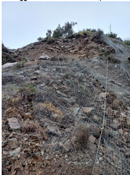
Figura 7: nicchia di distacco della frana in roccia alterata
