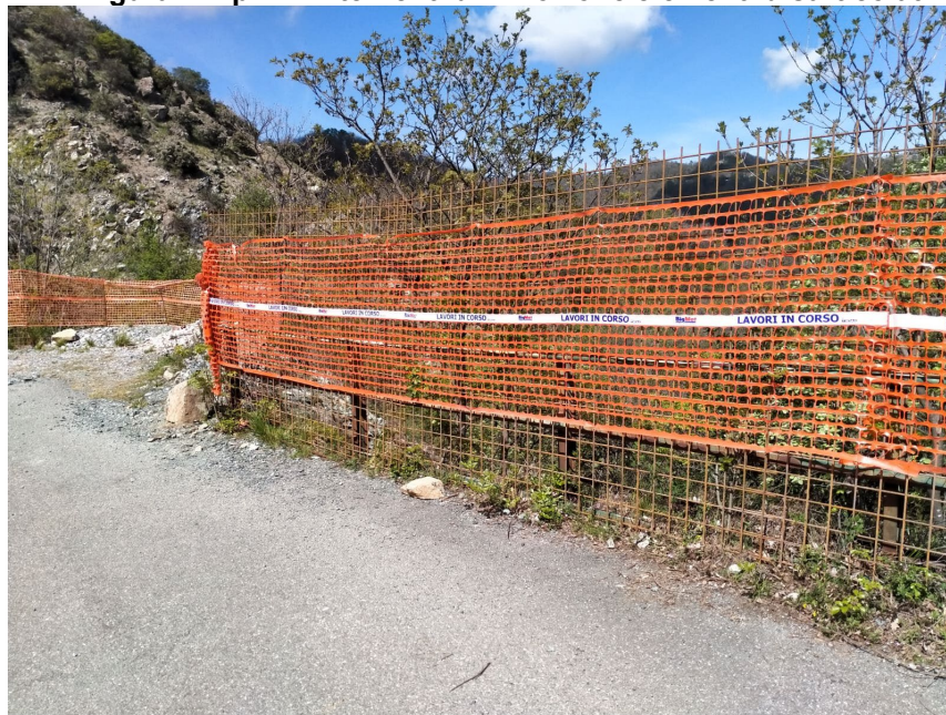
Figura 13: messa in protezione del parapetto di valle della via Rollino mediante pannelli di rete elettrosaldata abbinata a rete pvc ad alta visibilità
