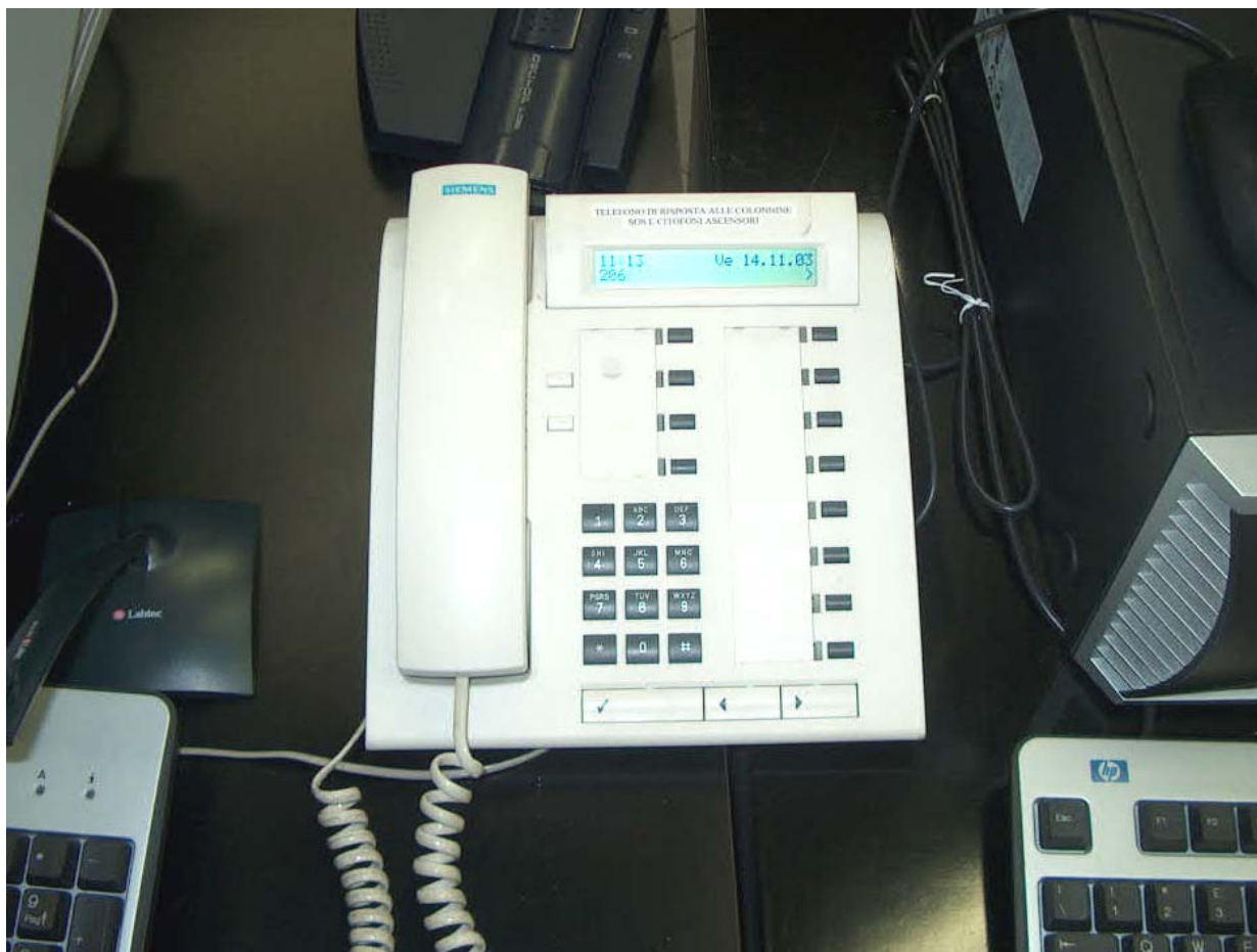
fig. 3 TELEFONO IN CONTATTO CON ASCENSORI E COLONNINE SOS
