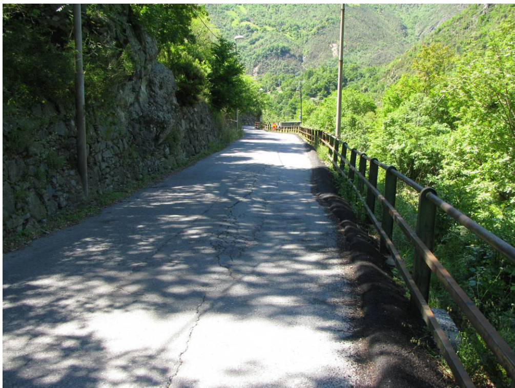
Foto 4 - Manto stradale fessurato
