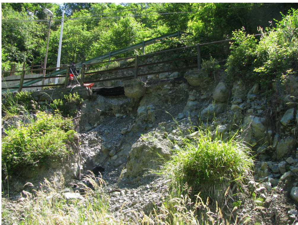
Foto 2 - Dilavamento della scarpata di valle
