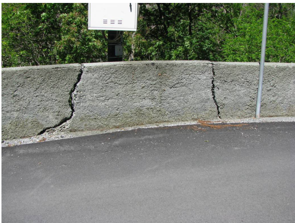
Foto 5 - lesioni sul muro di sostegno di via Fiorino
