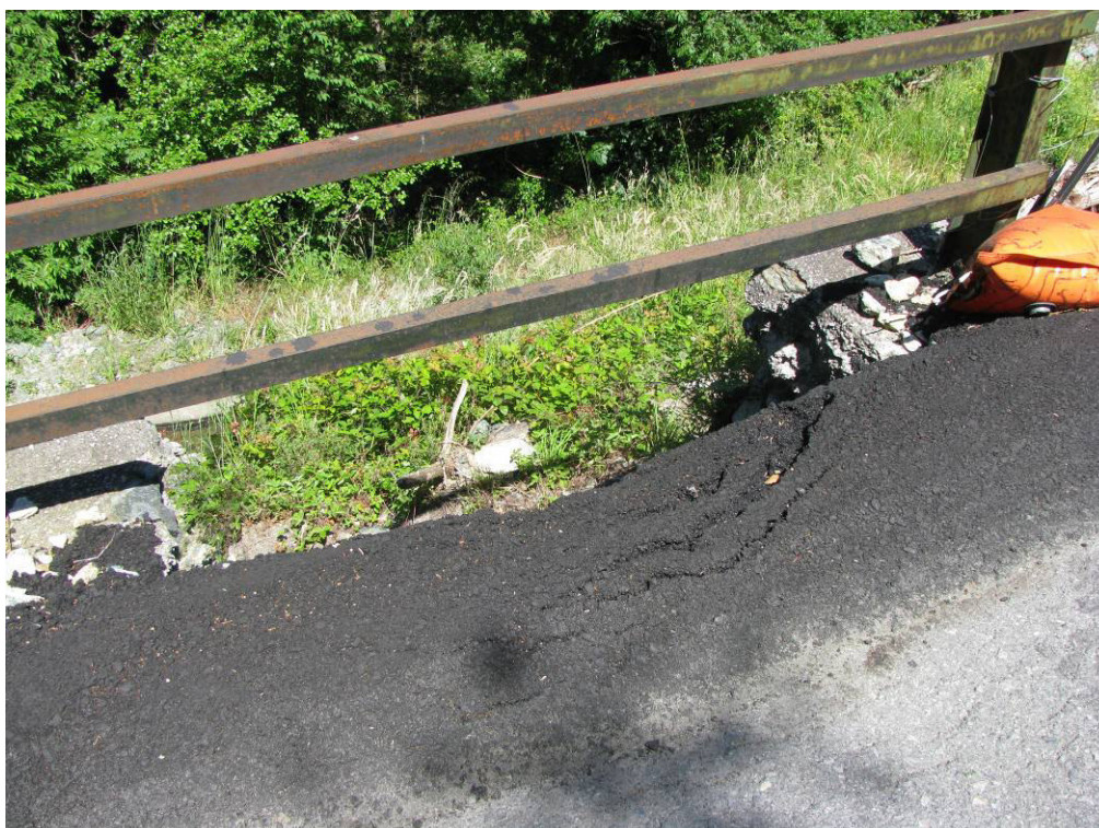
Foto 3 - Cedimento del manto stradale
