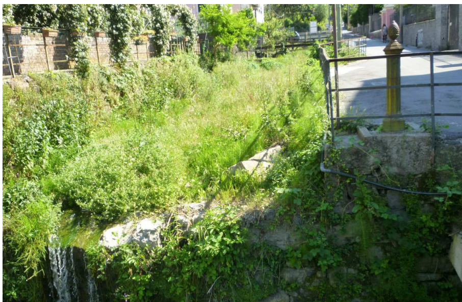
Fig 30- restringimento alveo in sponda sinistra
