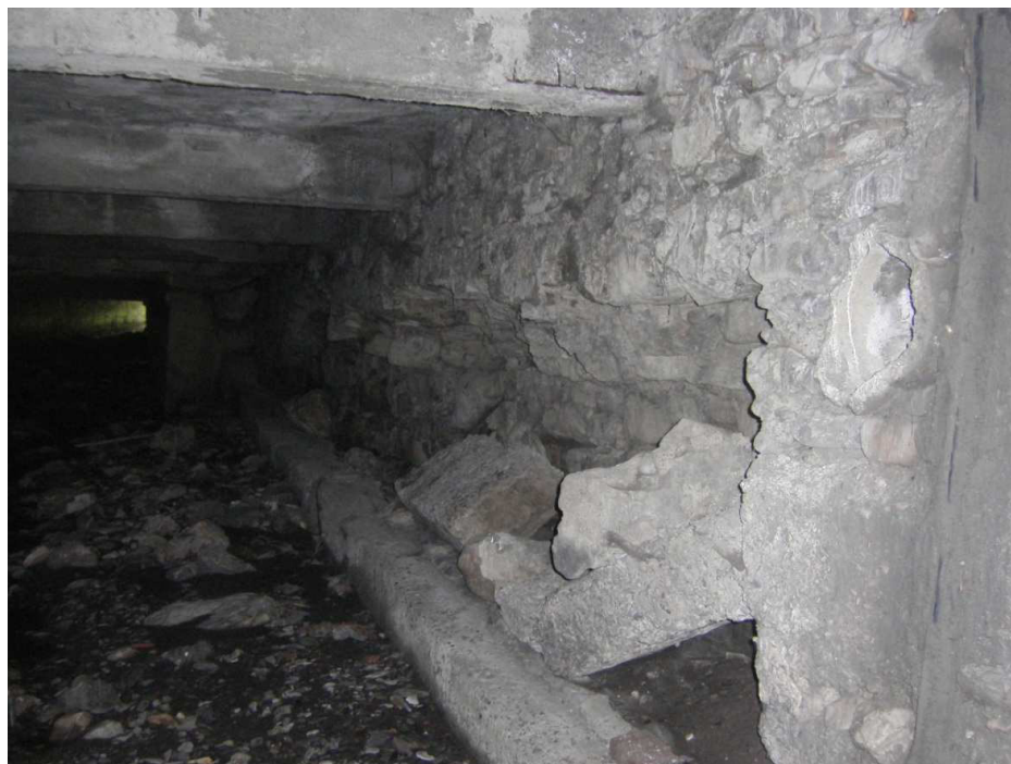
Fig 35- Cedimento della spalla in sponda sinistra
