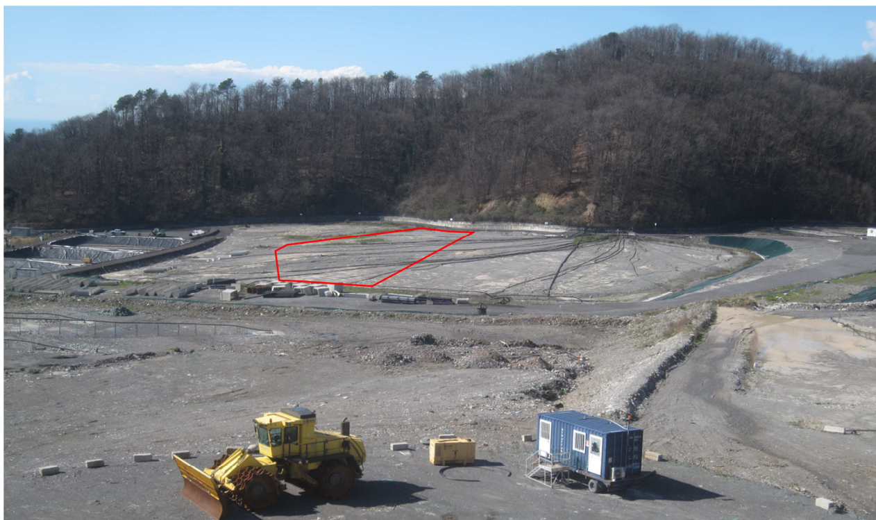
Fig. 1 – Panoramica dell'area in cui dovranno essere costruiti gli impianti di trattamento del percolato (linea rossa). Vista dalla sponda sinistra della discarica.
