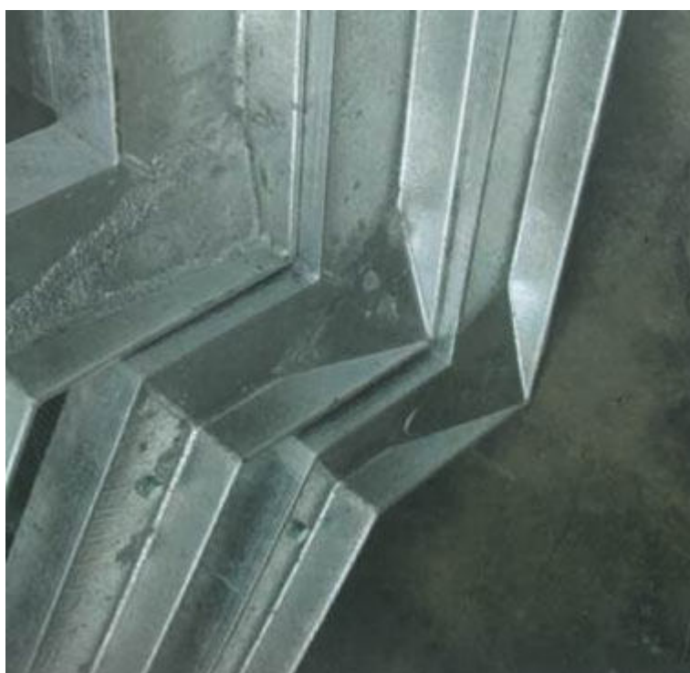
Accumulo di zinco dovuto ad assenza di foratura di drenaggio
