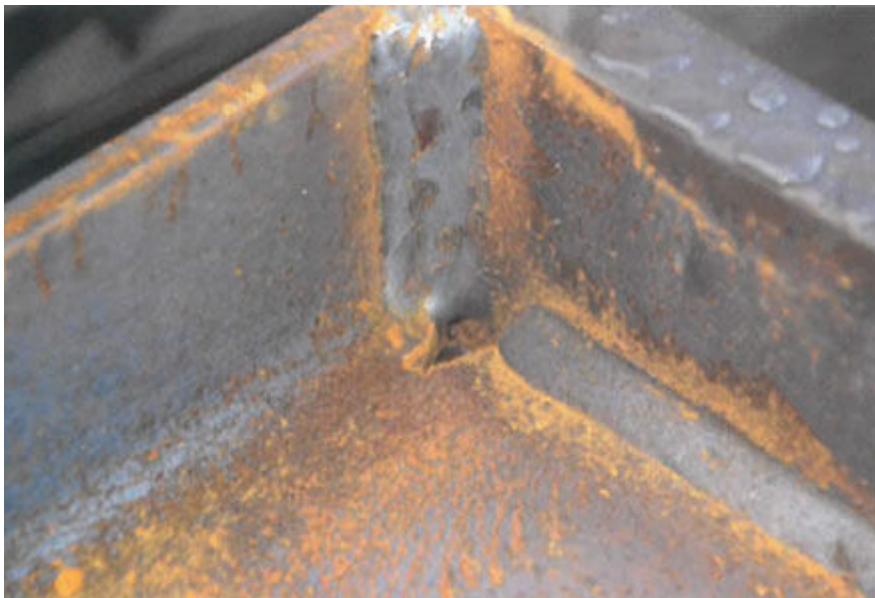
In questo caso la presenza del cordone di saldatura rende insufficiente la sezione del foro di drenaggio
