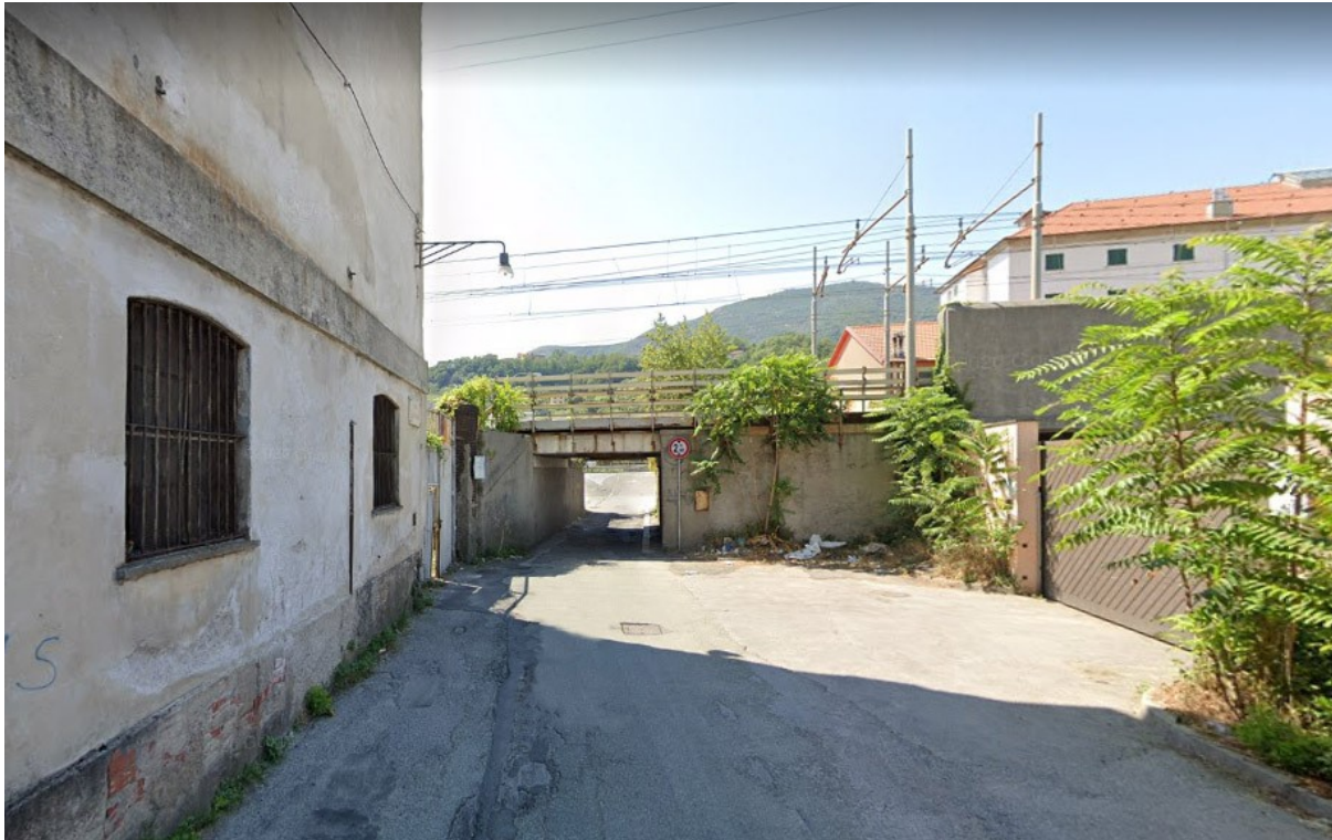
Imbocco del sottopasso ferroviario: la presenza di una struttura in putrelle di acciaio ne denuncia l'opera di allargamento e realizzazione effettuata in tempi recenti. Di fatto l'imbocco permette il transito di un solo veicolo per volta e si presenta completamente inadatto ad un traffico pesante.
