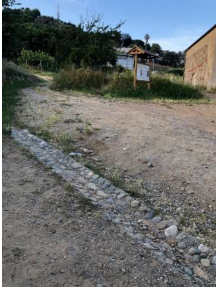
Canaletta longitudinale in pietra e cemento – Esempio di realizzazione in area vincolata presso la Chiesa di San Pietro in Carpignano, Quiliano (Savona)
