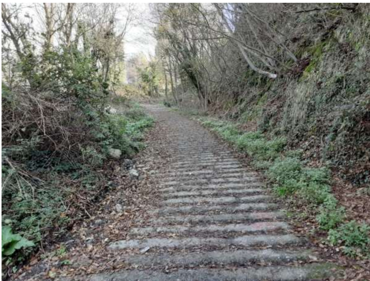
Figura 37: tratto cementato a forte pendenza che verrà sistemato con interventi di manutenzione e ripristino.
