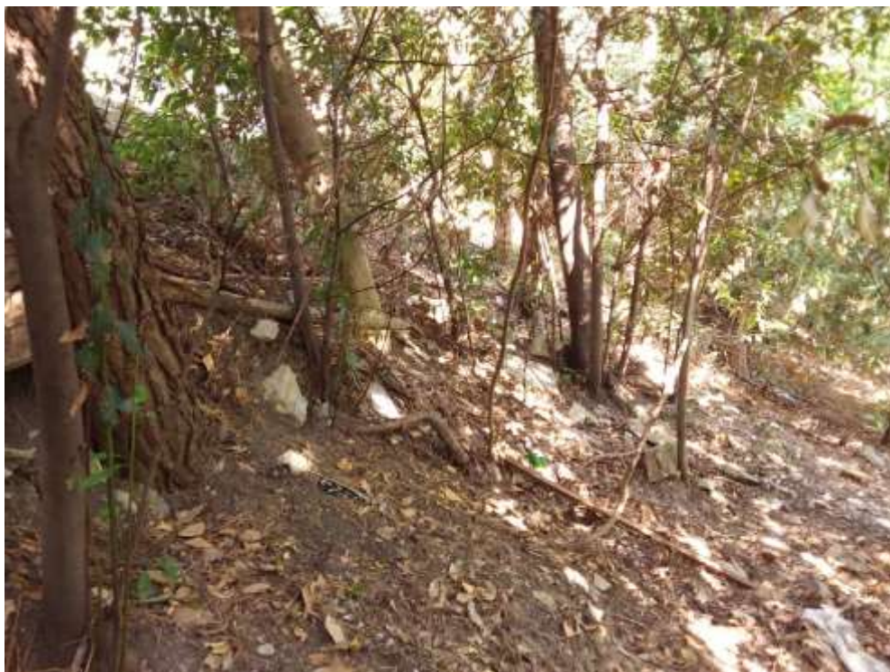
Figura 83: la scarpata a valle del campo da calcio in stato di erosione ed instabilità
