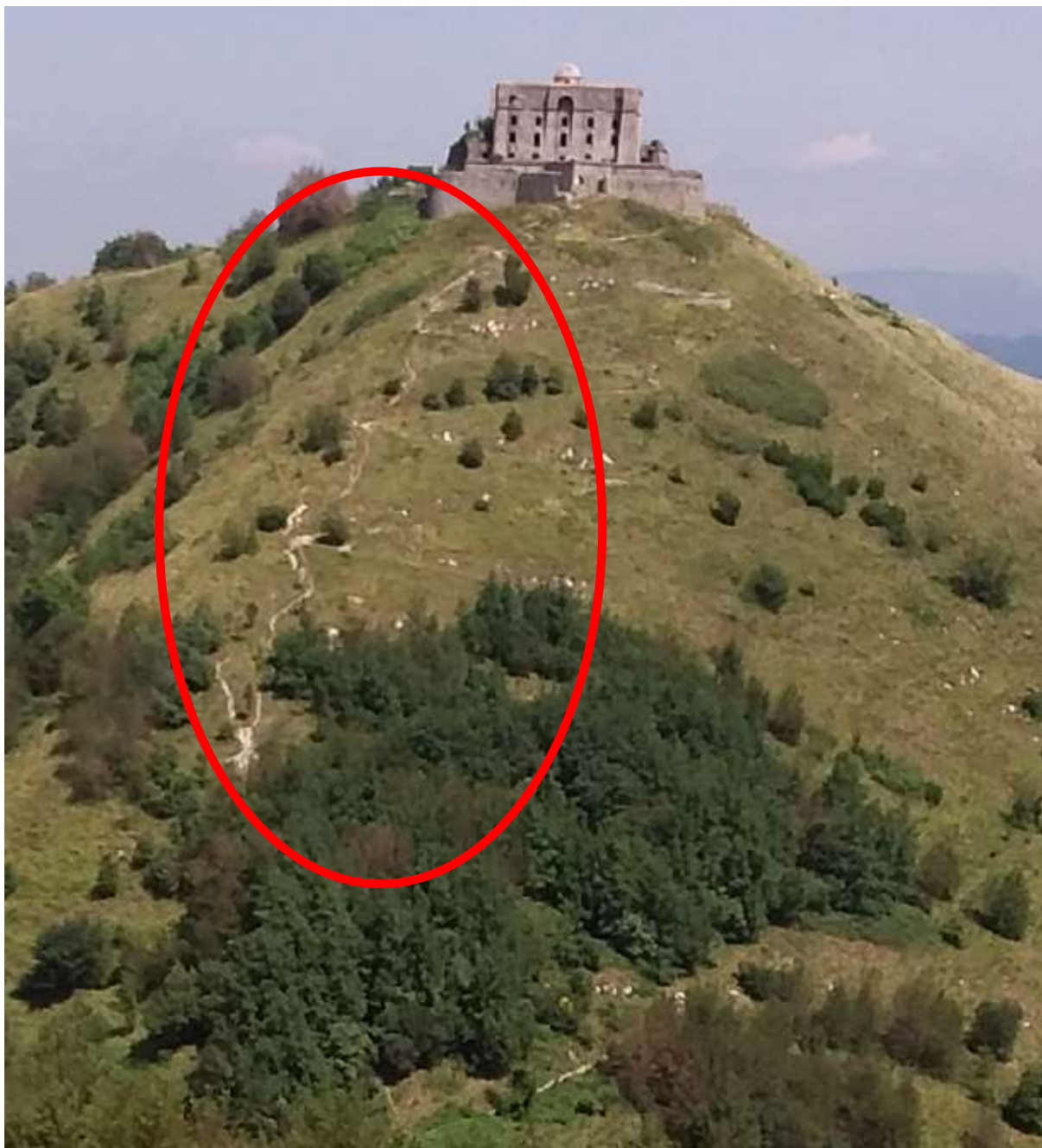
Figura 97: solchi di erosione concentrata dovuti alla mancata regimazione delle acque superficiali
