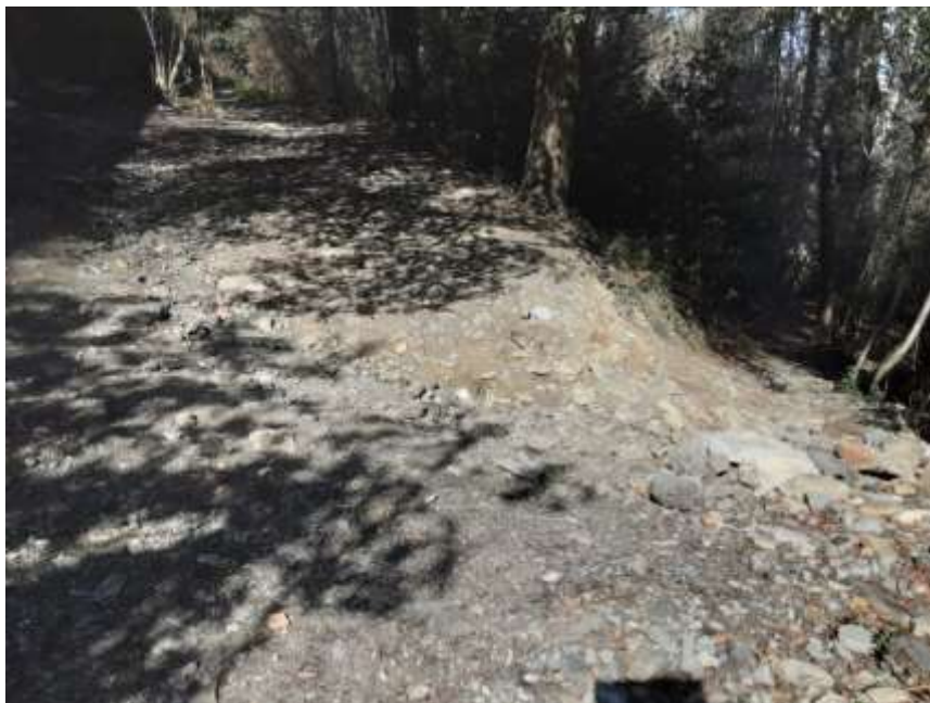
Figura 70: percorso dissestato a causa della mancata regimazione delle acque superficiali in un tratto dell'area periurbana
