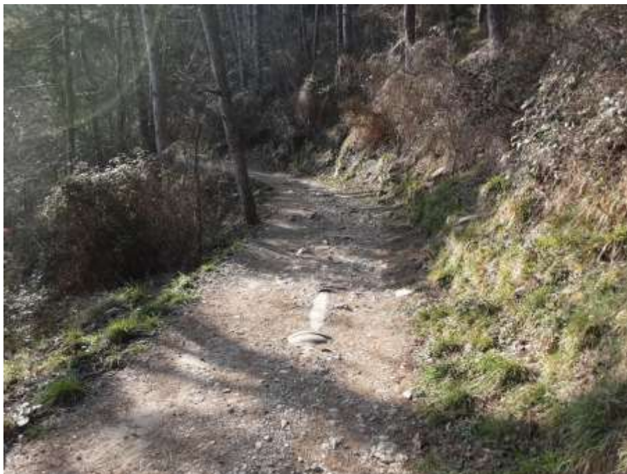
Foto45: tratto della tubazione dell'acquedotto affiorante a causa dell'asportazione del terreno da parte delle acque di ruscellamento superficiale
