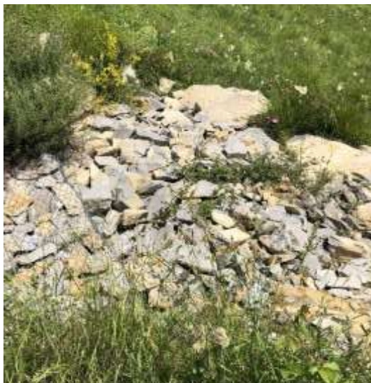
Figura 92: la regimazione delle acque di versante viene completata dalla messa in opera, alla base dei gabbioni, di pietre cementate che disperdono le acque nel suolo naturale senza creare erosioni diffuse e/o concentrate.
