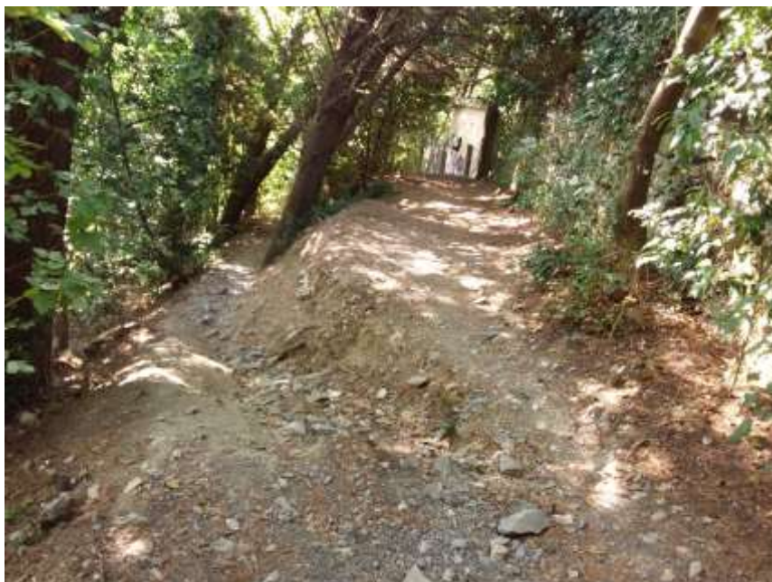
Figura 82: la foto mostra il sentiero adiacente al campo da calcio visto da monte verso valle. Si nota come la coltre superficiale sia irregolare e solcata da fenomeni erosivi dovuti alla mancata regimazione delle acque superficiali
