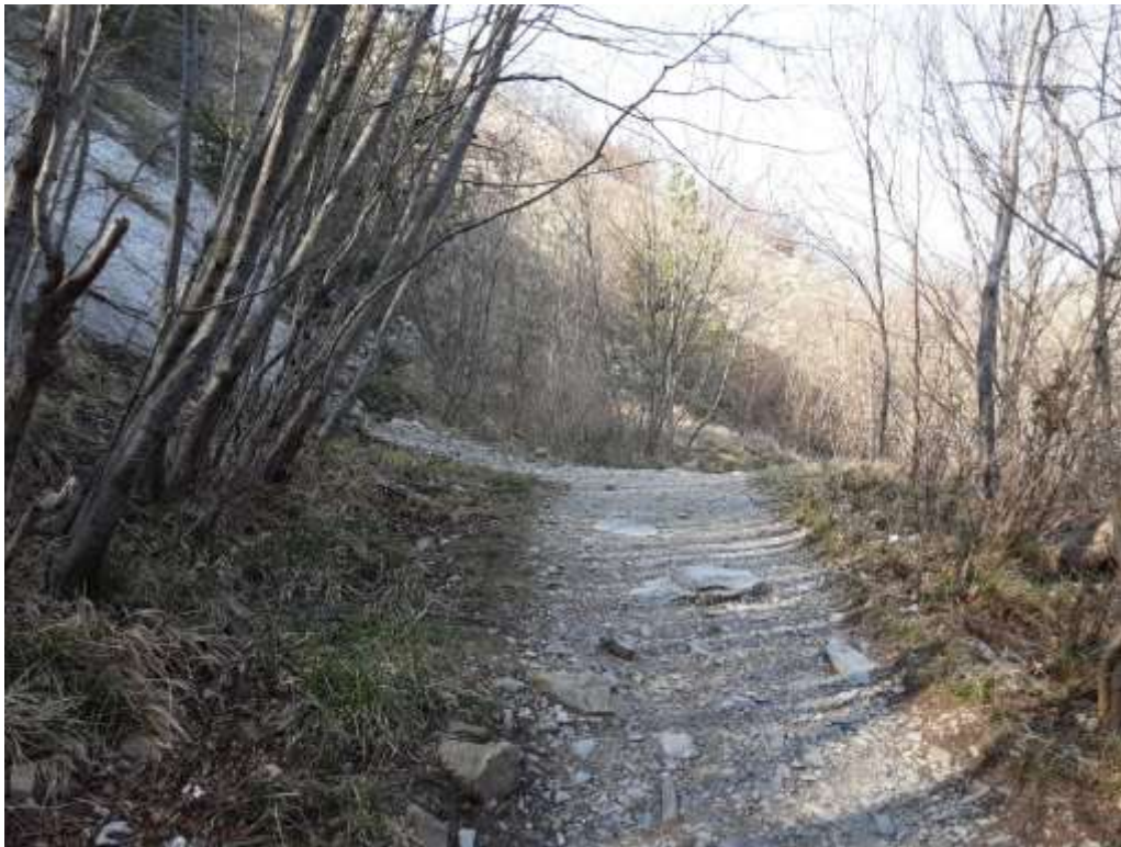
Figura 15: roccia a franapoggio con rilascio di elementi lapidei sul sentiero
