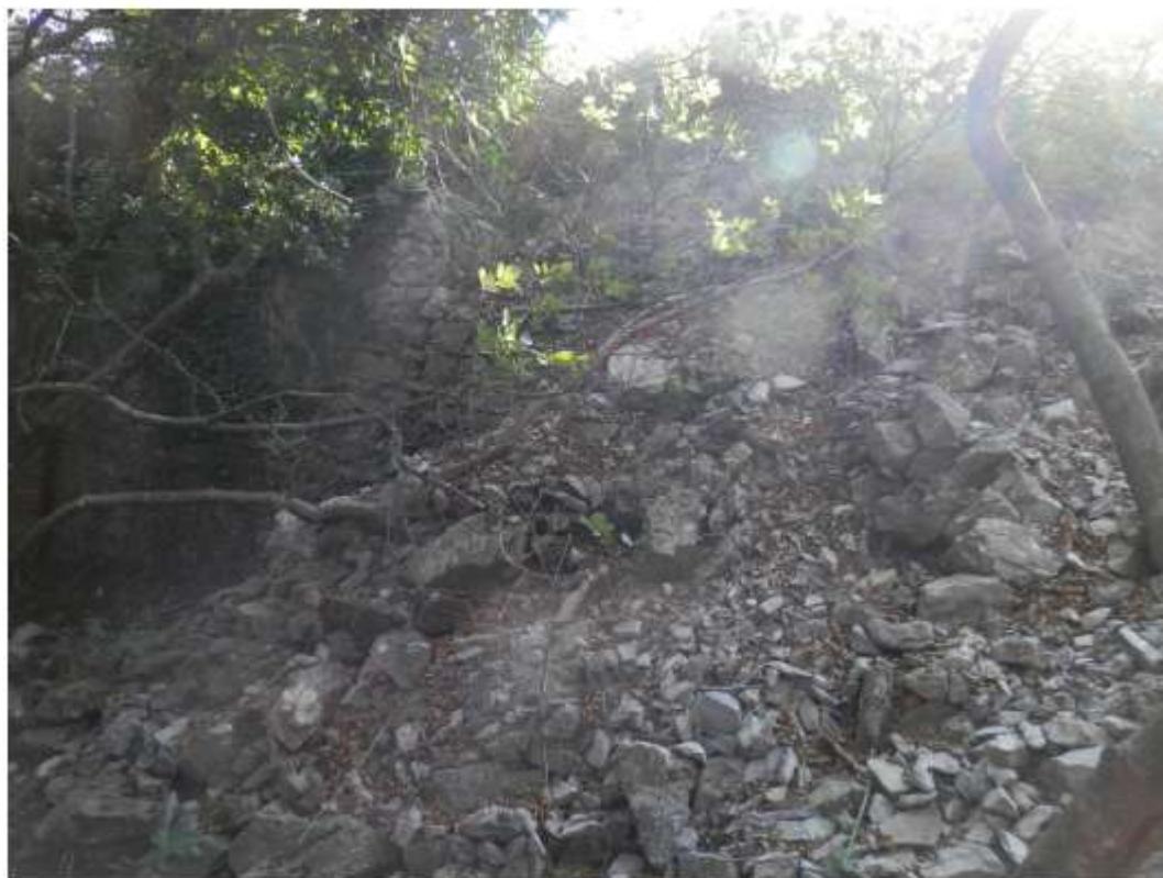
Vista della porzione del muro crollato che necessita di paratia di consolidamento a tergo
