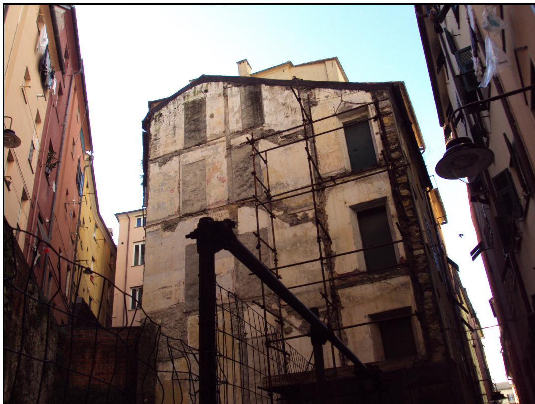
2 e 3. Vista della porzione rimasta dell'edificio di Vico Coccagna 3
