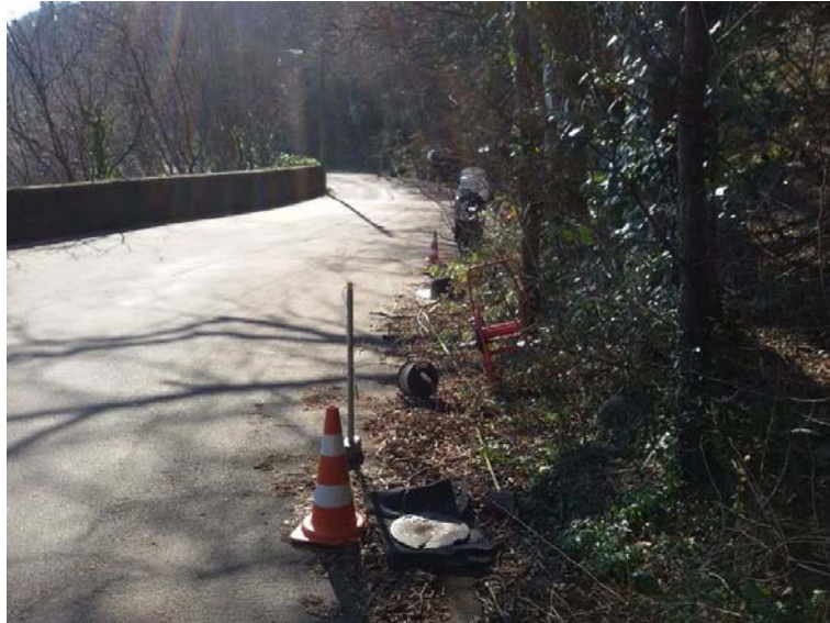
Stendimento sismico tomografico SS1, estremo finale (piastra in offset lato geofono G24)
