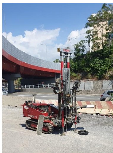
DPSH02 - SSE 4 Cornigliano
