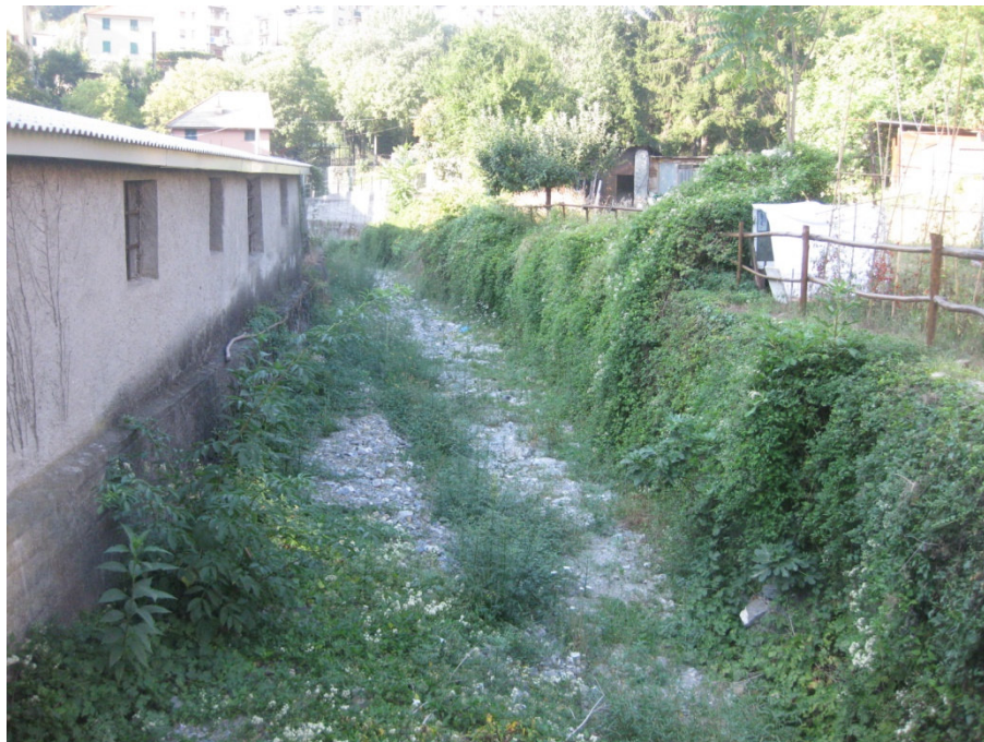
Foto 1 – Foto scattata in corrispondenza della sezione 31 verso valle ad inquadrare il tratto di rio Fegino di monte ove sono tracciate le sezioni 30 e 29; si osserva il già citato fabbricato presenta sull'argine sinistro.
