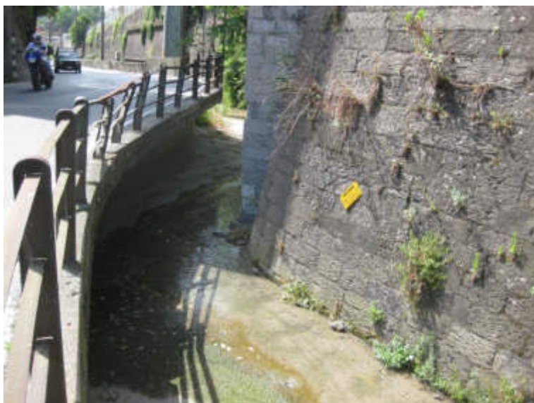
Foto 7 – Foto scattata in corrispondenza della sezione 10 verso valle; si osserva lo sbalzo della strada e il fondo plateato del rio.
