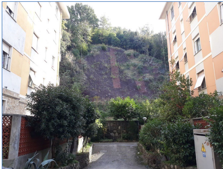
Figura 10.7 Dissesto con intervento di messa in sicurezza in Via Fasciotti a nord dello sbocco della galleria idraulica
