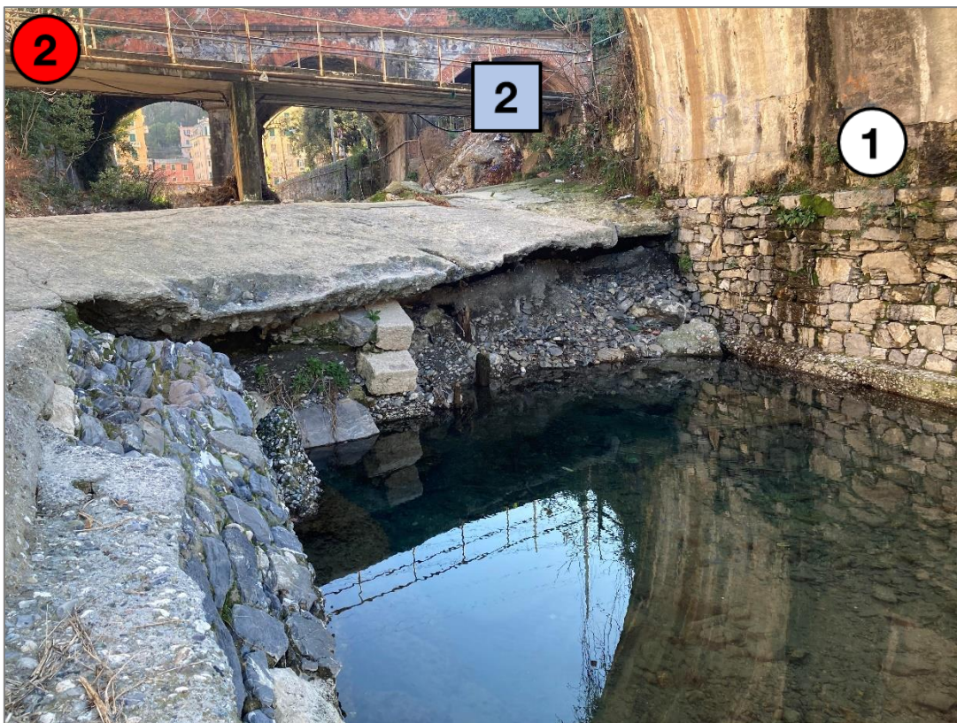
Figura 4-5: Salto del fondo in prossimità della confluenza del Torbella nel Polcevera. Sullo sfondo la passerella carrabile. In primo piano a destra la spalla del ponte della Linea Succursale dei Giovi
