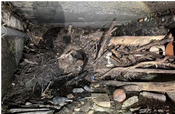
Figura 1-6: Ostruzione della tombinatura al di sotto di via Canepari, vista da monte
