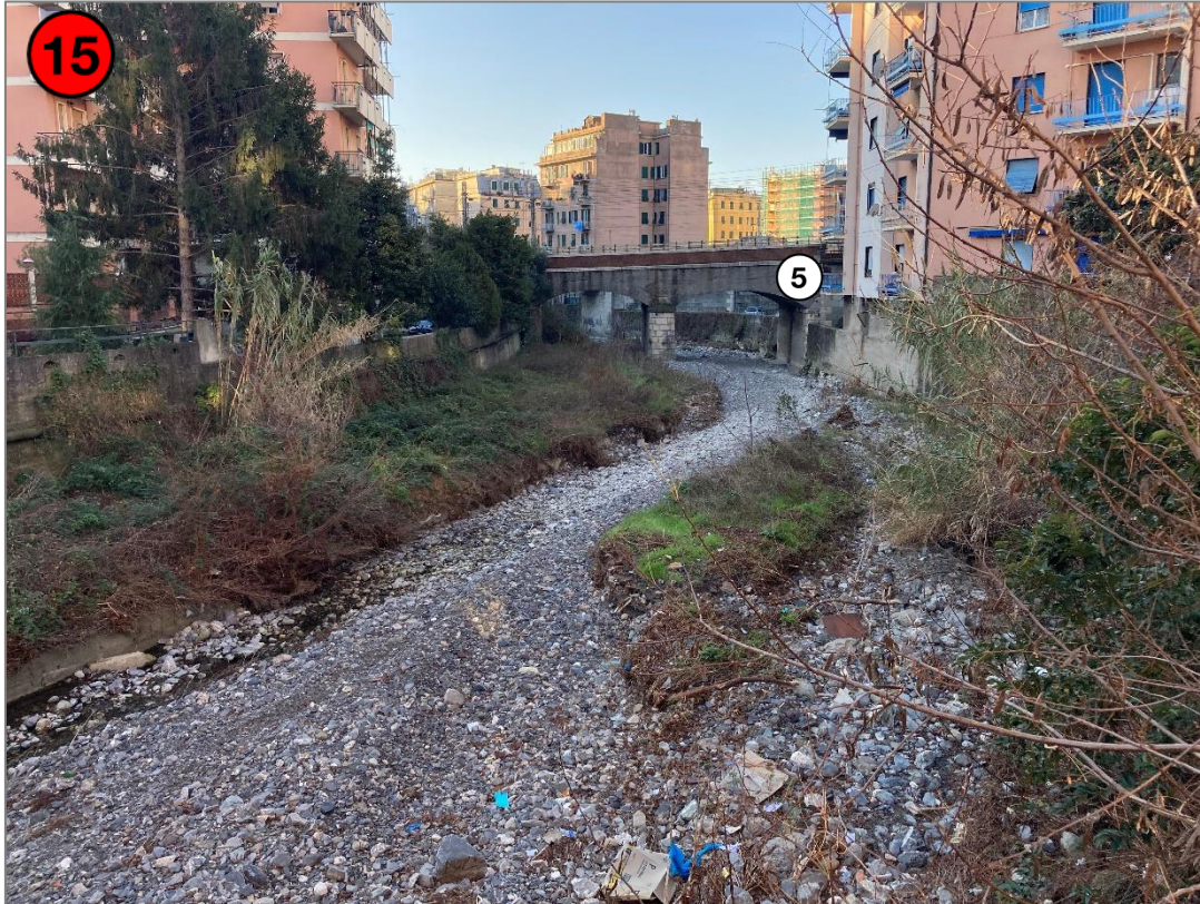
Figura 4-18: Vista del t. Torbella dal ponte stradale di via Fasciotti verso valle. Sullo sfondo il ponte ferroviario della linea dei Giovi
