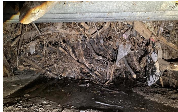
Figura 1-7: Ostruzione della tombinatura al di sotto di via Canepari, vista da valle
