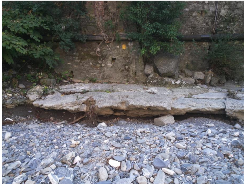
Figura 32- Residui della gettata di calcestruzzo a protezione dell'argine.
