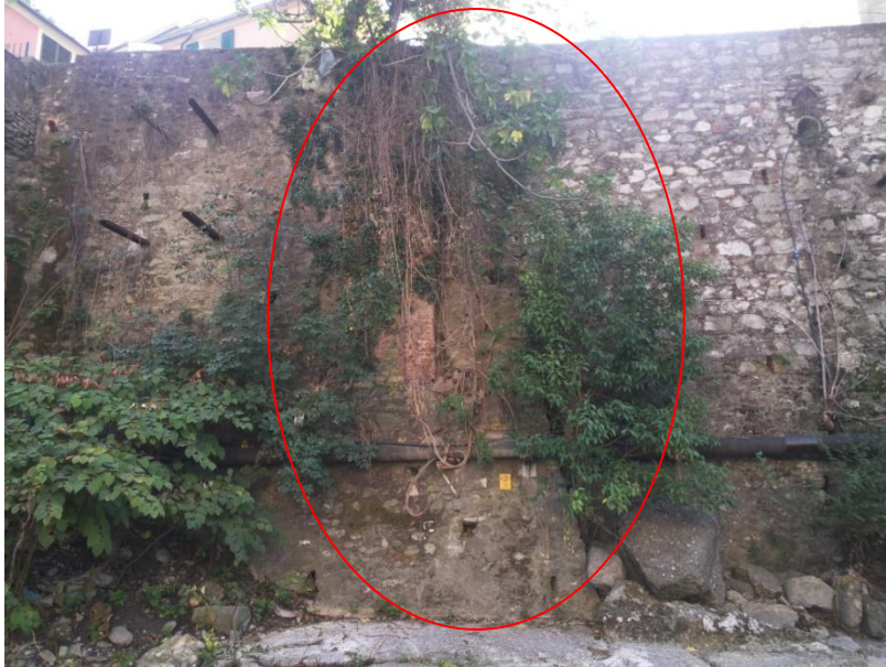
Figura 33- Il muro di contenimento su cui sembra sia stata costruita la rampa di Passo Torbella.
