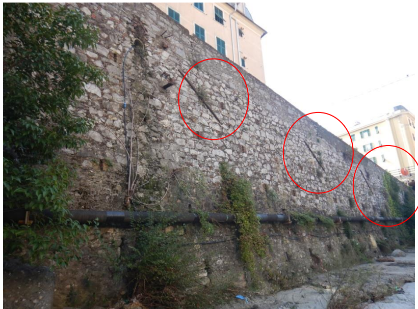
Figura 31- Argine sinistro del torrente su cui è stata edificata la rampa per raggiungere Palazzo Fieschi. Cerchiate in rosso le chiavi a bolzone.
